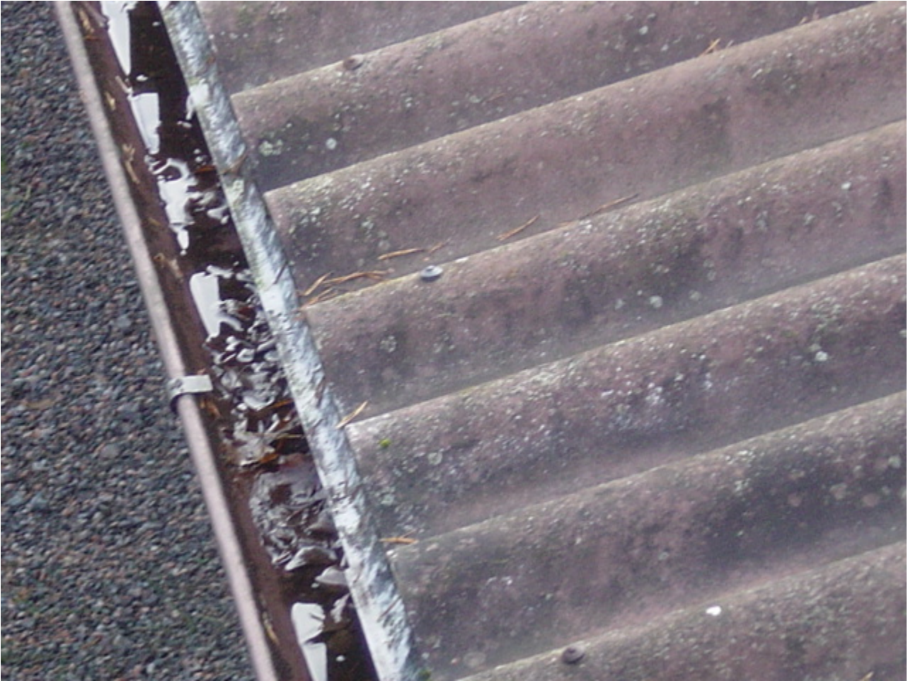
Kuva 3: Rästaskouruissa on lehtiä.
