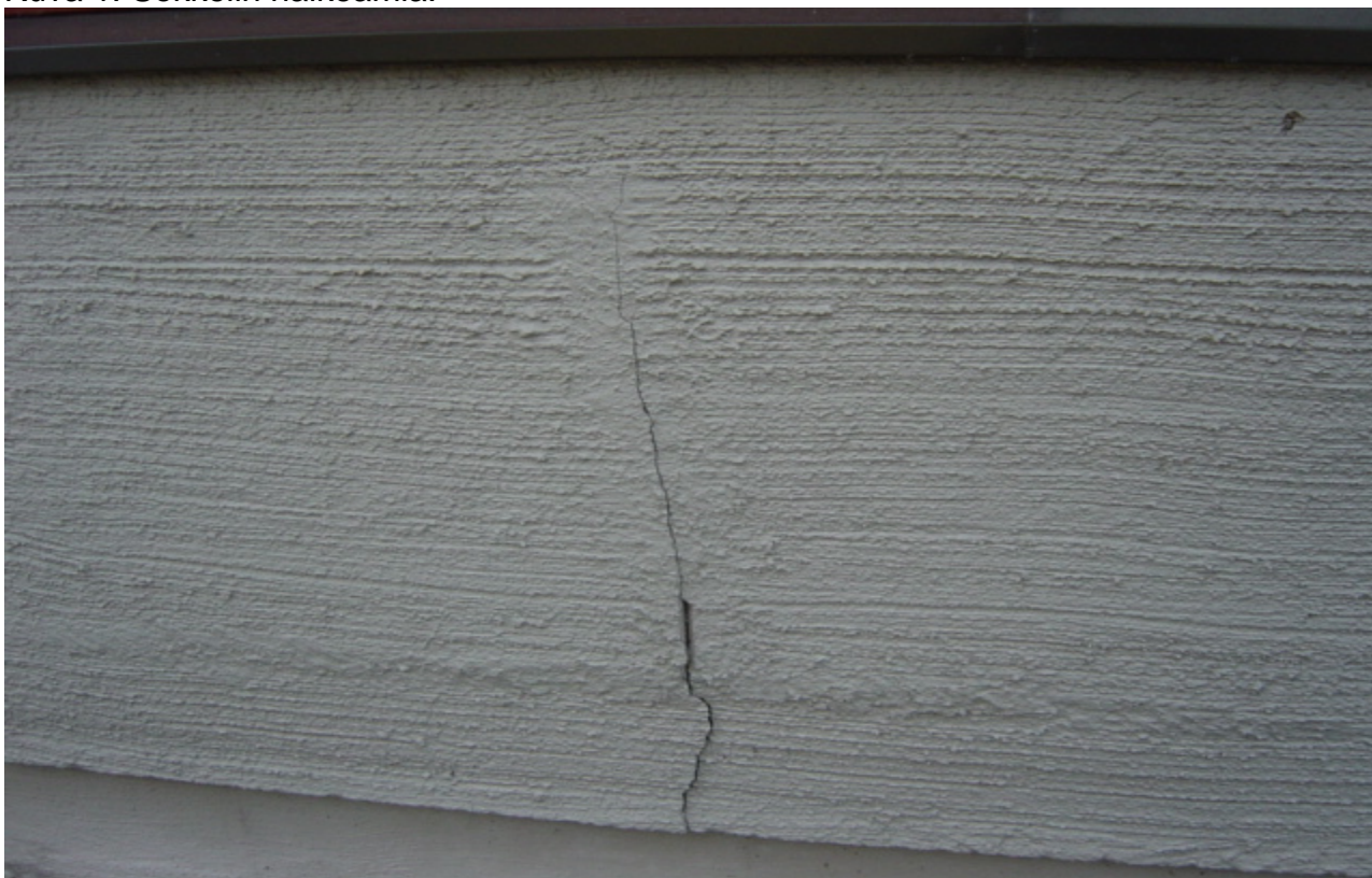
Kuva 2. Rapatun julkisivuosan halkeama.
