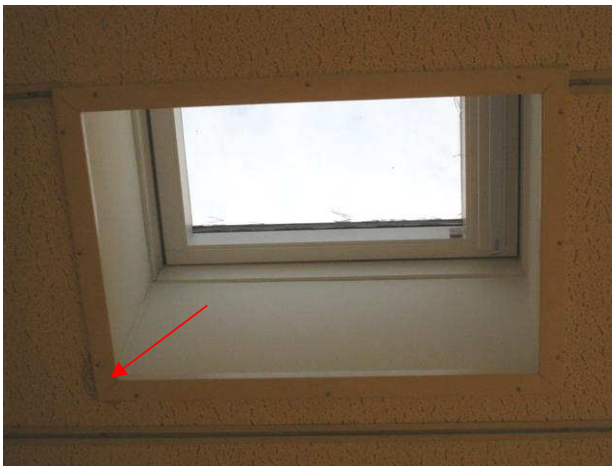
Kuva 15 Monitoimihallin kattoikkunan kulmassa on vesivuotojälkiä.
