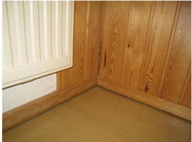
Kuva 46 Lattia on painunut n. 5 mm tilassa 31.
