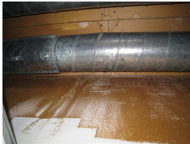
Kuva 27 Käytävän 34 katon vuotojälkien kohdalla vuotojälkiä alakattotilan väliseinässä ja yläkaton levypinnassa.
