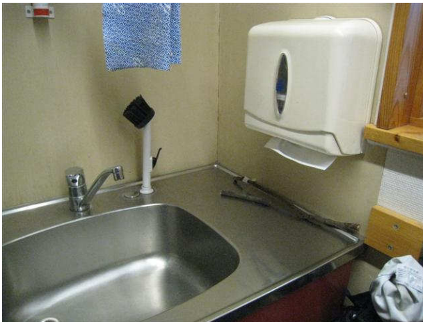
Kuva 39 Tk-märkäeteisen 19 nurkassa on seinätapetissa rako, josta vesi pääsee.
