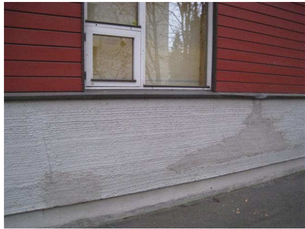
Kuva 8 Korjattuja ulkoseinämuurauksia. Tuuletusikkunoiden käyntivälit tarkistettava. Vesipellissä lommoja, kallistus puuttuu
