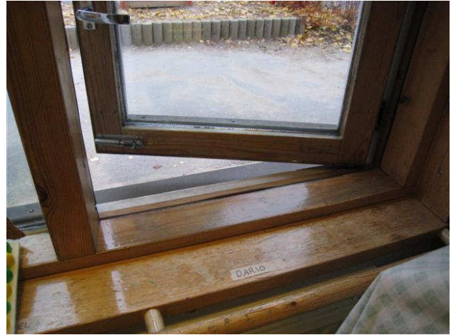
Kuva 14 Tuuletusikkunoiden kohdalla on vesijälkiä, lienevät kastuneet sadesäällä.
