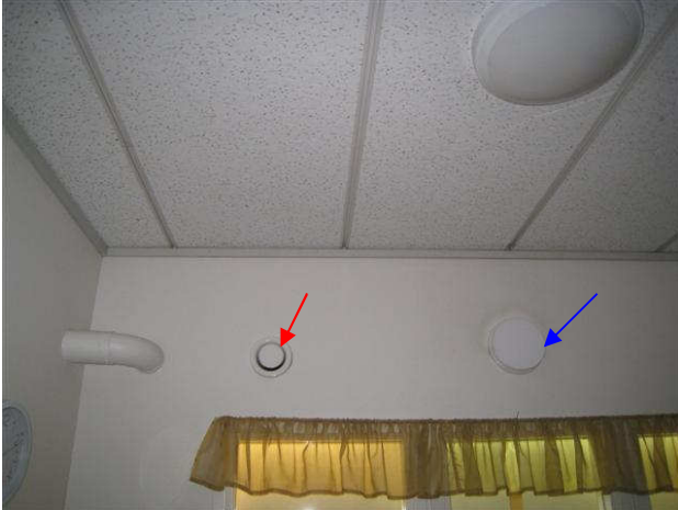
Kuva 43 Tulo- ja poistoventtiilit.
