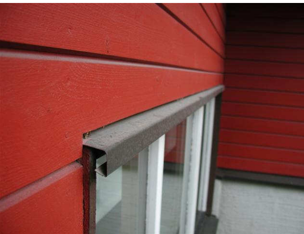
Kuva 11 Ikkunan yläpielen vesipelti on lyhyt, ilmareitti tuuletusväliin puuttuu.
