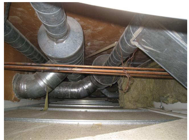
Kuva 28 Alakattotilan IV-kanavia, eristämättömiä käyttövesiputkia ja eristevillaa.
