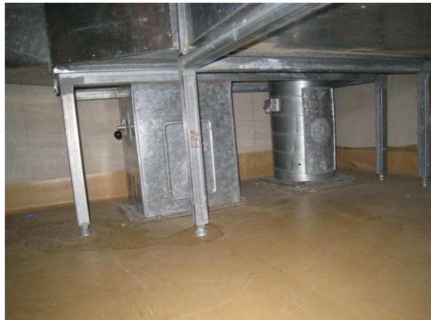
Kuva 42 IV-kojeiden alla olevia vanhoja vuotojälkiä.
