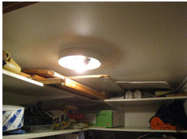
Kuva 44 Varastotilan poistoventtiili lienee jossain tavaroiden takana.
