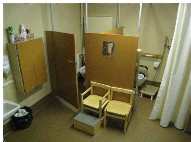
Kuva 30 Yleiskuva psh-wc-tilaan, jossa on alkuperäinen muovimatto lattiassa ja seinissä muovitapetti.
