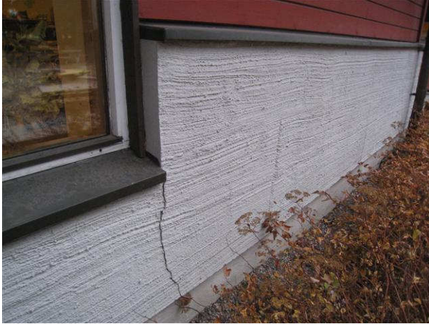
Kuva 7 Ylöspäin levenevä halkeama ulkoseinän kiviverhouksessa.
