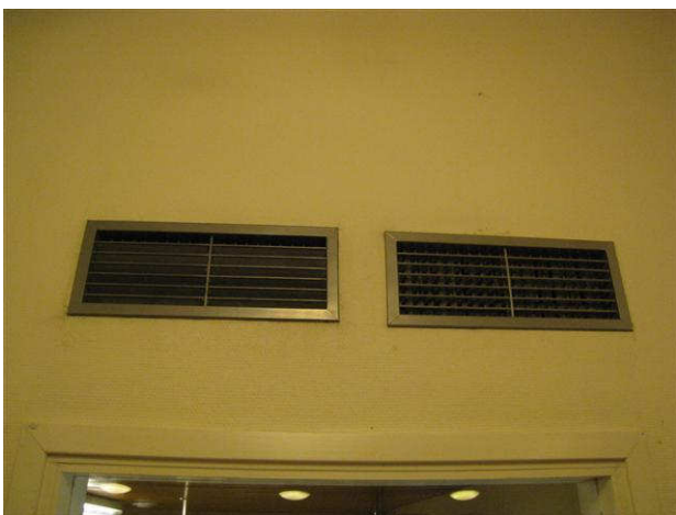
Kuva 47 Tulo- ja poistoventtiili
