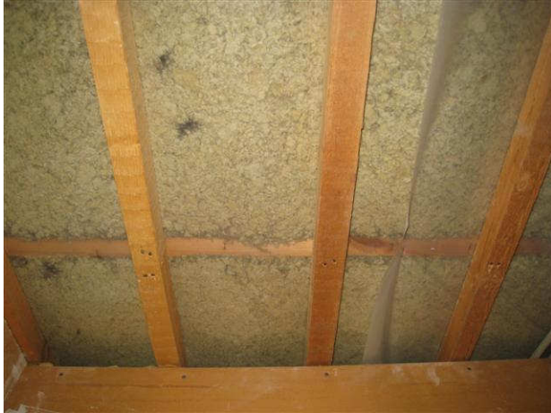
Kuva 25 Alakattotilassa oleva tiivistämätön höyrysulun limitys.
