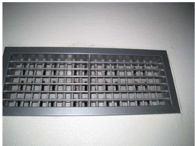
Kuva 48 Poistoventtiili on likainen.
