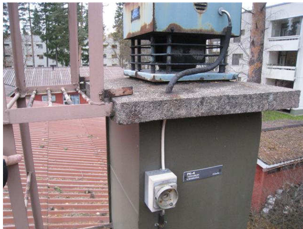
Kuva 21 Takan piippu ja tikkaat, turvakytkin on rikki.
