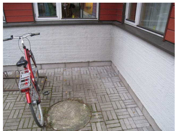
Kuva 4 Tarkastuskaivo huoltopihalla tilan 51 vierellä. Betonikiveykset ovat kuluneet.
