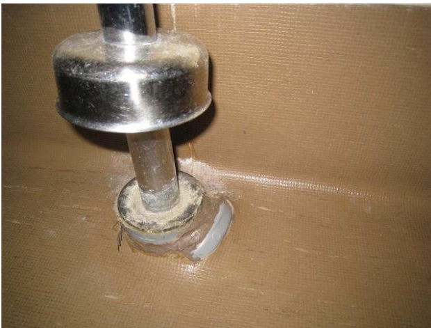
Kuva 33 Lavuaarin vesilukon liittymä, jota on tiivistetty kittamalla.
