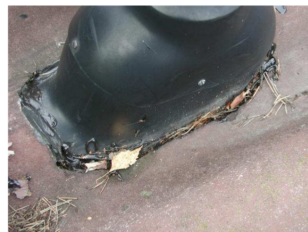
Kuva 23 Epätiivis tuuletusviemärin liittymä.
