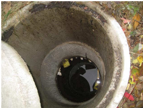
Kuva 3 Salaojan tarkastuskaivo tilan 14 kullalla. Vesipintaan maanpinnasta n. 1.2 metriä
