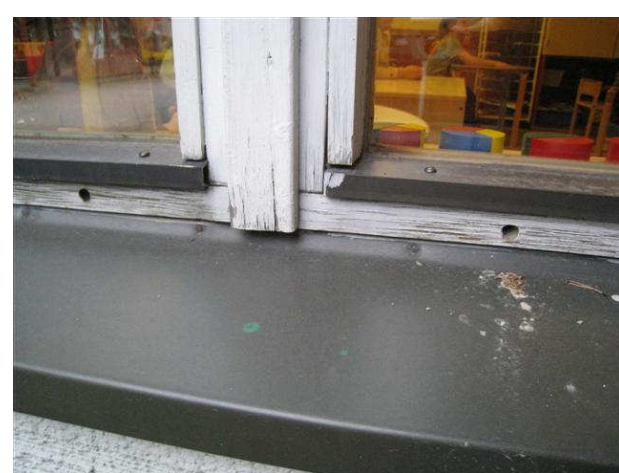
Kuva 12 Kuluneita maalipintoja, vesipellin liittymä ei ole tiivis.
