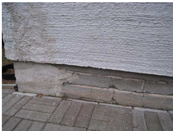
Kuva 5 Vaurioitunut sokkelipinta keittiön 45 kohdalla, korjausjälkiä sokkelissa ja seinässä.
