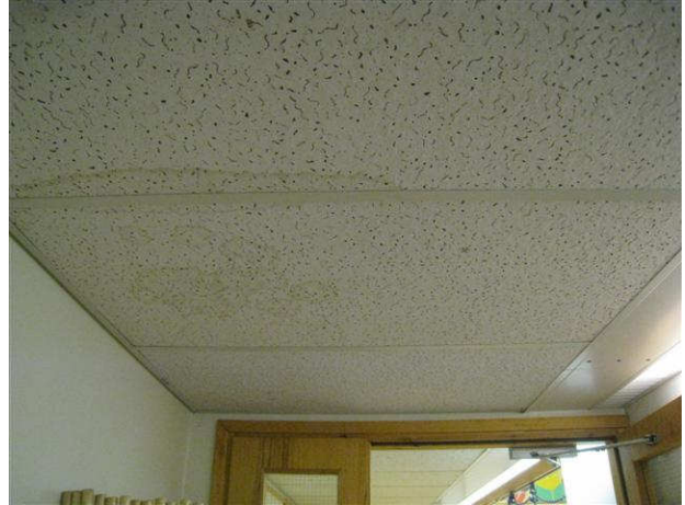
Kuva 26 Vuotojälkiä käytävän 34 akustiikkalevyissä.
