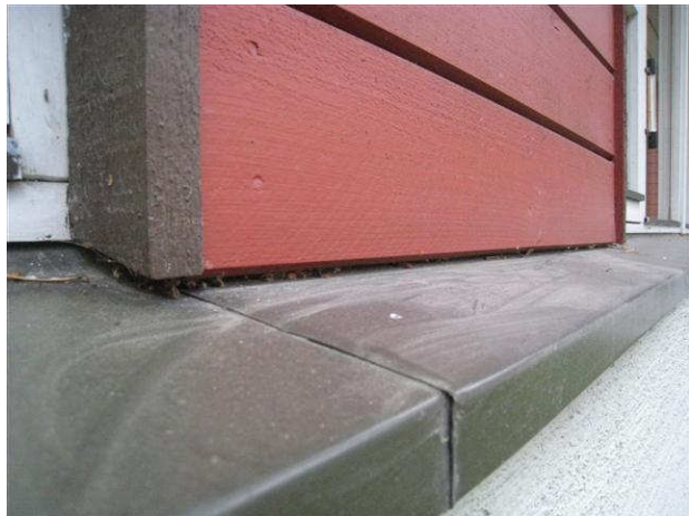
Kuva 10 Ulkoseinämuurauksen ja puuverhouksen väliset vesipellit ovat hyvin loivat. Puu on vasten vesipeltiä ja ilmareitti puuttuu.
