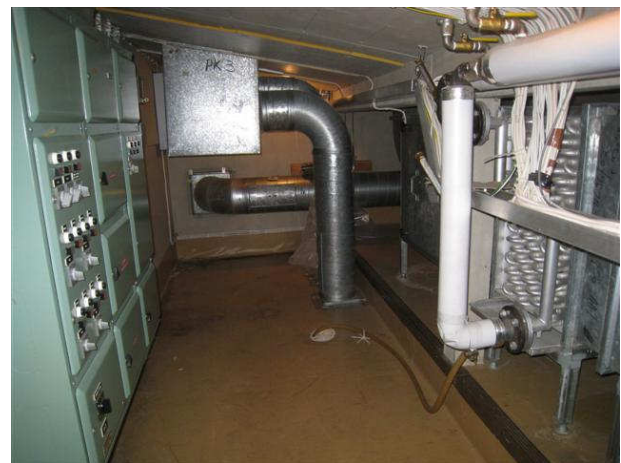
Kuva 40 Yleiskuva ullakon IV-konehuoneesta, jossa on lattiakaivo.
