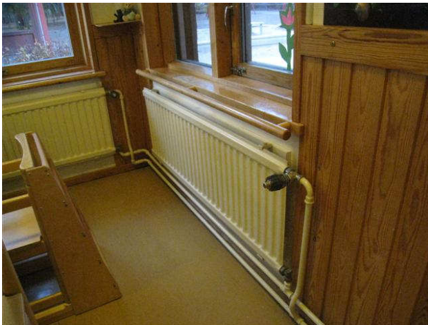
Kuva 45 Levypatterit ja termostaatit ovat alkuperäisiä.
