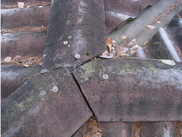
Kuva 19 Epätiivis harjan jiiritaite, jiiripelti on vanha.
