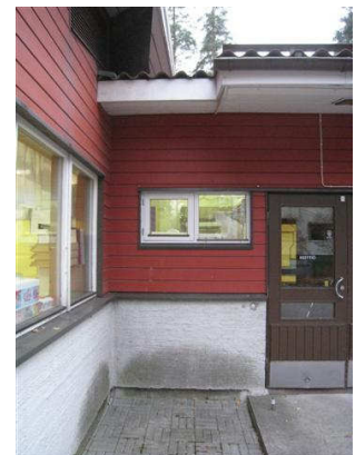
Kuva 6 Kattovesi kastelee sokkeliä ja seinää, koska ränniä ei ole keittiön kulmalla.
