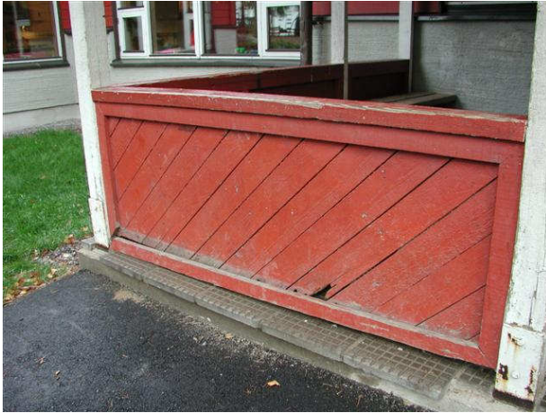
Kuva 13 Alaosaltaan lahonnut ja muutenkin huonokuntoinen kuistin kaide.
