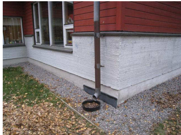
Kuva 2 Rännivedet on johdettu kaivoihin ja viemäroity. Sokkelivierellä on sepeli, mutta sokkelin kosteussuojaa ei havaittu.
