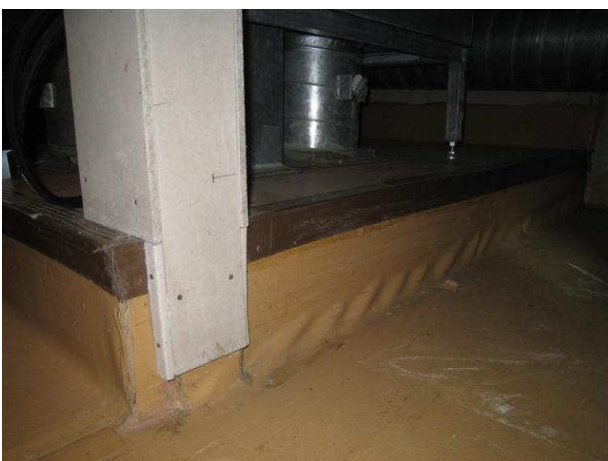
Kuva 41 IV-konehuoneen juurinoistoissa on vuotoriskikohtia saumoissa.
