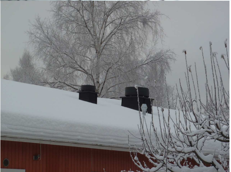
Kuva 6. Lisärakennuksen vesikatolla on keittiötä ja muita tiloja palvelevat huippuimurit. Huippuimurit ovat alkuperäisiä Fläktin valmistamia puhaltimia.
