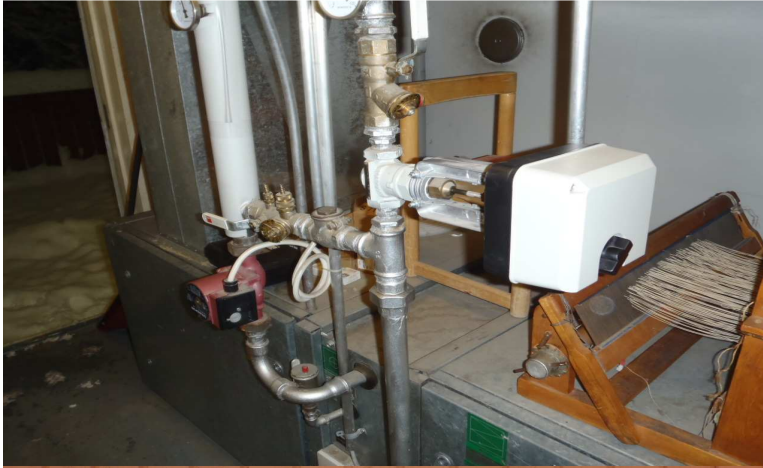
Kuva 1. Yleiskuva IV- konehuoneesta.
