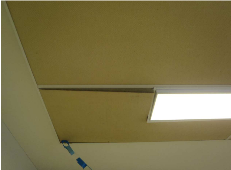
Kuva 10. Lisärakennuksen ka-toissa on akustolevyjä, jotka ovat osittain rikkoontuneet. Levyjen saumoista ja niiden rikkoutuessa huonetiloihin saattaa päästä vuorivillakuituja. Suosittelemme ka-toissa olevien akustolevyjen uusimista tai käsittelemistä suoja-aineella lähivuosien aikana.
