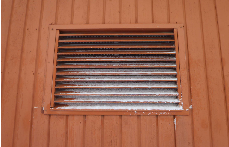
Kuva 2. Tuloilmakoneen raitisilmakammioon saattaa päästä lunta. Tuloilmasäleikön eteen tulisi harkita lumisiepparin asentamista.
