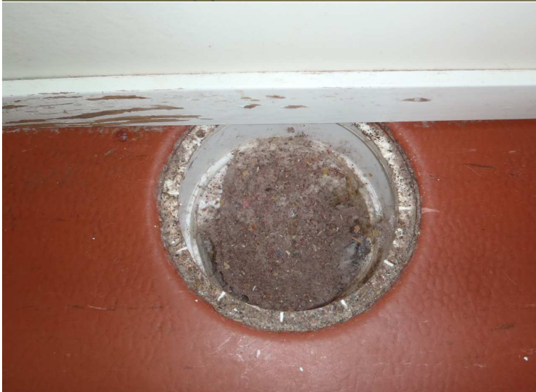
Kuva 11. Kenttäkierroksella havaittiin monta lattiakaivoa, jotka olivat tyhjiä ja joista saattaa päästä viemärihajua tiloihin, kun ilmastointikone lähtee käymään.
