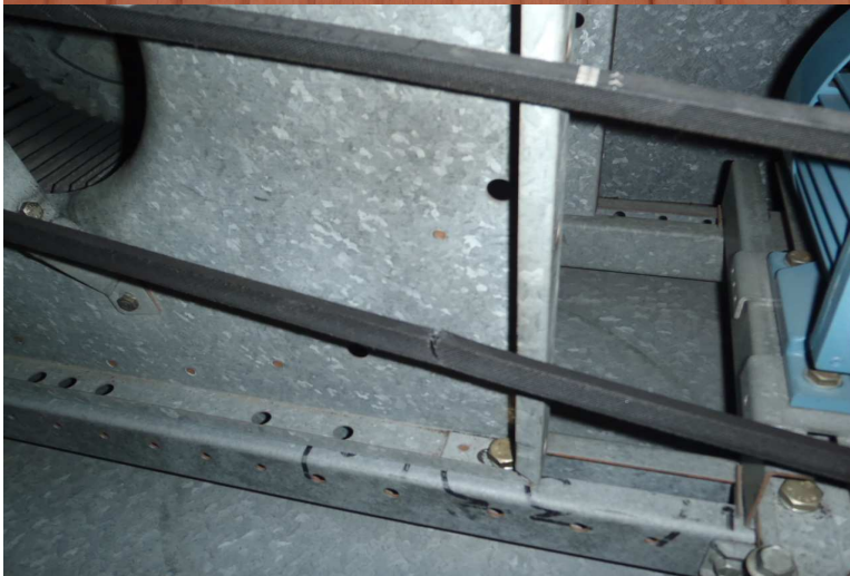
Kuva 3. Tuloilmakoneen hihna on melkein poikki. Hihna tulee uusia välittömästi.
