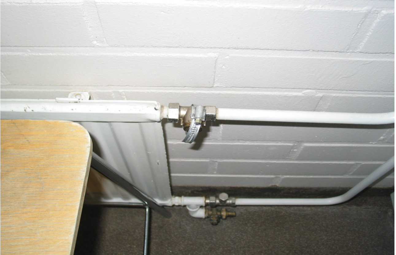
Kuva 1. Patteriventtiilit ovat huonossa kunnossa.
