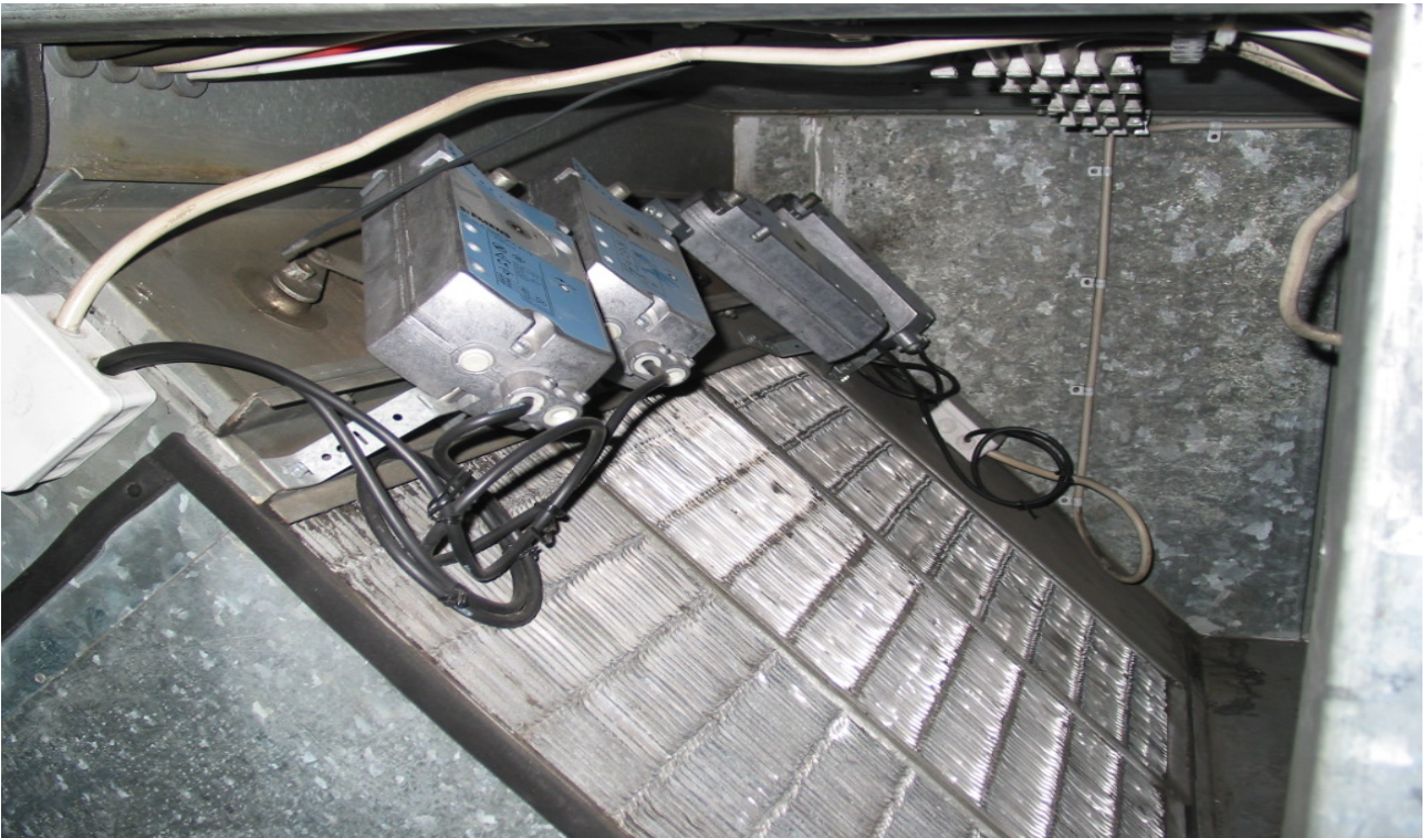
Kuva 2. IV-koneen toimimoottorit ovat uusittuja.
