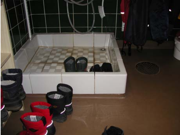
Kuva 1. Märkäeteisen (tila 21) altaan saumat ovat heikkokuntoiset ja allas vuotaa.
