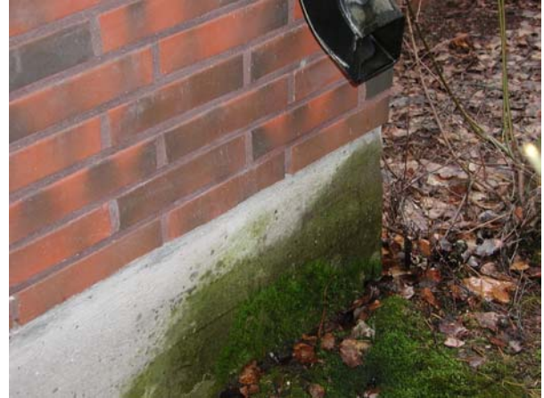
Kuva 4. Syöksytorstesta tuleva vesi roiskuu sokkeleille (henkilökunnan mukaan sisäpuolella on ollut homeen hajua nurkassa).
