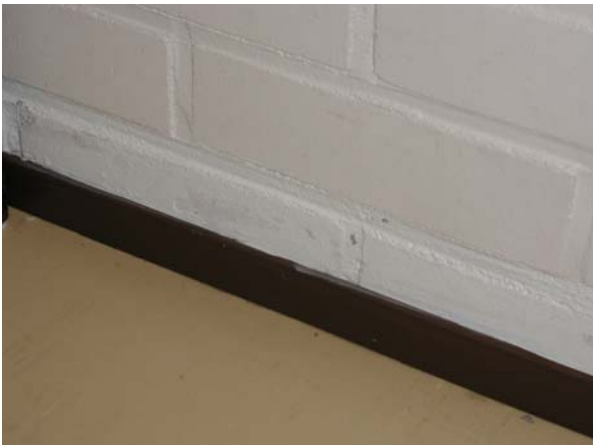
Kuva 2. Osastohuoneen 13 ulkoseinässä tiilen pinnoite on paikoin irronnut.
