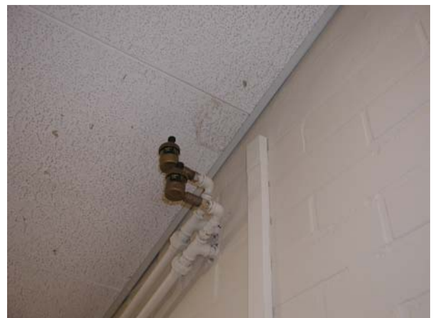
Kuva 6. Puutyöhuoneessa (tila 25) on kosteusvaurioitunut alakattolevy. Katto on vuotanut ennen vuotta 2000.
