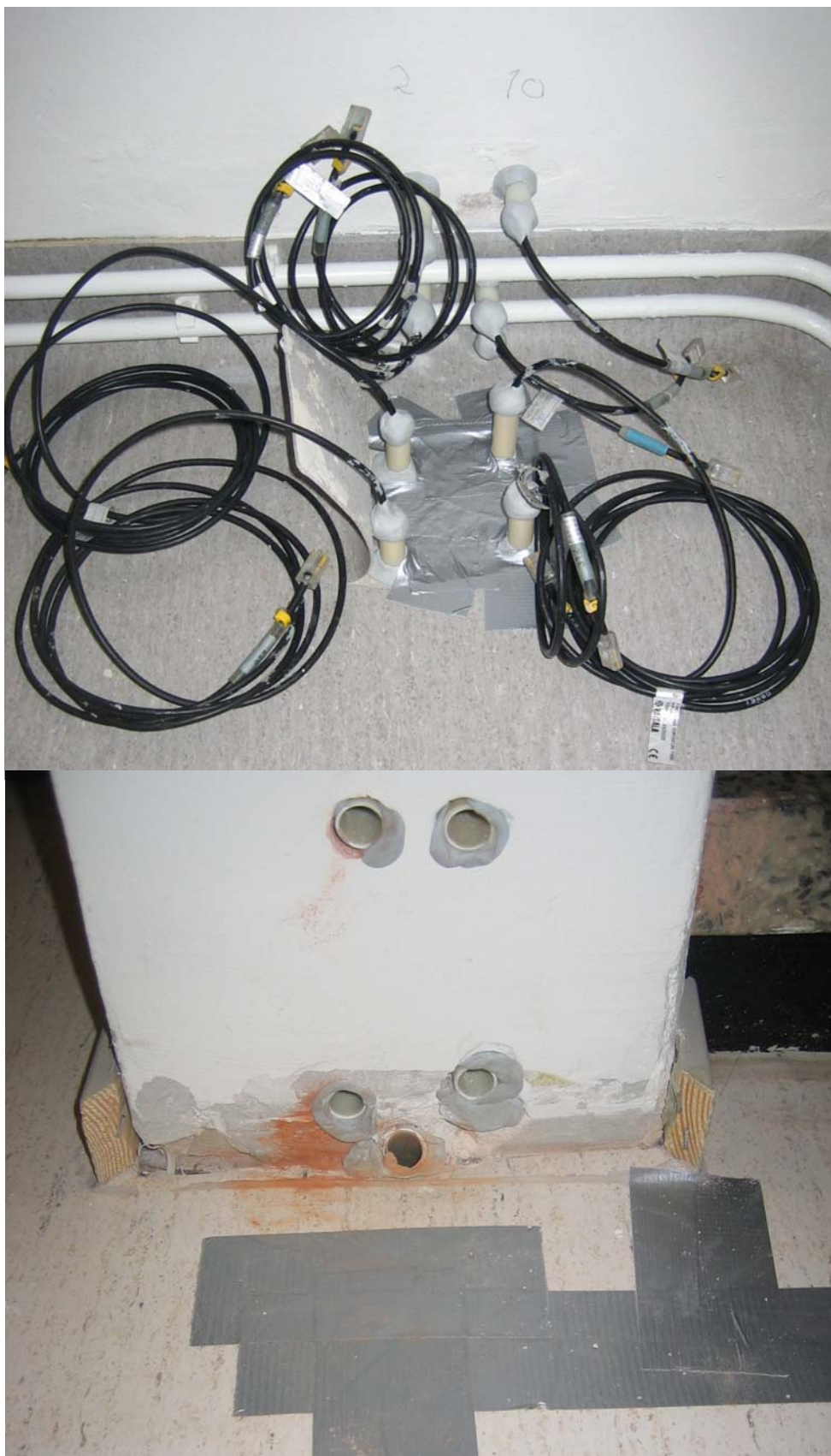
Kuva 2. Ylhäällä lattiamittapisteen L2 mittapäätt lattiassa ja seinässä. Mittapäätt asennettiin heti porausten jälkeen. Alempana lattiapisteen L9 kohdalle seinän päähän poratut ja putkitetut mittausreiät. Mittausputket katkaistiin seinä- ja lattiapinnasta, jotta mittaukset eivät haitanneet viikonloppukäyttöä.
