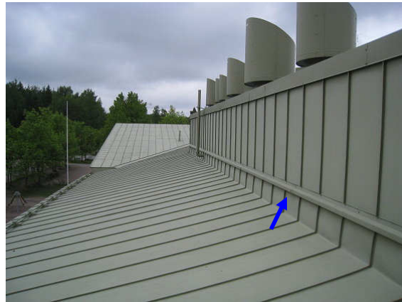
Kuva 38 IV-konehuoneen kohdalla rinta- ja myrskypelttien välit ovat paikoin pienet.
