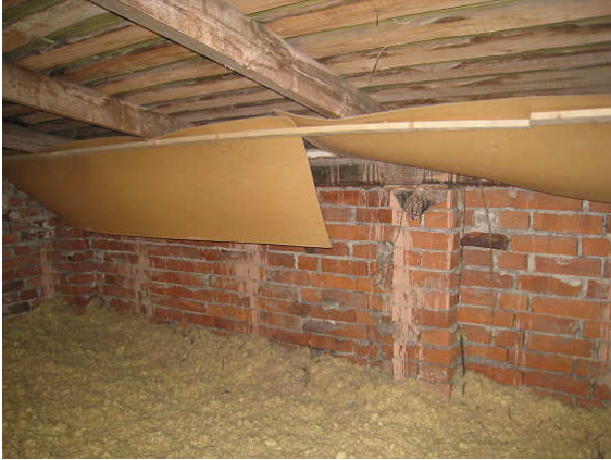
Kuva 35 Ullakkotilan 1:n puutteellisesti asennettua tuuliohjainlevyä.
