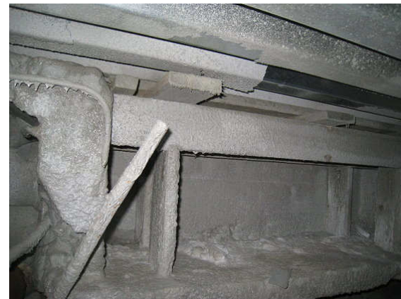
Kuva 16 Tukirakenteita jäljellä D-osalla.
