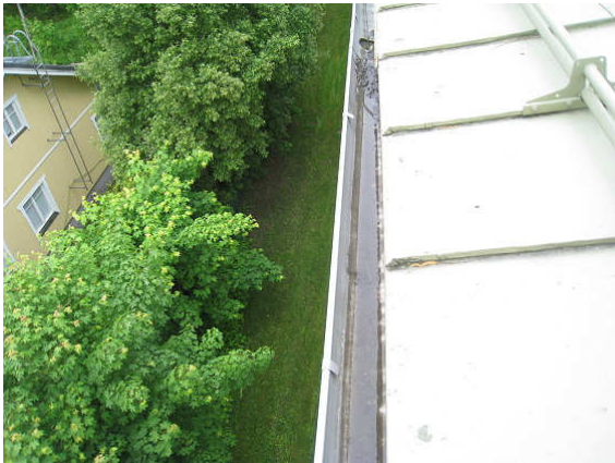
Kuva 37 Räystäskouruun lammikoituu sadevettä. Kouruissa havunneulasia yms..
