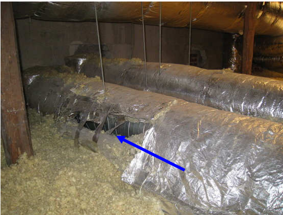
Kuva 31 IV-kanavan rikkoontunutta mineraalivillaeristettä + al.paperia.
