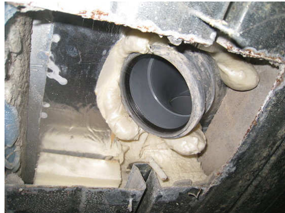
Kuva 20 Tulppaamaton viemäriin pää D-osalla.
