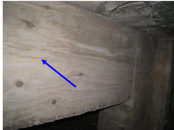
Kuva 14 A-osalla betonipalkin pinnalla puulastua.
