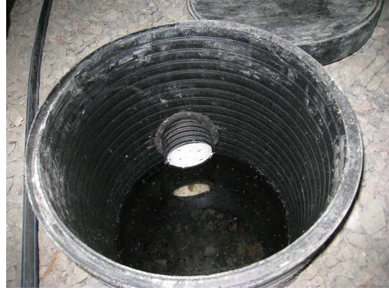
Kuva 24 D-osalla oleva salaojan tarkastuskaivo.
