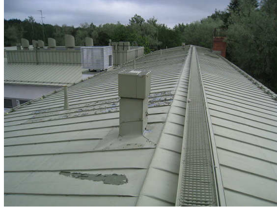
Kuva 36 Pellitystä on uusittu paikoin. Maali hilseilee pellin pinnasta Em. kohdilla.
