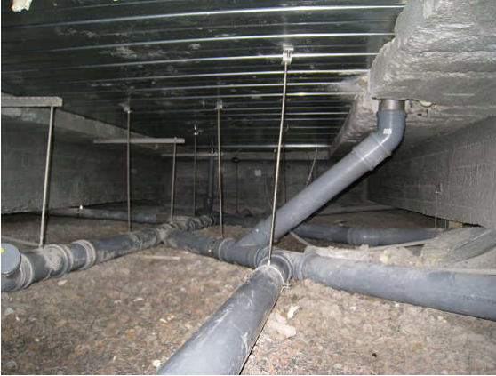
Kuva 17 Muovisia jätevesiviemäreitä keittiön kohdalla alustatilassa.
