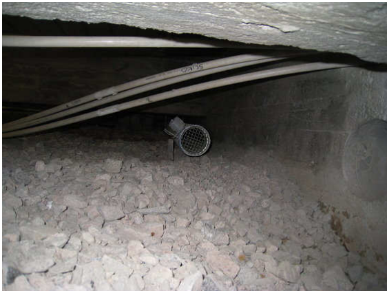
Kuva 7 Alustatiloissa on tuloilmakanavat.
