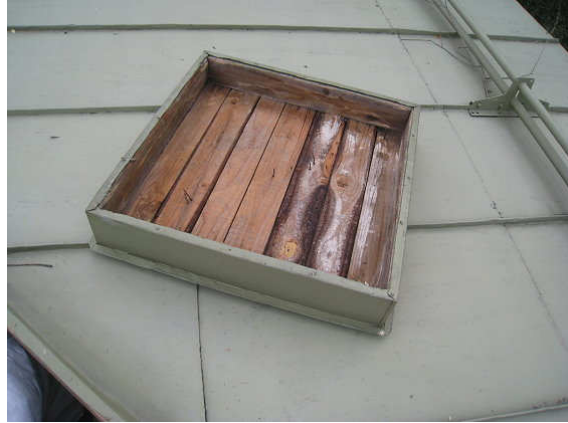
Kuva 30 Kattoluukussa kosteusvaurioitunutta laudoitusta.
