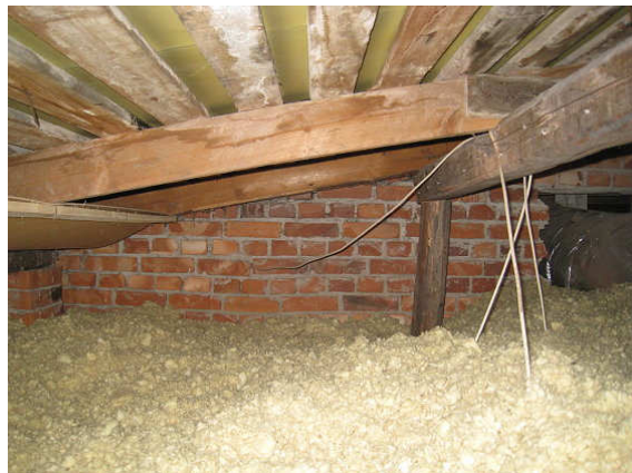
Kuva 34 Aluslaudoituksen pinnoilla kondenssin aiheuttamia vesijälkiä.
