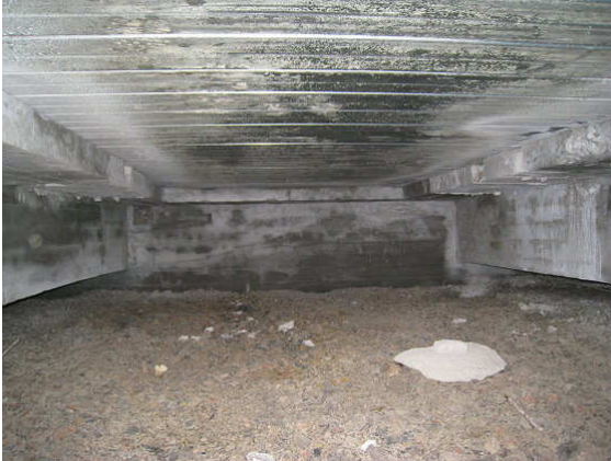
Kuva 1 Betonipinnat pinnoitettu. Liittolaatan alapinnalla kalkkihärmeen omaista nöyhtyä. Betonipinnoilla värieroja
