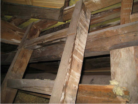
Kuva 29 Kuvan 28 luukun lähellä kosteusvaurioituneet tikkaat vesikatolle.
