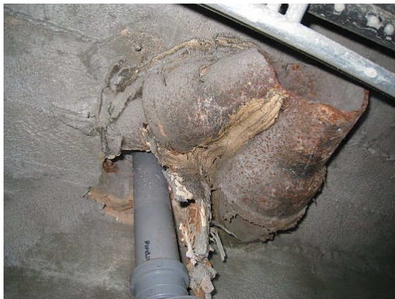
Kuva 21 Vanha valurautaviemäri D-osan alapohjassa.
