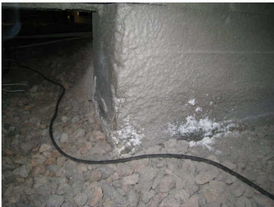
Kuva 3 Kapillaarikosteuden aiheuttamaa kalkkihärmettä.
