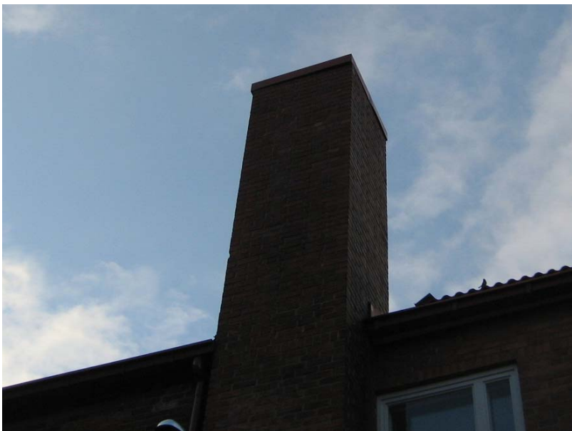
Kuva 7. Maantasosta arvioiden ei piippumuurauksen ja pellityksen välissä ole riittävää rakoa tuuletukselle ja on mahdollista myös, ettei piipun päällä pellityksen teon yhteydessä puurakenteista tuuletusskoolausta ole tehty suunnitelmien mukaan (asiasta ei kuitenkaan ole varmuutta, koska vesikatolle ei ole pääsymahdollisuutta eikä asiaa voitu tarkastaa).
