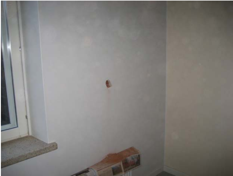
Kuva 1. Rakenneavauskohta AV.01–MH. Avaus käsitti porareian poraamisen makuuhuoneen ulkoseinän läpi savupiipun savuhormiin noin huonekorkeuden puolivälissä.
