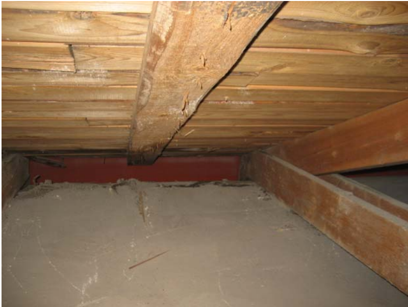
Kuva 4. Makuuhuoneen päällä olevassa ullakkotilassa ei rakennepinnoilta tehty mitään merkkejä tapahtuneista vuodoista, jotka puolestaan olisivat voineet vaurioittaa esimerkiksi yläpohjarakennetta.
