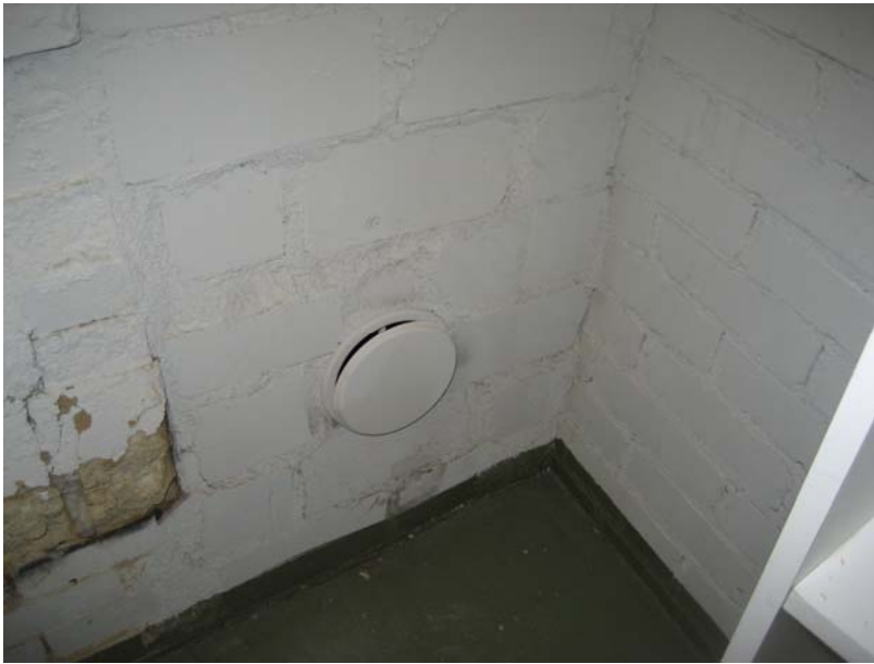
Kuva 6. Kellarikerroksen vanhassa pannuhuoneessa (nykyisessä lämmönjakohuoneessa) on korvausilma-venttiili savupiippuun. Venttiilistä todettiin voimakas ilmavirtaus huonetilaan, mikä kertoo, ettei ilmanvaihto toimi suunnitellusti (ilmavirtauksen tulisi olla päinvastainen, huonetilasta piipun kautta ulkoilmaan).
