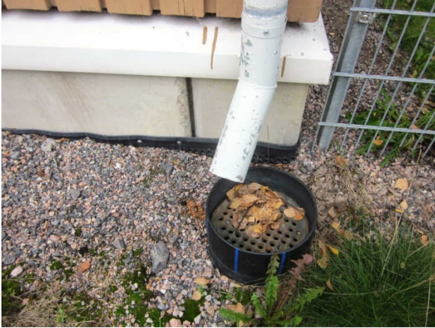
Kuva 10 Syöksytorven ja kattosadevesikaivon keskinäinen sijoitus puutteellinen.
