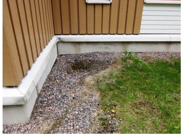
Kuva 8 Kulmakohdilla on vettä kerääviä painanteita.
