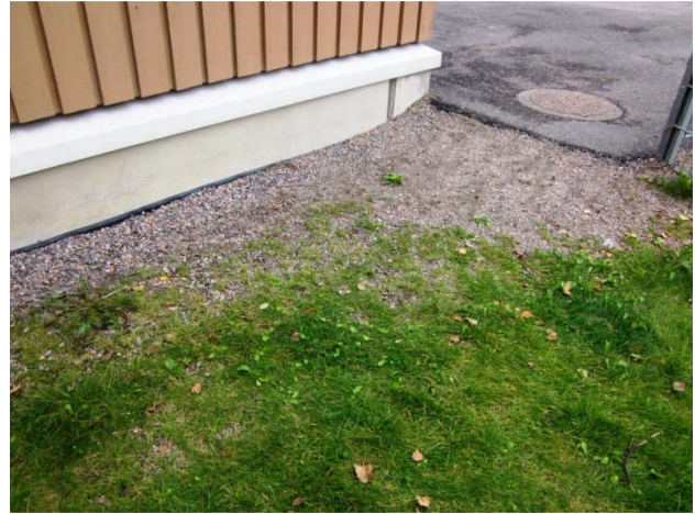
Kuva 2 Maanpinta viettää rakennukseen päin.
