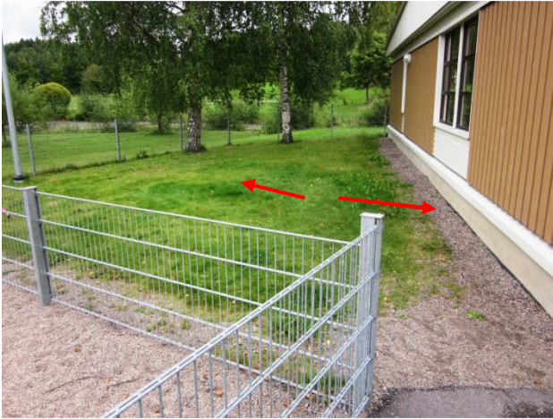
Kuva 1 Maanpinta viettää rakennukseen päin.
