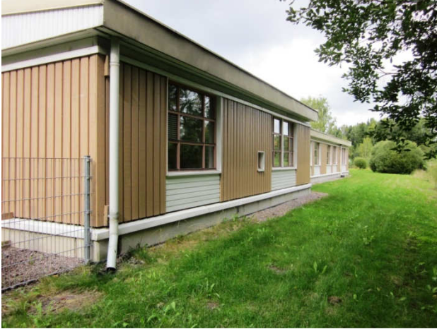
Kuva 7 Maanpinta viettää pääsääntöisesti rakennuksesta poispäin.
