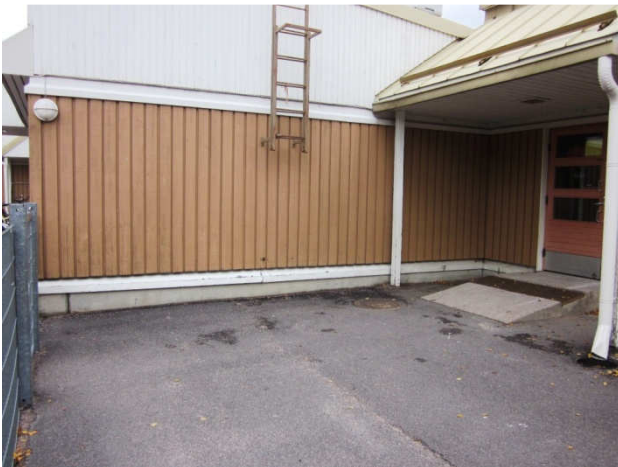
Kuva 3 Asfaltin ja sokkelin liittymässä ei ole ns. reunamakkaraa.
