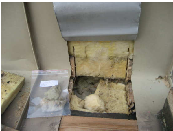
Kuva 45 Avauskohta 2 ja tummuneista villoista otettu mikrobinäyte, joka sisälsi kosteusvaurioon viittaavia mikrobeja.
