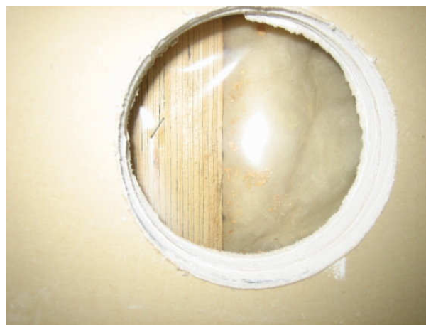
Kuva 26 Kattolyhdyn pystyseinässä on terveen värinen villa ja puurunko + höyrynsulku.
