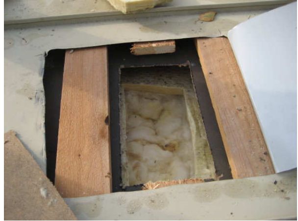
Kuva 42 Avauskohta 1 kohdalla puutavara ja villat ovat terveen väriset.
