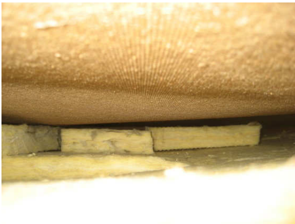
Kuva 43 Avauskohta 1 ilmarako on osin tukittu korokevillailla.
