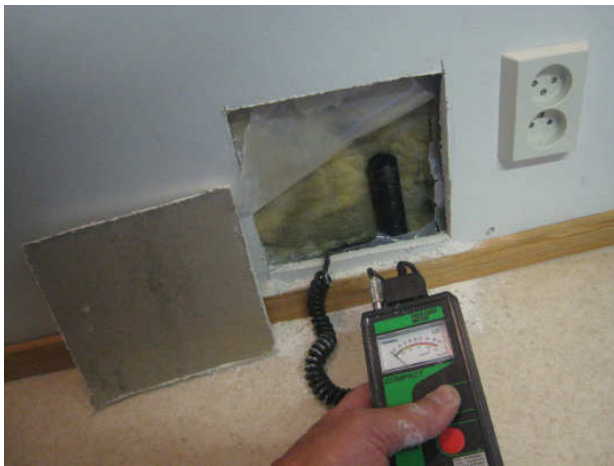
Kuva 7 Huoneen 59 avauskohta ikkunan pielessä, villa on tummunut, alasidepuun puutavara on kuivaa, n. 8 paino-%.
