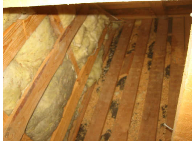
Kuva 36 Kattolyhdyn umpipäädyn villoja ja onte- lotilan kohdalla oleva ruodelauditus. Vuotojälkiä ei havaittu luukun aukosta tähytämällä. Levyn päällä on purua.
