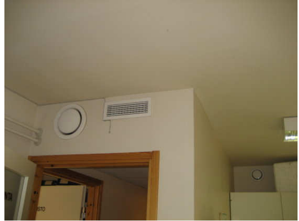
Kuva 12 Huoneen 46 katon vaakasuuntainen osa on alakattoa. Poisto- ja tuloilmaventtiilit ovat ilmanvaihdon kannalta väärin.
