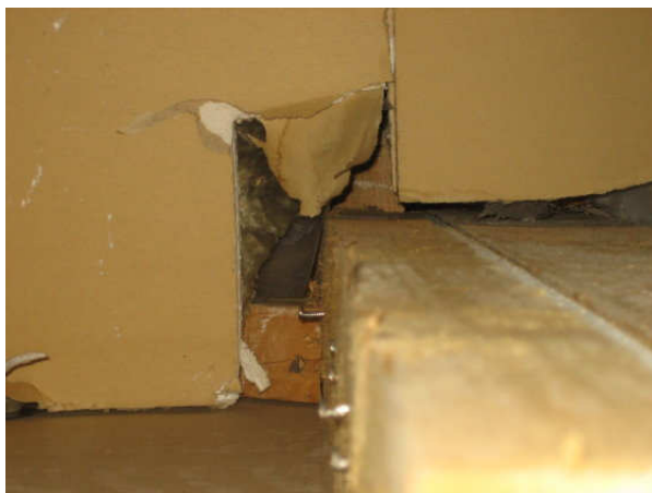
Kuva 27 Kattolyhdyn liittymässä on huonoja eristyksiä ja höyrysulun epätiiviyshetia tilan 56 – 57 kohdalla.
