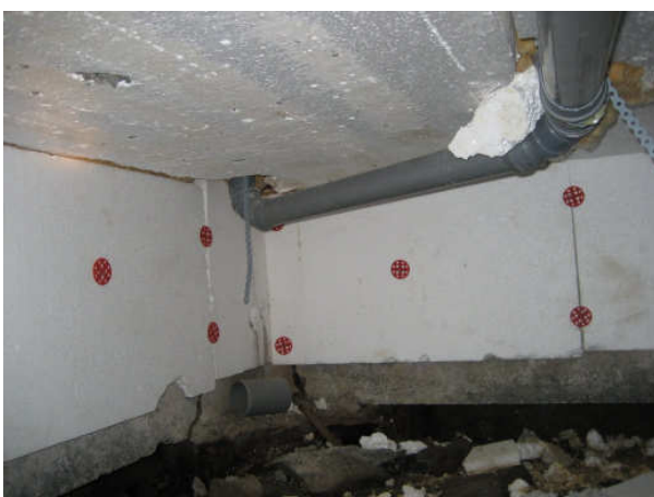
Kuva 3 Puutteellisia läpivientien eristyksiä, viemärien kannakointeja on irti. Viemärin kaato on väärä TK 11 kohdalla.
