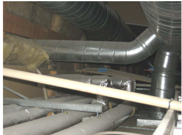
Kuva 32 Pölyisiä kanavia ja putkia sekä väliseinien villaa tilan 23 kohdalla.
