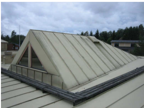
Kuva 33 Yleiskuva kattolyhdystä, jonka yläpohjan ilmatilan tuuletus on puutteellinen. Kattosillat padottavat vedenkulua.
