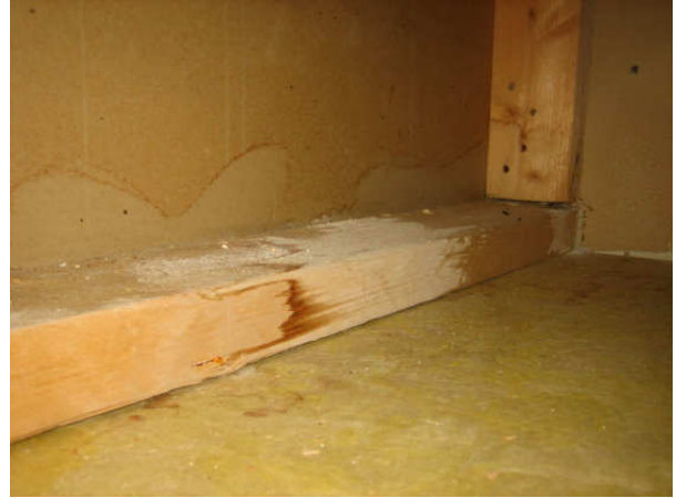
Kuva 30 Vuotojälkiä alakattolevyn yläpinnassa ja koolingeissa tilan 28 kattolyhdyn kohdalla.
