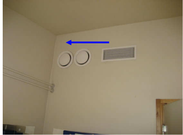
Kuva 18 Huoneen 28 viiston yläpohjan ja väliseinän liittymässä on pintavaurioita.
