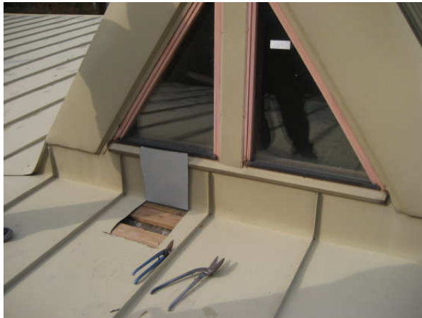
Kuva 55 Avauskohta 9, joka tehtiin tilan 7 kohdalle. Tuuletusreittiä ei ole juurinos- toon.
