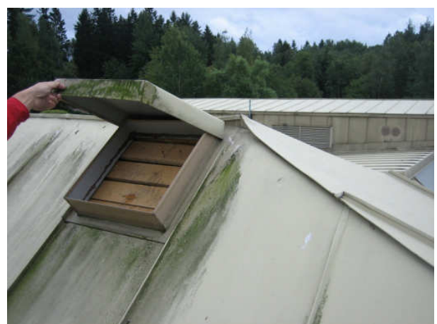
Kuva 34 Kattolyhtyjen tarkastusluukun kohdalle on jätetty aluslaudoitus. Luukusta ei mahdu kuin pieni ihminen.
