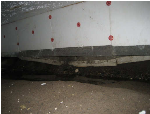
Kuva 1 Sokkelipalkin ulkopuolelta on valunut maata ja routaeristeet ovat painuneet.
