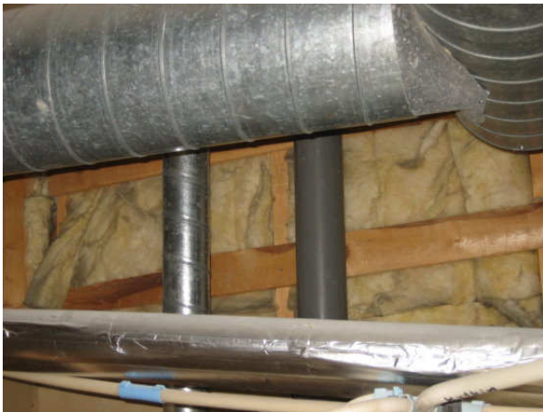
Kuva 31 Päälystämättömiä villoja alakaton yläpuolisessa ontelotilassa.
