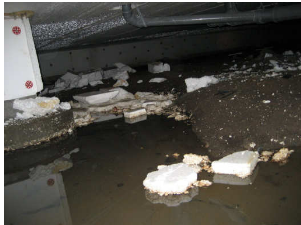
Kuva 2 Lammikoita ulkoseinien ja keskialueen perustuspalkkien kohdalla, katossa on kondenssivettä, hiekan pinta on märkä.
