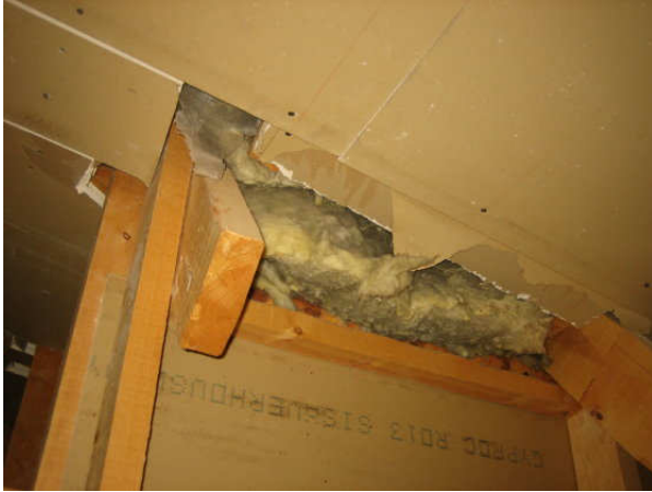
Kuva 29 Huonosti tehty liittymä tilan 07 kattolyhdyn kohdalla (eriste+höyrinsulku). Villat ovat tummuneet.
