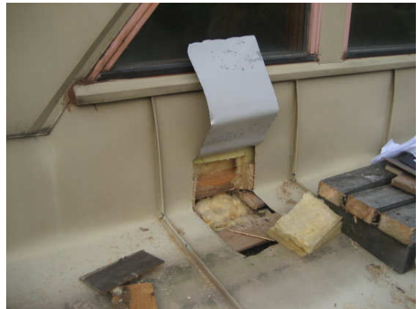
Kuva 50 Avauskohta 5 kohdalla tuuletusväli on tukittu koolingeilla ja villa oli tummaa.
