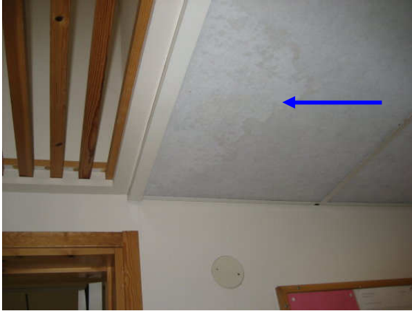
Kuva 17 Vuotojälkiä eteistilan 28 katon akustikkalevyissä, joiden yläpuolella on kattolyhty.
