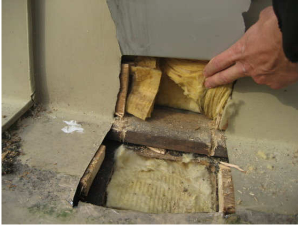
Kuva 47 Avauskohta 3 kohta, josta otettiin mikrobinäyte 2, joka sisälsi kosteusvaurioon viittaavia homeita ja sädesieniä.
