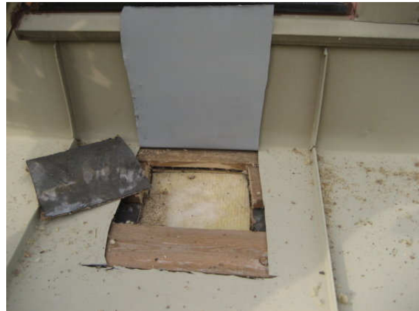
Kuva 56 Avauskohta 9 kohdalla oli kovalevyn pinnalla vuotojälkiä.
