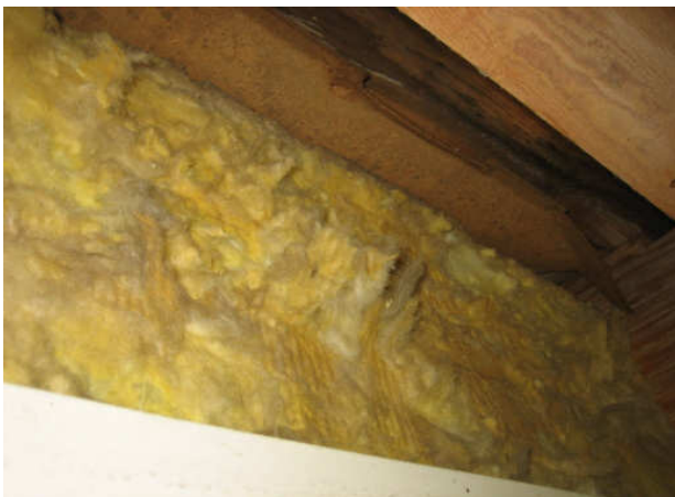
Kuva 21 Ulkoseinän kova villa nousee paikoin vasten aluskatteena olevaa kovalevyä, jolloin tuuletusväli ei tuuletu.
