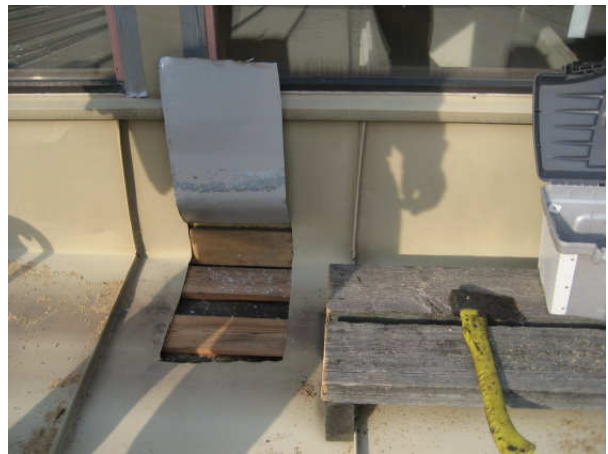
Kuva 44 Avauskohta 2, jossa ilmarako ei nouse juurinostoon, joten ei tapahdu tuuletusta.
