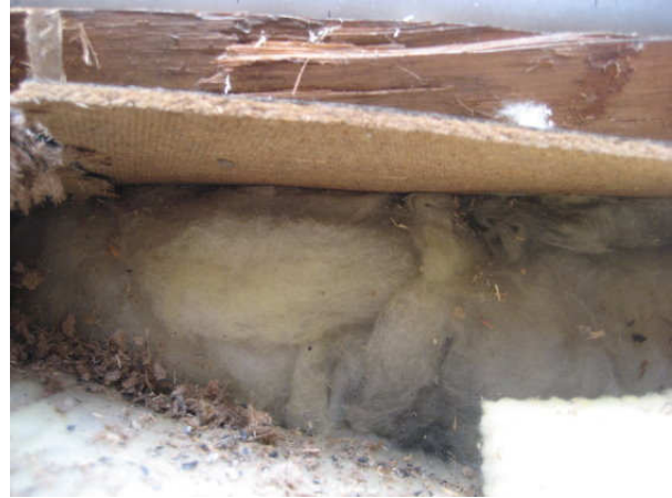
Kuva 54 Avauskohta 8 kohdalla villa oli tummaa ja kovalevyn yläpinnassa oli valumajälkiä.
