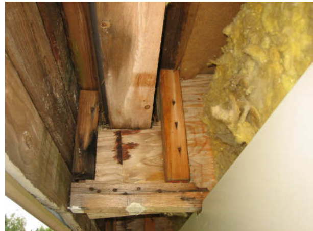
Kuva 22 Vuotojälkiä ja lahovaurioita räystäslaudoissa rännivuodon takia.
