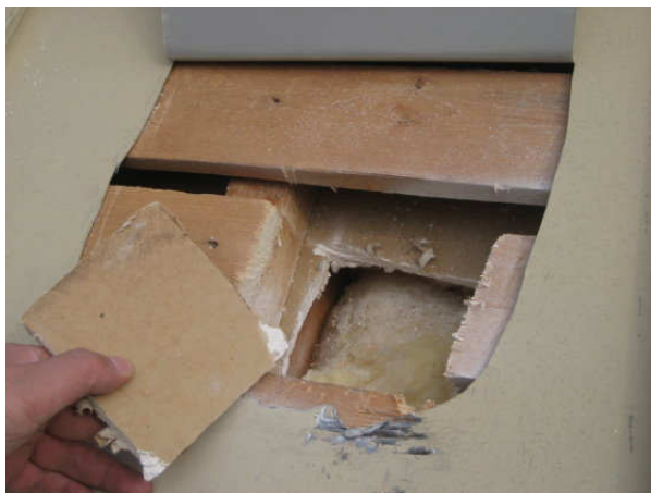
Kuva 9 Avauskohta 6 kohdalla kattolyhdyn ilmarako on 50 mm, alla kipsilevy ja villa, joka on huonosti asennettu.
