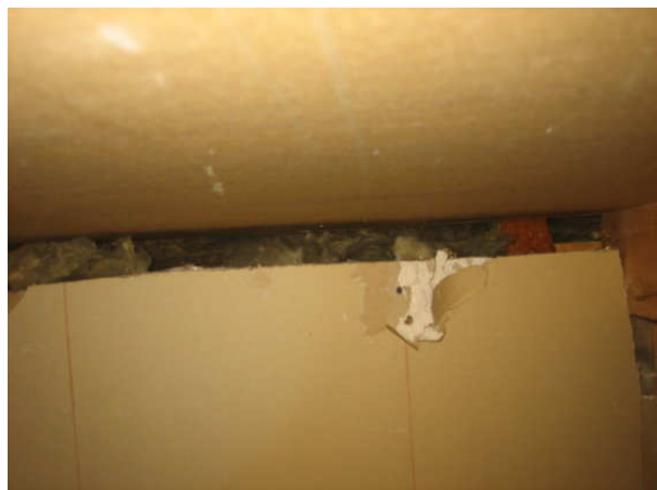
Kuva 28 Kattolyhdyn liittymässä ei ole tällä kohdilla höyrynsulkua sisäpinnassa.
