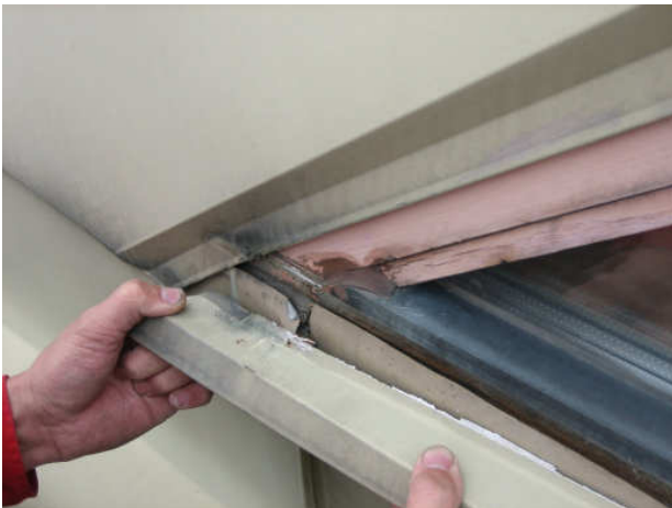
Kuva 37 Kattolyhdyn ikkunoiden liittymissä on vuotorakojia. Jiirinoston alusta ei pää- se tuulettumaan yläreunastaan.
