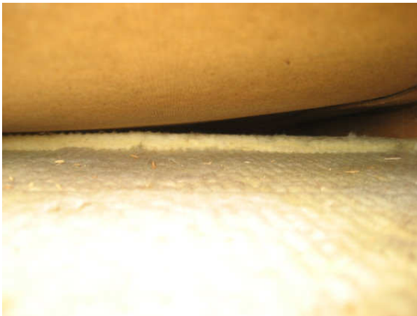
Kuva 49 Avauskohta 4 kohdalla villa on terveen värinen, mutta aluskate painuu keskeltä tukkien ilmavälin.
