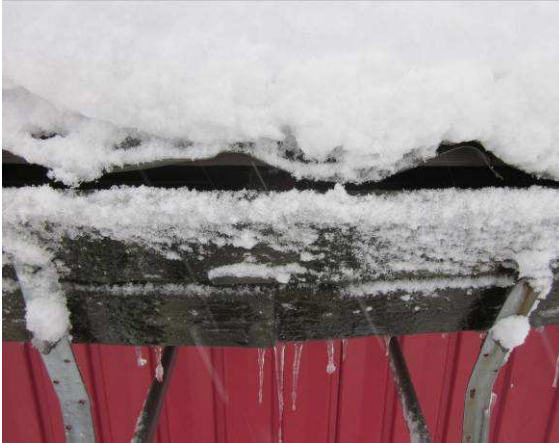
Talotikkaiden kiinnityskohdasta räystäslaudat ovat lähteneet irti
