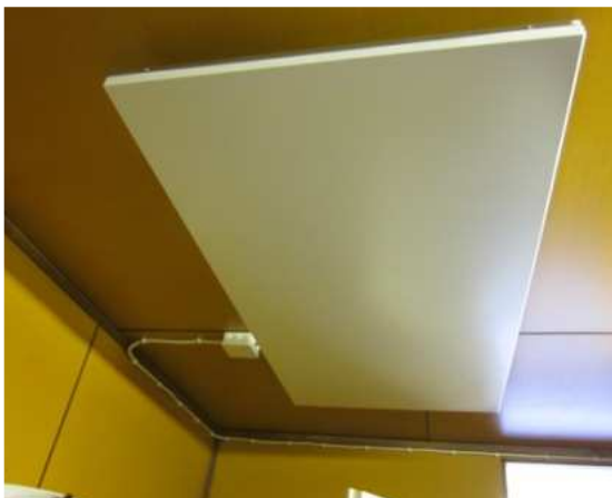
Pukutilan lämmitin on katossa.
