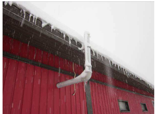
Rakennuksessa ei ole räystäskouruja
