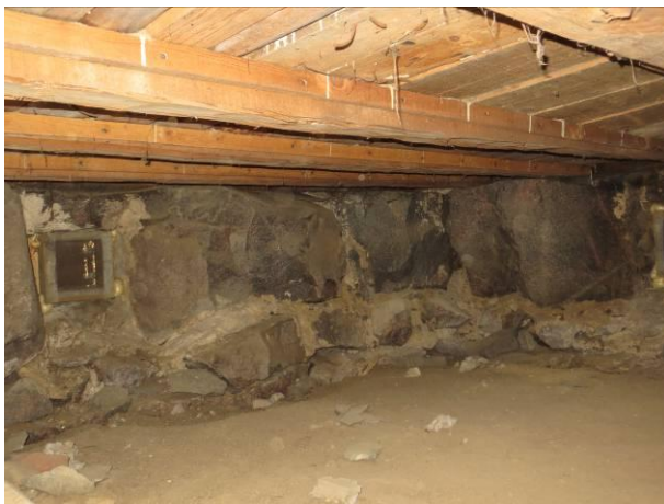
Kuva 19 Itäisivun kaakkoiskulma, hyväkuntoista aluslaudoitusta.
