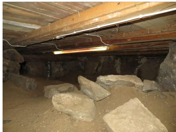
Kuva 16 Opettajien huoneen alta itäsisivulta, yleisvalaistus, etualalla on mahd. irrotettuja perustuskiviä.
