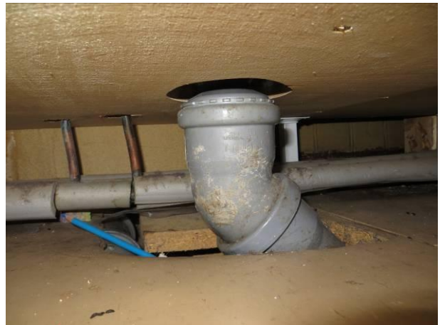
Kuva 26 Epätiivis viemärläpivienti pohjoispäädyn opetustilan alakaapin alla.
