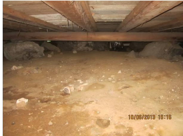
Kuva 10 Länsisivun pohjoisosan alueella alapohjan rakenteita, maa on paikoin kostea, kuvattu ulkoa luukun kautta.
