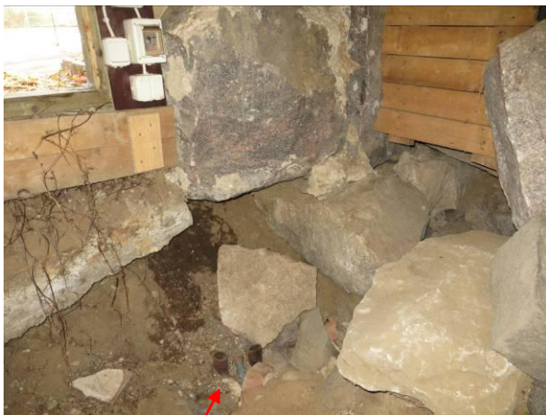
Kuva 15 Vesivaluma kulkuluukun alta, vanhoja putkia maassa.
