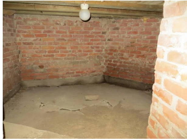
Kuva 28 Yleiskuva kellarista, jossa lattia ja seinien alaosa ovat märkiä.
