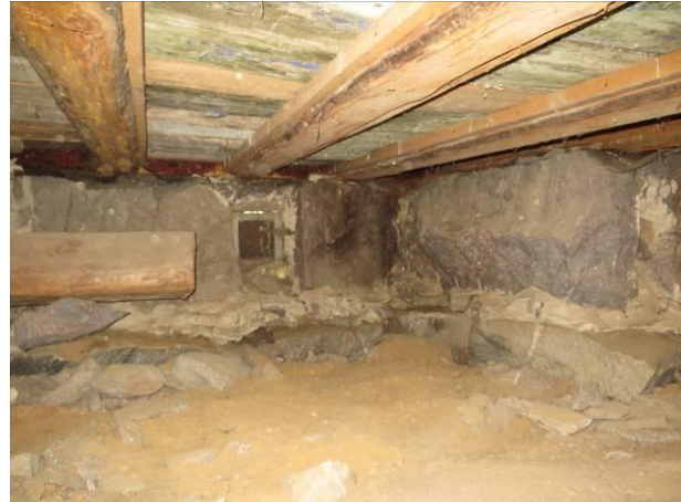
Kuva 8 Alapohja tukeutuu perusmuurille, havaintopaikka on pääsisäänkäynnin eteisen alta. Maata on poistettu perusmuurin viereltä liikaa.
