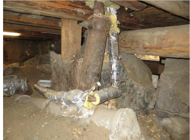
Kuva 14 Huonot eristeet putkissa ja viemäreissä.
