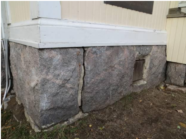
Kuva 7 Kivien siirtymän takia tullut halkeama pääsisäänkäynnin vierellä.
