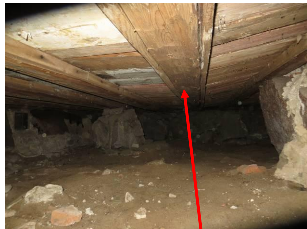
Kuva 22 Pohjoisosan alla parru on painunut välituen puuttumisen takia, maanpinta on kostea, kellarin lähellä jopa märkä.
