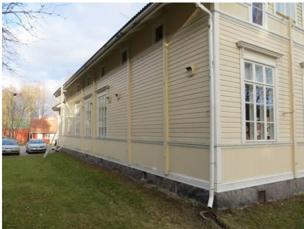
Kuva 11 Länsisivua, jossa on riittävästi tuuletusluukkuja, mutta olivat osin kiinni.
