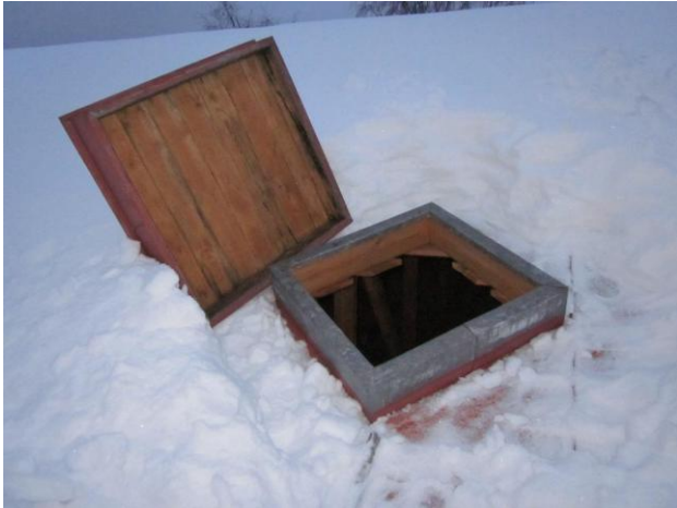
Kuva 1 Kattoluukussa kosteuden aiheuttamia jälkiä.
