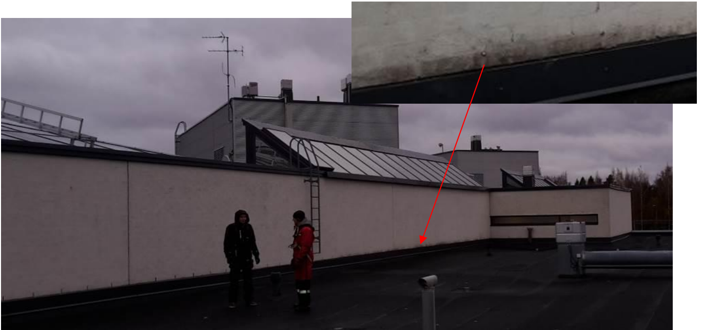
Kuva 11. Julkisivun O ylin osa, itäkoillisen suuntaan. Tämä osa julkisivusta on pääosin hyvässä kunnossa. Paikoin alaosan rappaus on tummunut/likaantunut, johtuen luultavasti talvisin lumen kasaantumisesta katolle.
