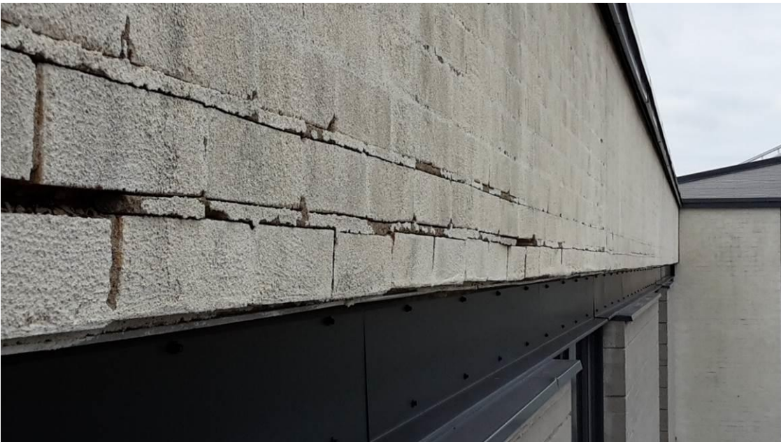
Kuva 6. Julkisivun G yläosa, etelälounaan suuntaan. Alimmasta tiilisaumasta muurauslaasti on irronnut tai irtoamassa. Alimmat tiilet eivät ole suorassa linjassa. Tiilet ovat tiukasti kiinni, eikä irtonaisia/irtoavia tiiliä havaittu.
