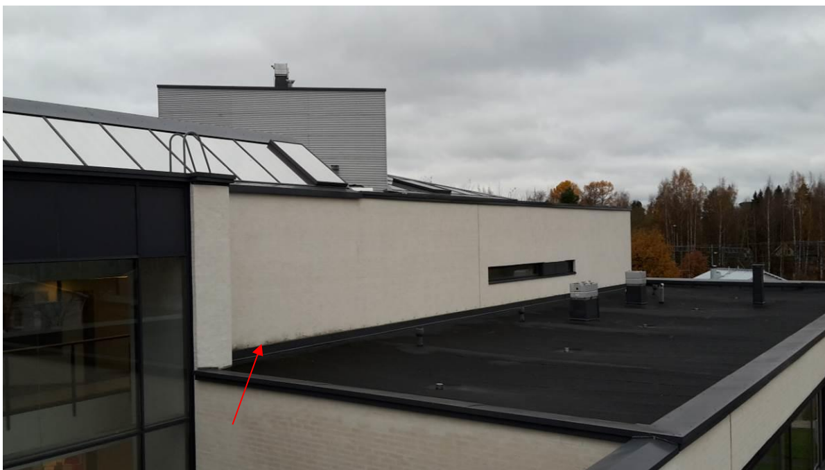
Kuva 10. Julkisivun O sisäänvedetty osa. Tämä osa julkisivua on hyvässä kunnossa. Alaosassa on hieman tummunutta/likaantunutta rappausta, johtuen luultavasti talvisin katolle kasaan- tuneesta lumesta.
