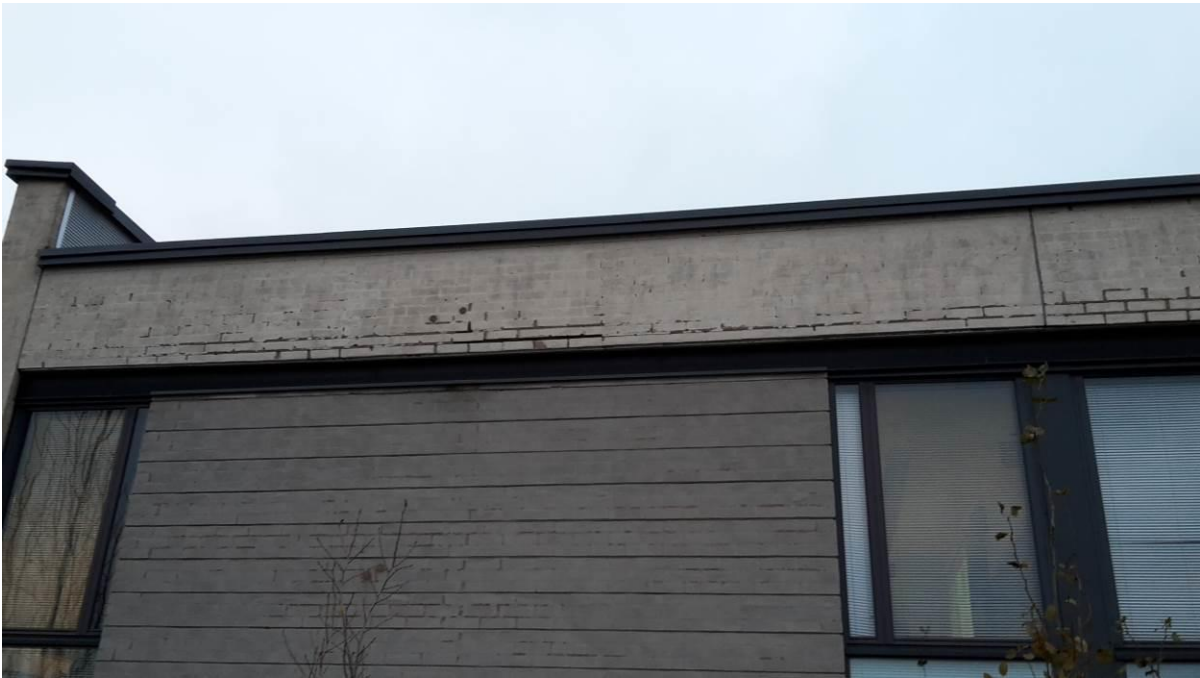
Kuva 1. Julkisivu B, etelälounaan suuntaan. Julkisivun yläosassa muurauslaasti ja pintalaasti ovat rapautuneet tiilisaumojen kohdalla varsinkin alimmissa tiilisaumoissa. Toiseksi ylintä tiilisaumaa pitkin kulkee pitkittäinen noin 1-2 mm paksu halkeama.
