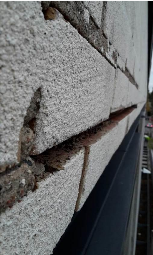
Kuva 5. Julkisivu B, etelälounaan suuntaan. Alimmat tiilet näyttäisivät olevan hieman kallellaan ulkoreunastaan, mutta ovat tiukasti kiinni seinässä. Irtonaisia, liikkuvia tai ulkonevia tiiliä ei havaittu.
