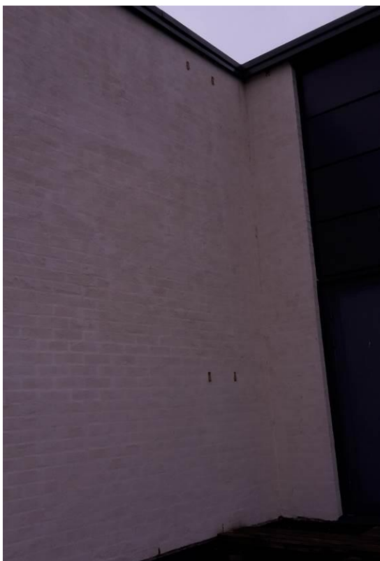
Kuva 9. Julkisivu M, pohjoisluoteen suuntaan, on hyvässä kunnossa. Seinässä on vanhat pa- lotikkaiden kiinnityskohdat, joita ei ole paikattu.
