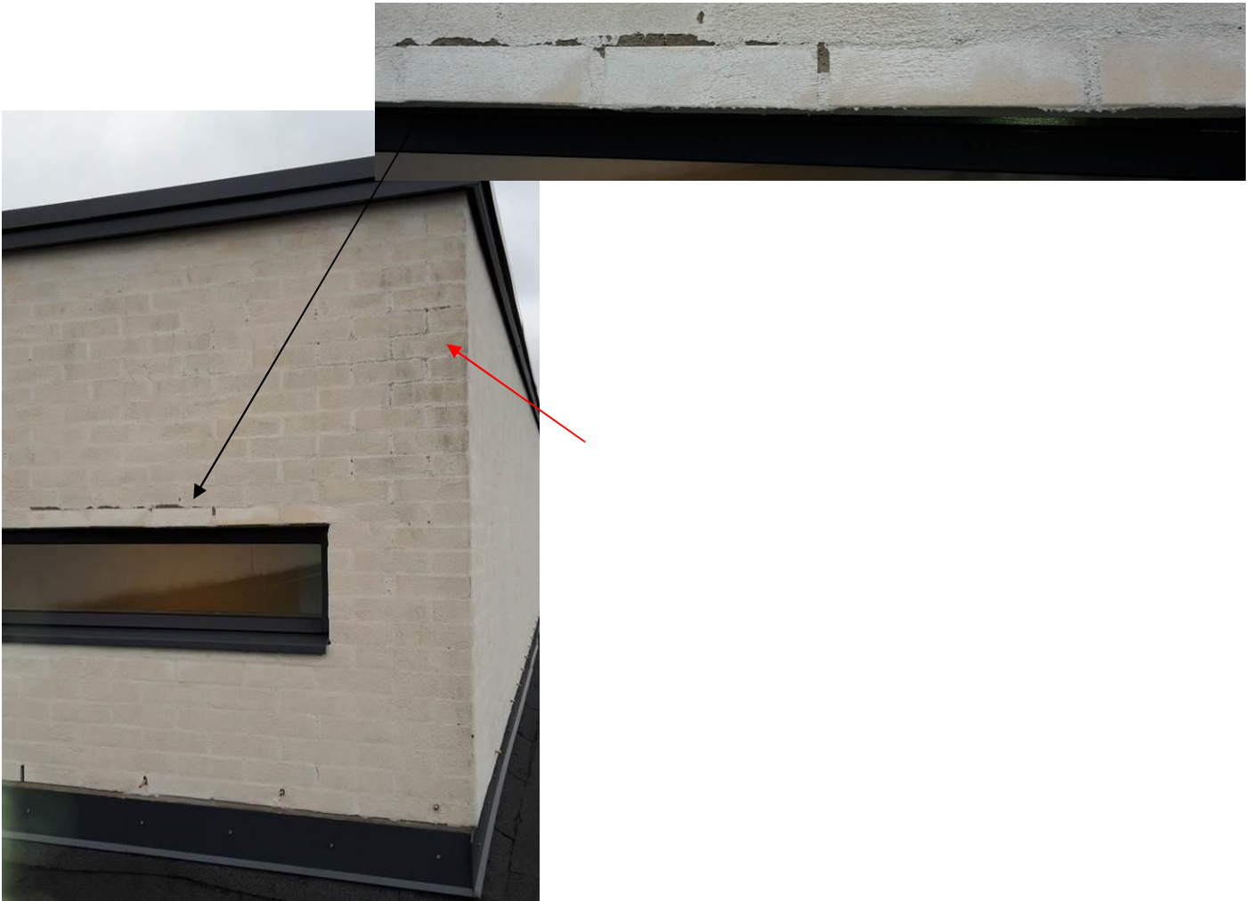
Kuva 13. Julkisivun P ylin osa, eteläkaakon suuntaan. Ikkunan yläpuolella kuultorappaus on hyvin ohutta tiilien päällä ja paikoin rapautunut muutaman sauman kohdalta. Julkisivussa on paikoin havaittavissa alkavaa vaurioitumista (punainen nuoli).
