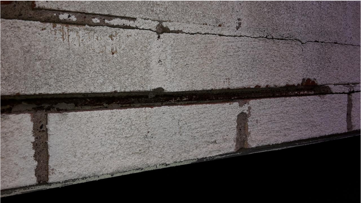
Kuva 7. Julkisivun G yläosa, etelälounaan suuntaan. Alimmassa tiilisaumassa raudoitus on paikoittain hyvin pinnassa ja ruostunut. Muurauslaasti on irronnut pinnassa olevan harjateräksen ulkopuolelta. Alimman tiilirivin alapuolella näkyy lattateräs, joka on osa tiiliseinän kiinnitysjärjestelmää, ks. liite 2.
