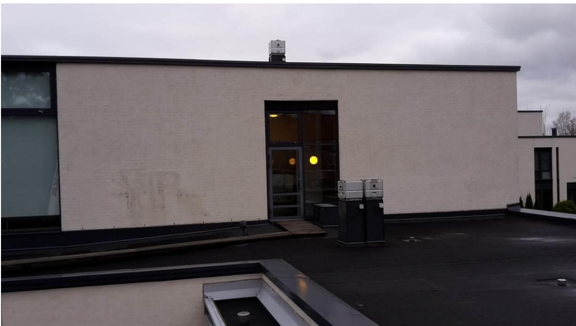
Kuva 12. Julkisivun O sisäänvedetty osa, itäkoillisen suuntaan. Seinästä on puhdistettu graffiti, mutta muuten rappaus on hyvässä kunnossa.
