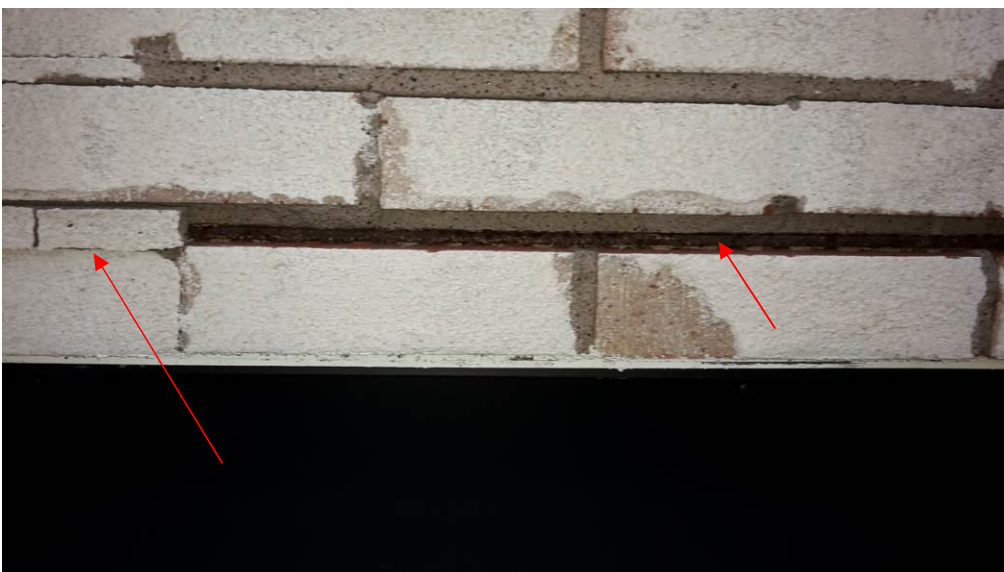
Kuva 4. Julkisivun B yläosa, etelälounaan suuntaan. Alimman vaakasauman harjateräs on tavanomaista teräslaatua (ei RST). Ruostuminen on käynnissä ja ruoste on irrottanut muurauslaastia saumoista. Saumoissa on irtonaisia muurauslaastin paloja.
