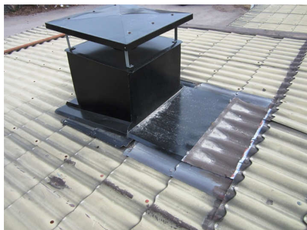
Kuva 20 Suojapellitys on asennettu epämääräisesti.
