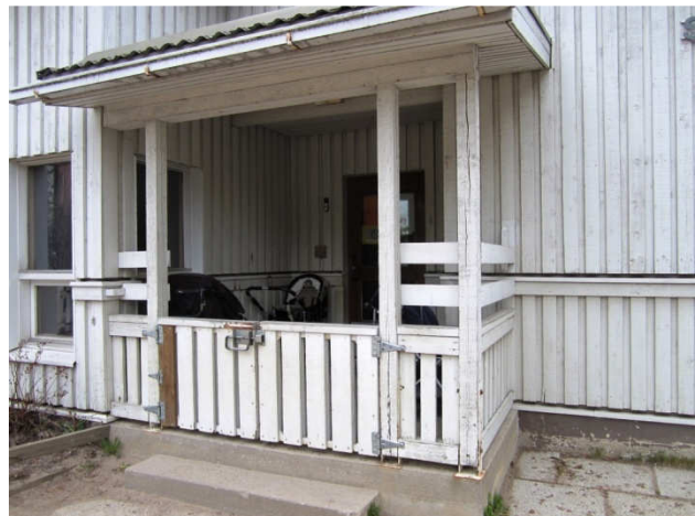
Kuva 12 Sisäänkäynti katos länsipäädyssä. Pinnat ovat kuluneet.
