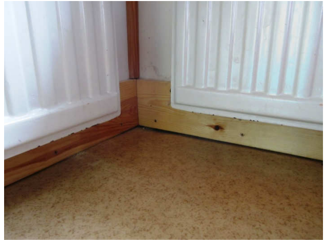
Kuva 8 Lattia on epätasainen. Korkeiden jalkalistojen ja muovimaton välissä massaa.
