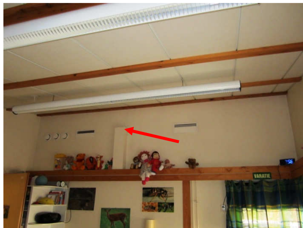
Kuva 14 ilmapuotoa putkiläpiviennin kohdalla.
