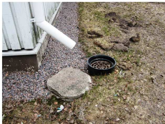
Kuva 2 Kattovesikaivo ja syöksytorvi eivät ole kohdakkain.
