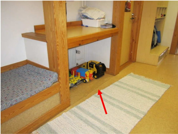
Kuva 7 Lattiasa kohoumia ja kuvassa muovimaton alla halkeama.
