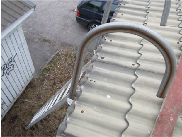
Kuva 21 Nousukohta vesikatolle. Kaaria ei ole tuettu.
