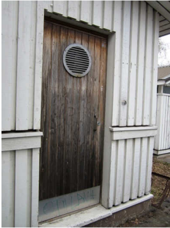
Kuva 17 Ulkopinnaltaan kulunut ovi.
