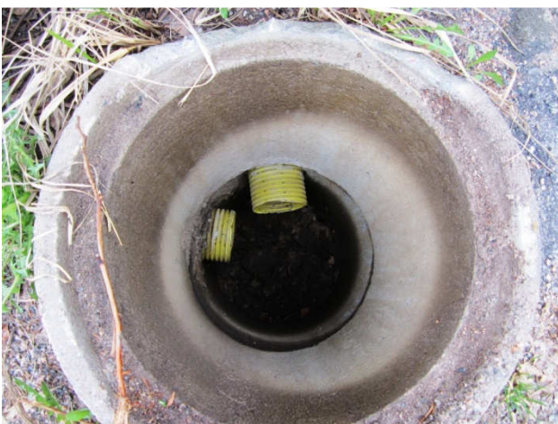
Kuva 9 Salaojien tarkistuskaivo luoteiskulmalta. Betonirenkaat eivät ole kohdakkain.
