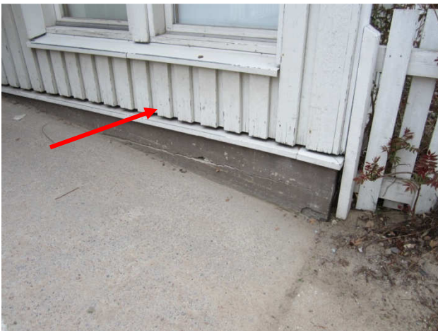
Kuva 11 Lautojen alaosilla rakoilua.
