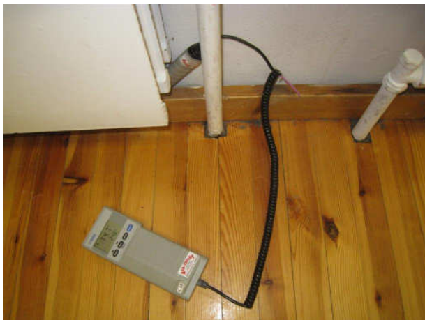
Kuva 23 Kosteusmittaus VTV4 salin ja ruoka- lan rajalta mp-seinän vierestä. Hyvin kosteaa villatila 75 %RH.
