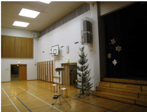
Kuva 15 Liikuntasalin ongelma-alue on näyt- tämön vieressä oleva välinetila.
