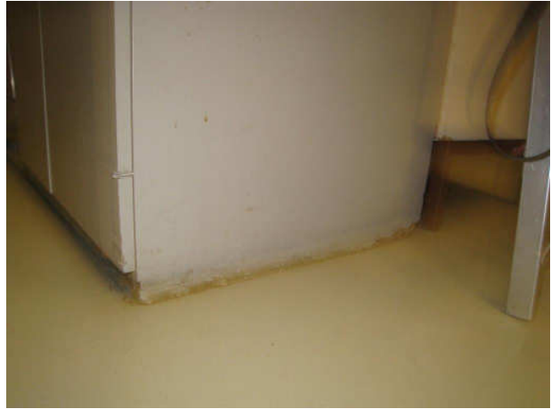
Kuva 28 Tyttöjen pukuhuoneen komero on turmeltunut alaosaltaan.
