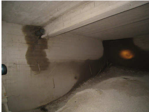
Kuva 3 Kondenssiveden aiheuttamaa kastumista päädyssä ja kulmassa.
