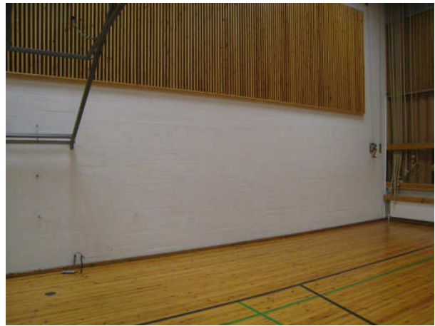
Kuva 26 Päätyseinän kosteusmittaus VTV7 26 %RH, ilmatila oli viileä 14,8 °C.
