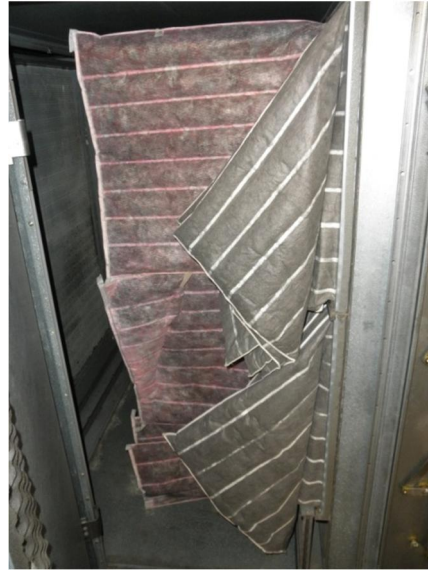
Kuva 10. TK01 tuloilmasuodattimina oli rinnakkain kahta eri tyyppistä suodatinta.
