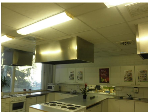
Kuva 25. Kotitalousluokissa on alakattoon asennettuja tuloilmahajottajia sekä poistoilmahuuvut liesien yläpuolella.
