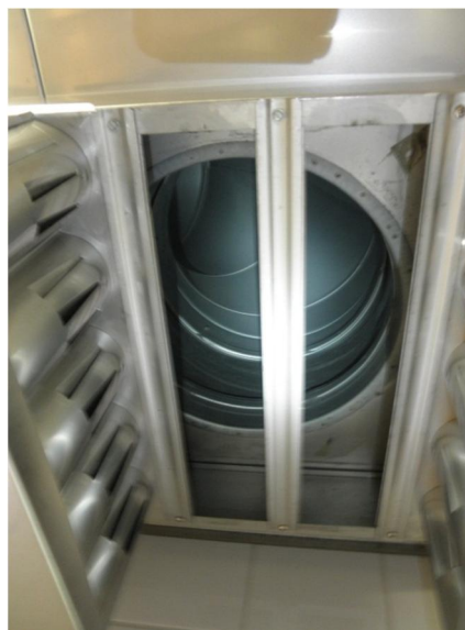
Kuva 39. Kaikki rasvanerottimet olivat puhtaita ja astianpesulinjan poistoilmakanavan (kuvassa) likakertymä vähäinen.
