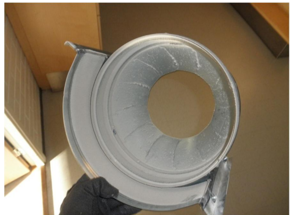
Kuva 22. Luokan poistoilmakanavan säätöpelti irrotettuna. Säätöpellissä on pölykertymää, mutta pölyn määrä on niin vähäinen, ettei se vaikuta toimintaan.
