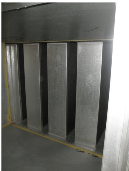
Kuva 7. TK07 äänenvaimennin, joka sijaitsee tuloilmapuhaltimen painepuolella.
