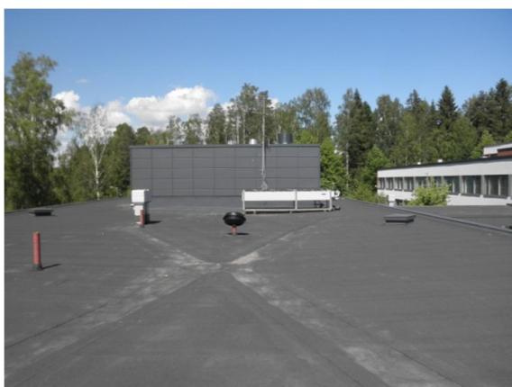
Kuva 1. Vesikatolle on rakennettu ilmanvaihtokonehuoneita, jonne on sijoitettu luokkia palvelevat koneet.
