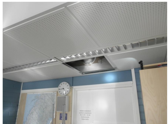
Kuva 28. Yksi alakattolevy poistettuna. Poistetun levyn kohdalla havaittiin ilmavirtaus luokkaan päin.
