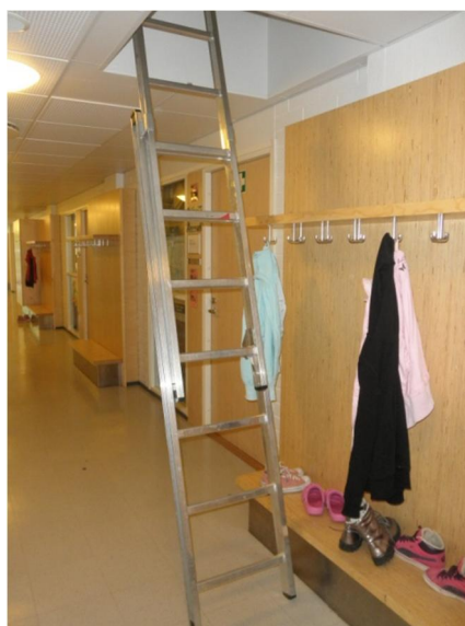
Kuva 2. Vuonna 2002 rakennettuihin konehuoneisiin pääsee vain vesikatolta tai käytävien kattoon asennettujen luukkujen kautta.
