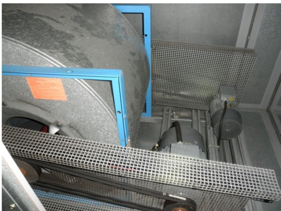
Kuva 13. TK01 tuloilmapuhallin on 2-nopeuksinen. Kiilahihnat olivat kunnossa ja siipipyörä puhdas.
