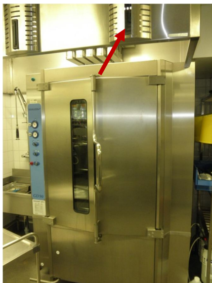
Kuva 38. Astianpesulinjan ja kuumennuslaitteiden yläpuolella on tuloilmalaitteita ja sieppausilmahuuvut. Kuvan huuvasta puuttuu yksi säädettävä ilmanohjain.
