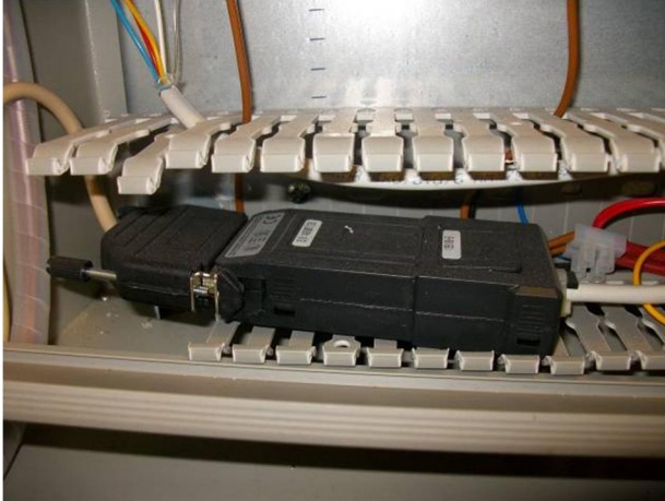
Kuva 48. Alakeskusten välinen väylä on toteutettu mikromodeemeilla
