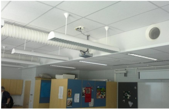
Kuva 19. Luokkien tuloilmalaitteina käytetään suutinkanavia ja poistoilmalaitteena imukartiolla ja suojaverkolla varustettua kanavaa (kuvan oikeassa reunassa).
