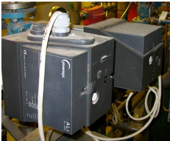
Kuva 50. Uusintaa vaativia Invensys venttiilimoottoreita
