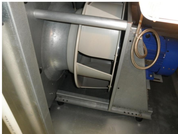
Kuva 6. TK07 tuloilmapuhallin kammioineen on puhdas.
