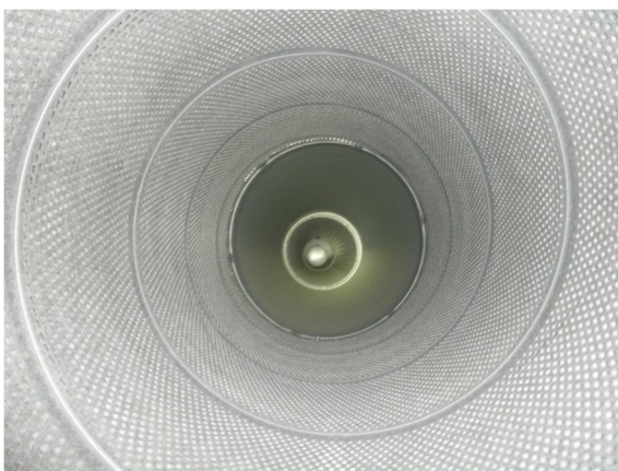
Kuva 23. Tuloilmakanavan (kytkentäkanava) äänenvaimennin on puhdas ja äänenvaimenninmateriaalin pinta suojattu.
