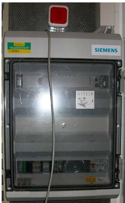
Kuva 47. Siemens alakeskus, jonka toiminnot kannattaa siirtää keskitettyyn automaatiojärjestelmään
