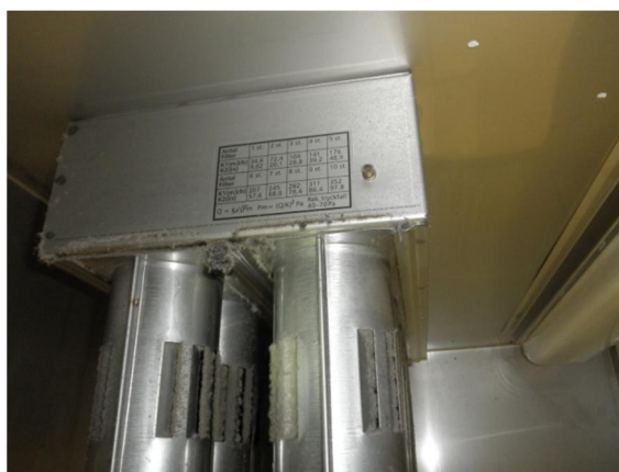
Kuva 26. Huuvien sisällä on rasvanerottimet, joihin oli kertynyt huonepölyä.
