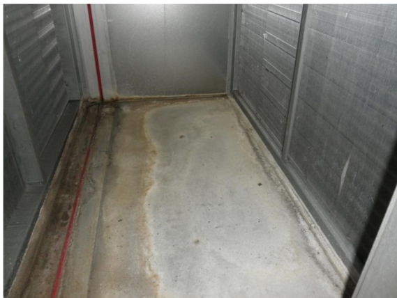
Kuva 5. Vanhoja kastumisjälkiä LTO- ja lämmityspatterien välisessä kammiossa.
