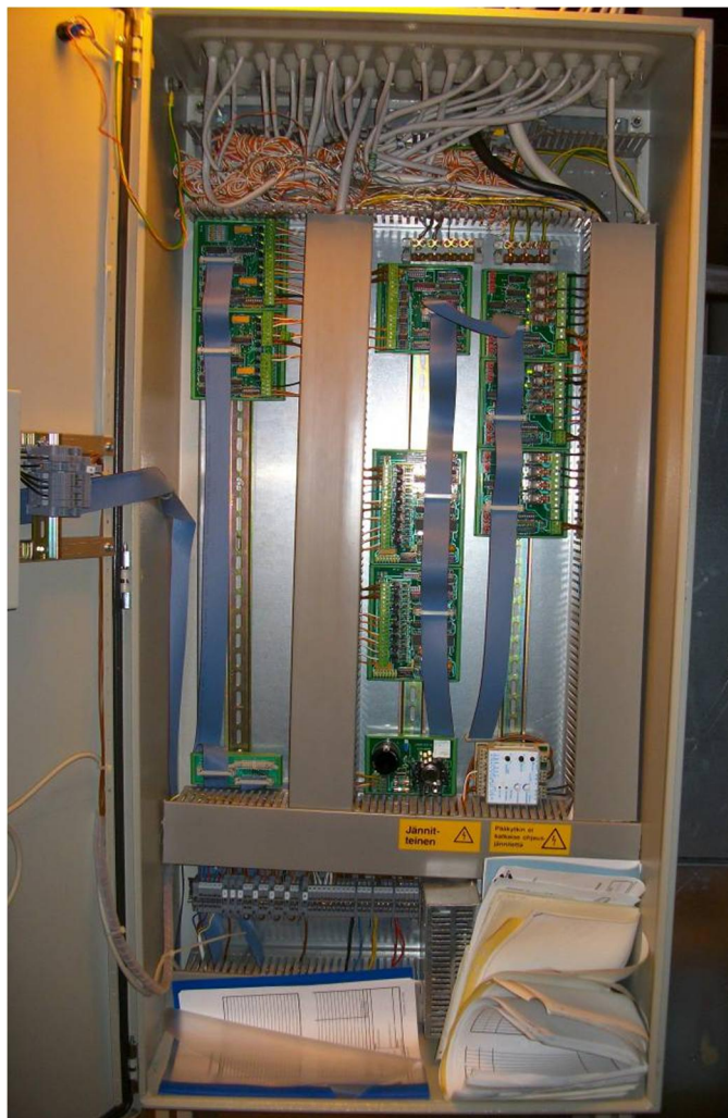
Kuva 45. VAK1 sisältä. Kytkentäkuvat lojuvat kaapin pohjalla ja kourunkansi puuttuu
