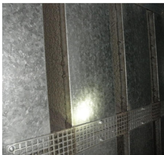
Kuva 15. TK01PF01 äänenvaimennin on lamel-livaimennin, jossa on runsaasti pölykertymää.
