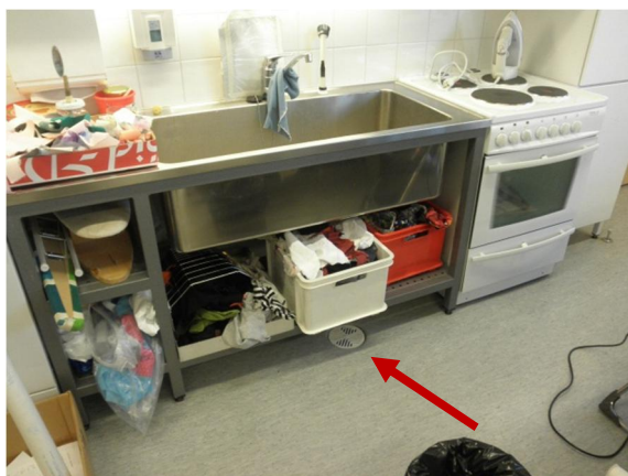
Kuva 34. Tekstiilityöluokan 258 lattiakaivo kuivuu, koska pesuallasta ei ole viemäroity sen kautta.
