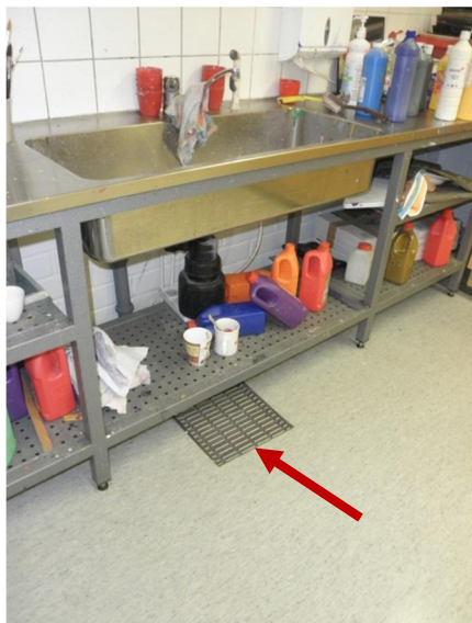
Kuva 33. Kuvaamataidon luokan 143 lattiakaivosta aiheutui hajuhaittaa, vaikka vesilukko ei ollut kuiva.
