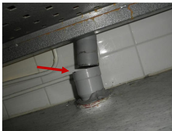
Kuva 35. Pesualtaan viemäri-liitoksesta pääsi viemärikaasuja tekstiilityöluokkaan.
