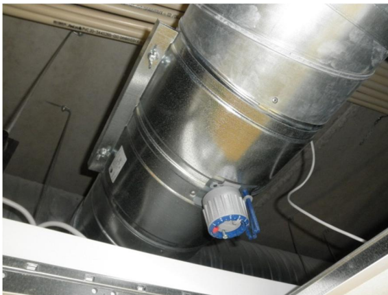
Kuva 21. Luokkien ilmanvaihtokanavien säätöpellit ovat mallia, joka toimii myös puhdistusluukkuna.
