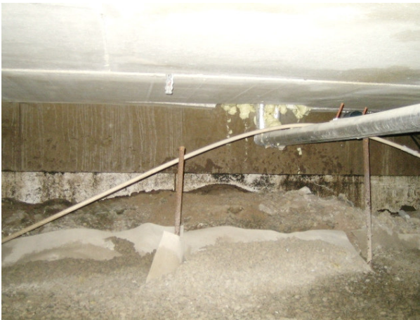
Kuva 3 Alapohjatilassa ei havaittu mitään epänormaalia. Tilassa oli jonkin verran maatuneen puun hajua
