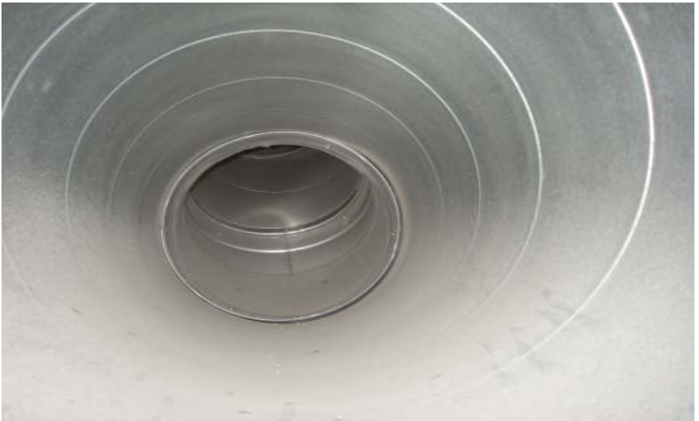
KUVA 10. Poistoilmakanavissa on hieman pölykertymää.
