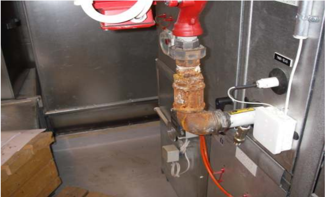
KUVA 3. Lämpöpatterin putkiliitokset ovat vuotaneet.
