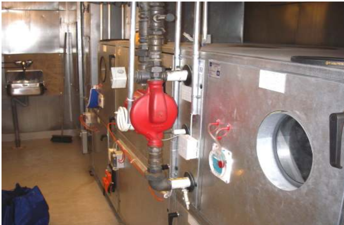
KUVA 1. Yleiskuva IV- konehuoneesta.
