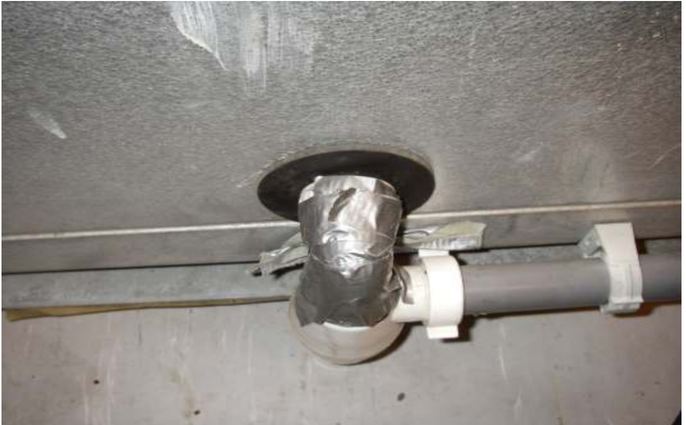
KUVA 5. Ilmastointikoneen vesilukko on rikki.
