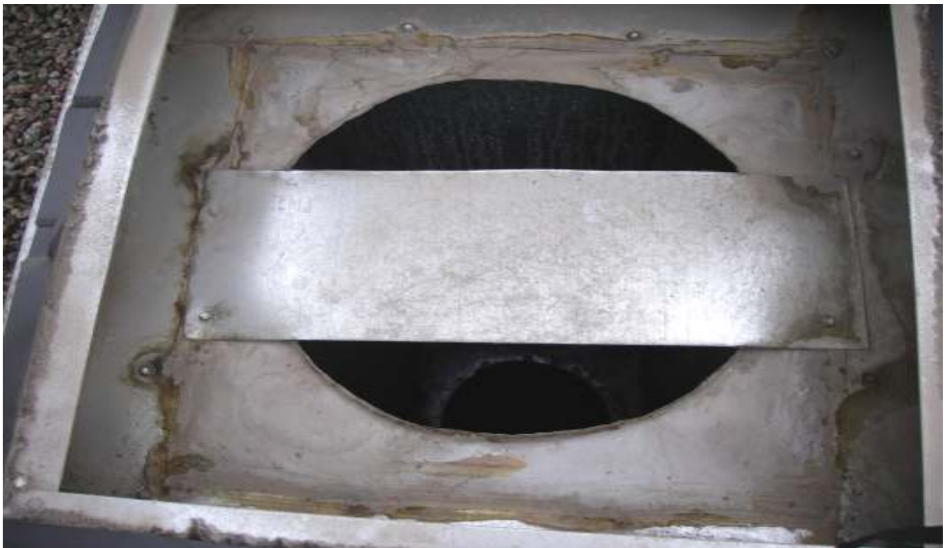
KUVA 8. Poistoilmakanavaa on supistettu.
