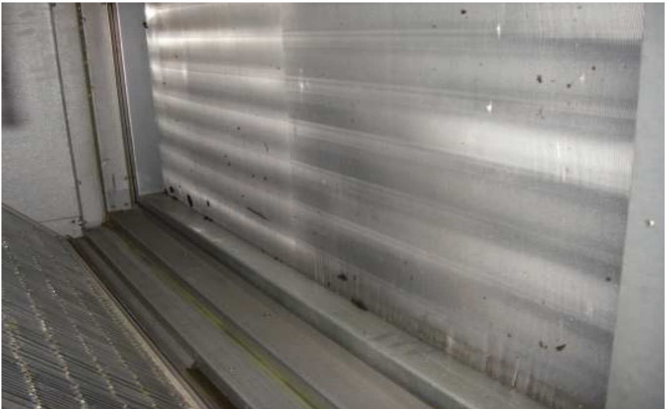
KUVA 6. Lämmityspatterissa on hieman roskaa.
