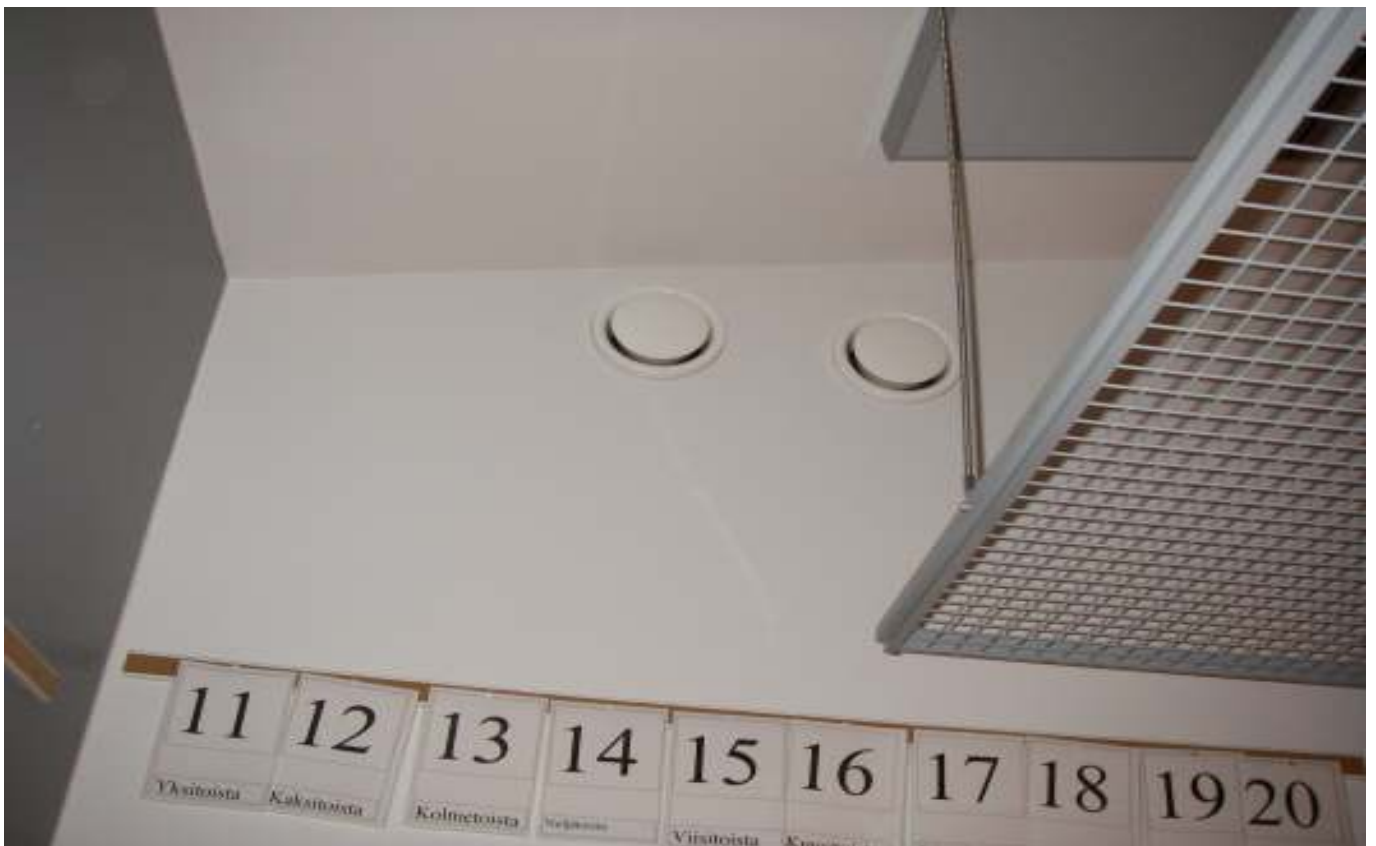
KUVA 14. Yleiskuva poistoilman pääte-elimistä.
