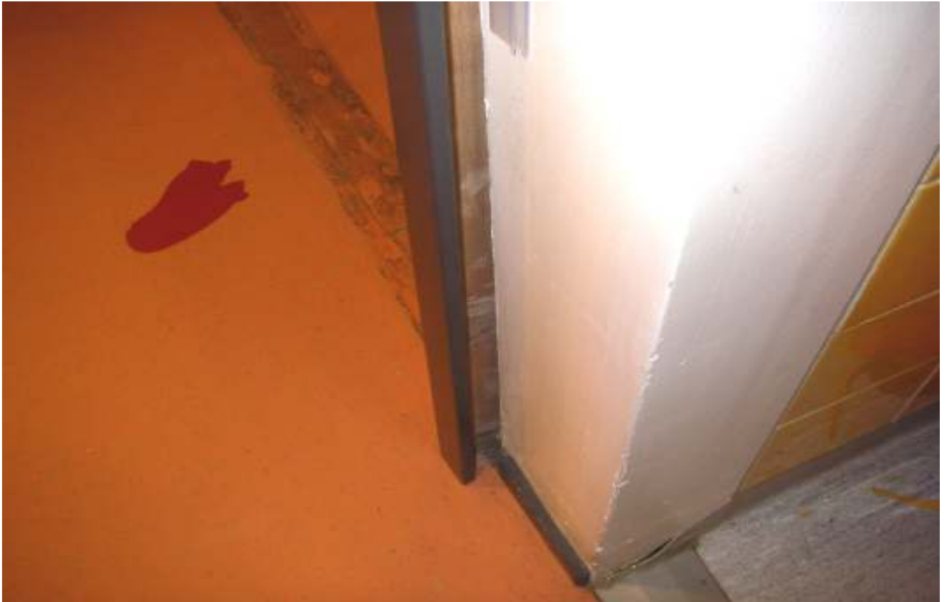
KUVA 17. Leikkihuoneen n:o 1.45 ovenkarmi on irti.
