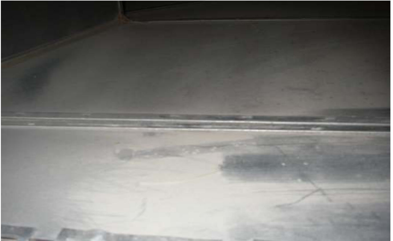
KUVA 9. Poistoilmakanavissa on hieman pölykertymää.
