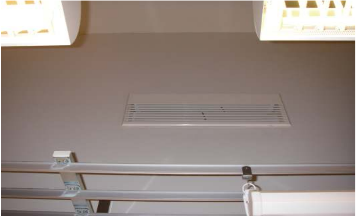
KUVA 13. Yleiskuva tuloilman pääte-elimistä.
