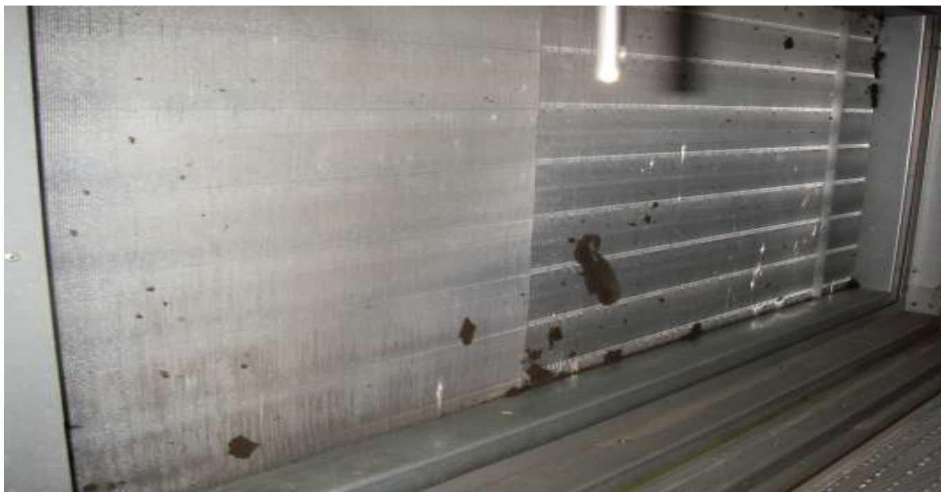
KUVA 2. Lämmityspatterissa on hieman roskaa.
