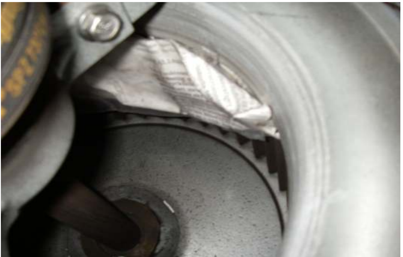
KUVA 4. Tuloilmapuhaltimessa oli paperia ja puhallin on pölyinen.
