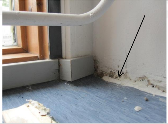
Kuva 13. Lattian ja seinän liitoksen epätasaisista tiivistystä massalla lattialistan takaa
