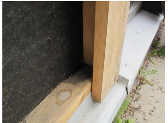
Kuva 20. Kosteusjälkiä ikkunan alapuolisen rakenteen ilmaraossa.
