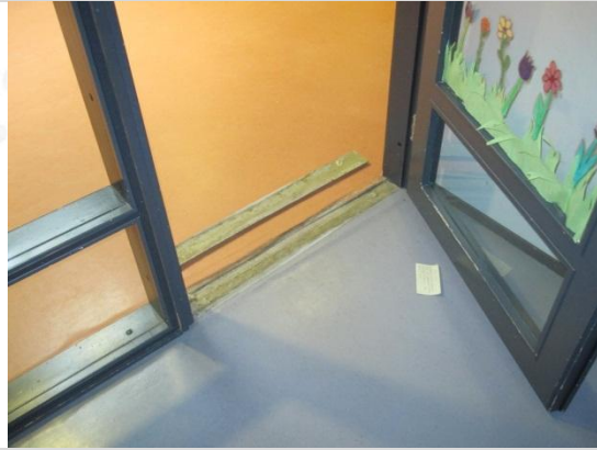
Kuva 15. Kynnyksen kohta (RT9)
