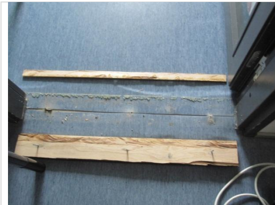
Kuva 11. Kynnyksen kohta (RT7)
