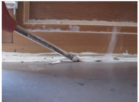
Kuva 18. Merkkisavu osoittaa, että korvausilmaa tulee huoneeseen päin tiivistysmassan takaa.
