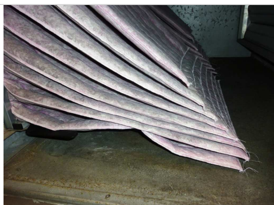
Kuva 4. Tuloilmasuodattimet ovat väärässä asennossa.
