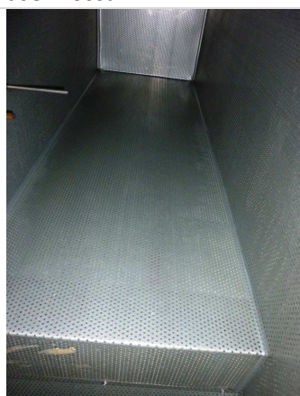
Kuva 6. Äänenvaimennuskammiossa on reikälevyn alla mineraalivillaa.
