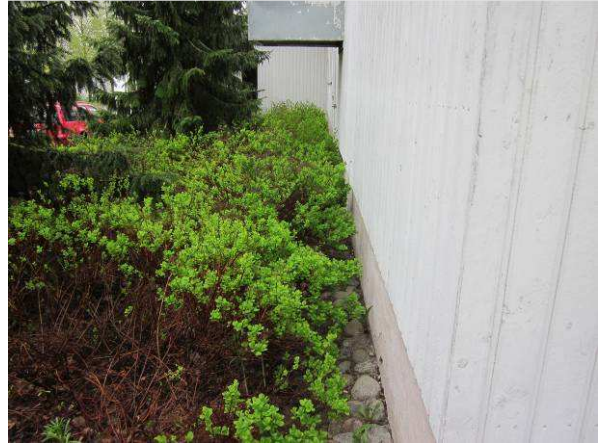
Kasvillisuus aiheuttaa ylimääräistä kosteusrasitusta ulkoverhoukselle ja perustusrakenteille
