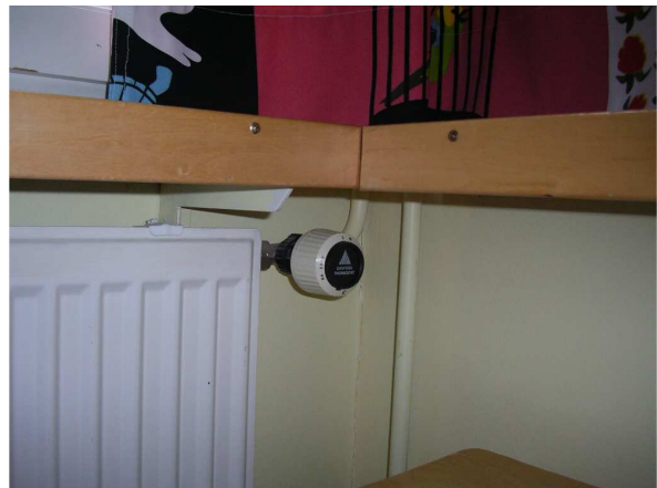
Patteriventtiilit ovat rakennuksen alkuperäisiä.
