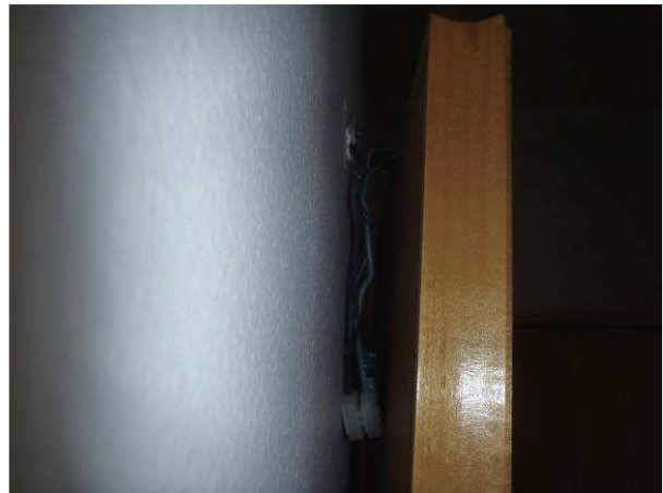
Poistetun keskuskellon johdotus tulee päättää asianmukaisesti.
