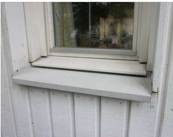
Ikkunapellitykset on toteutettu puutteellisesti
