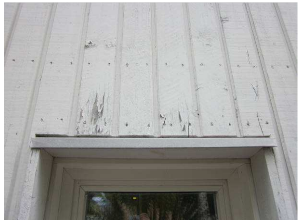
Maalipinnoite hilseilee ikkunan yläpuolella
