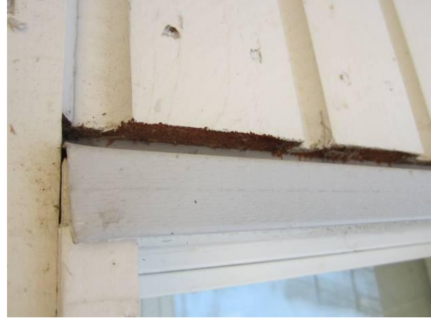
Kuva 16 Ikkunan yläreunan vesipellin yläpuolella ei lautojen päitä ole maalattu.
