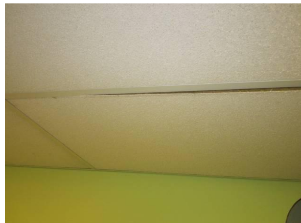
Kuva 40 Alakattolevy roikkui paikaltaan.
