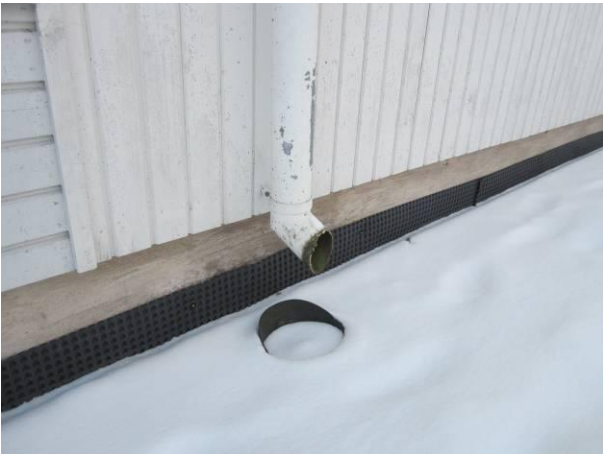
Kuva 5 Patolevyt leikkaamatta, rännivedet suuntautuvat osin ohi kaivon.
