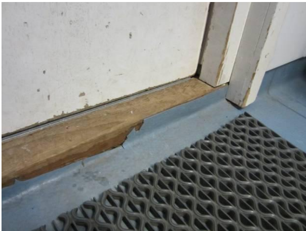
Kuva 13 Rikkoutunut muovimatto TK 43.
