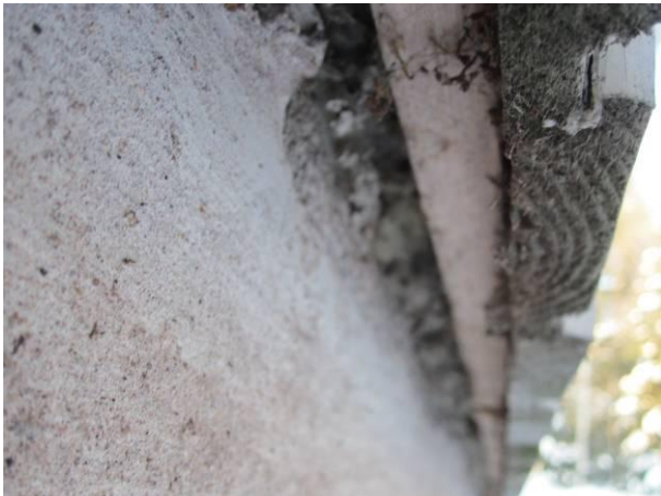
Kuva 17 Lautojen alapäitä ei ole viistetty ja maalaus on heikkolaatuinen. Tuuletusta ei juuri tapahdu.
