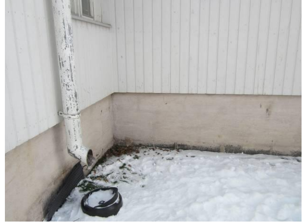
Kuva 4 Sisänurkassa maanpinnan painuma.
