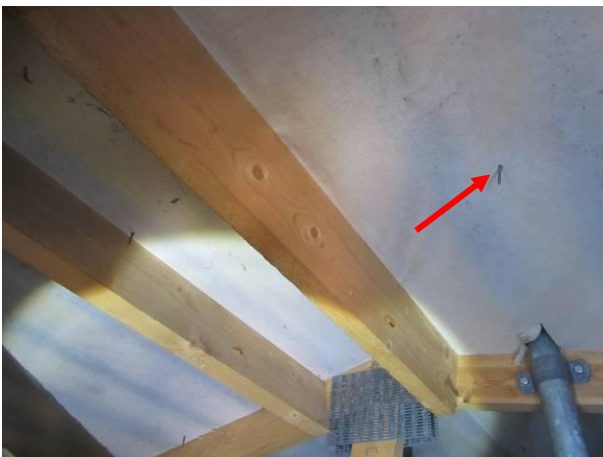
Kuva 29 Rivipeltikatteen kiinnikkeiden nau-laukset lävistävät aluskatteen.
