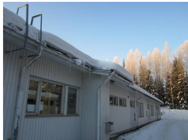
Kuva 26 Keittiön kohdalla runsaammin jääpuikkoja.
