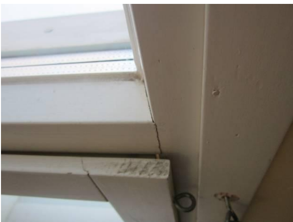
Kuva 21 Sisempi tiiviste puuttuu.
