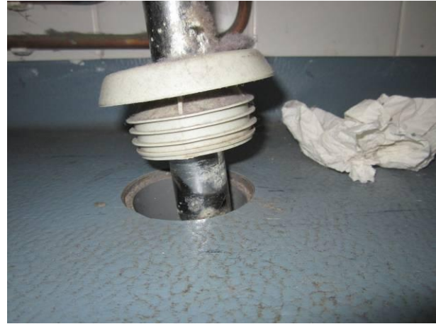
Kuva 12 Pesutila 36 lavuaarin poistoputken liitoslaippa oli irti.
