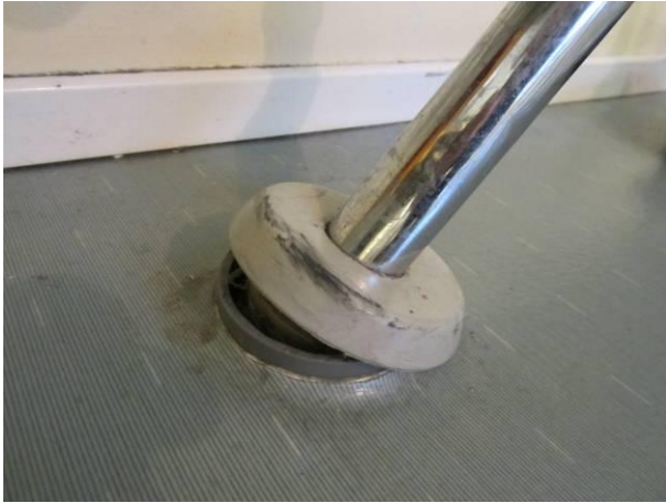
Kuva 11 Ryhmätilan lavuaarin poistoputken liitoslaippa oli irti.
