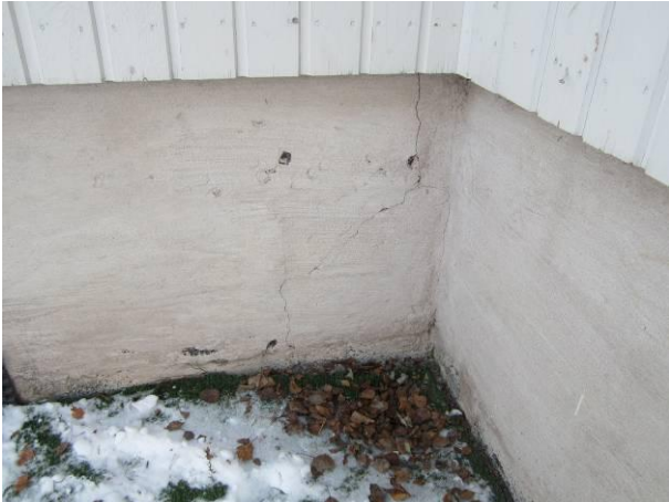
Kuva 7 Sokkelin halkeama sisänurkassa
