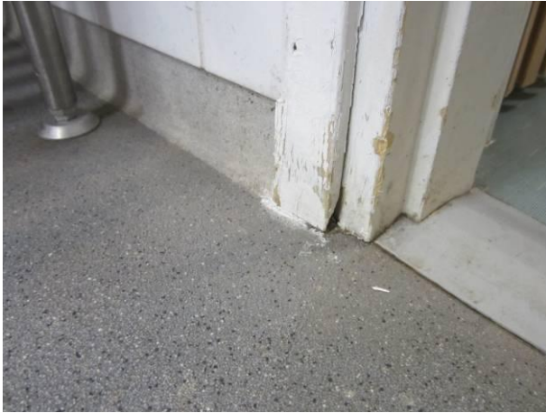
Kuva 31 Keittiön ovikynnys on matala.
