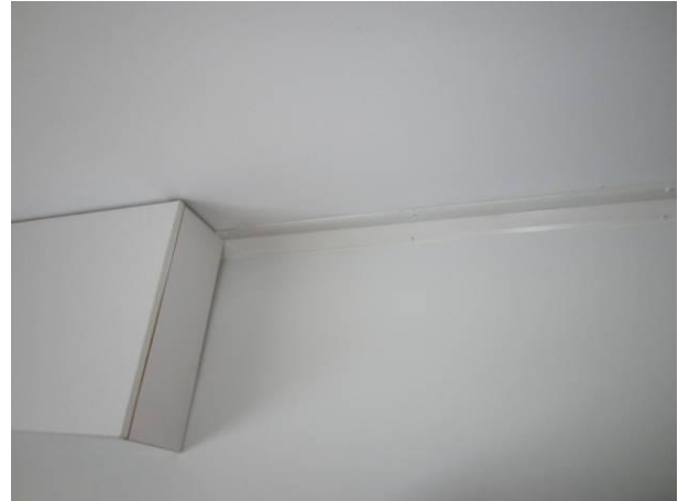
Kuva 20 Terv.hoito 26 väliseinän yläosaan on asennettu L-pelttilista. Tästä joku väitti tulleen vettä vesikattorungon painumisen aikana.
