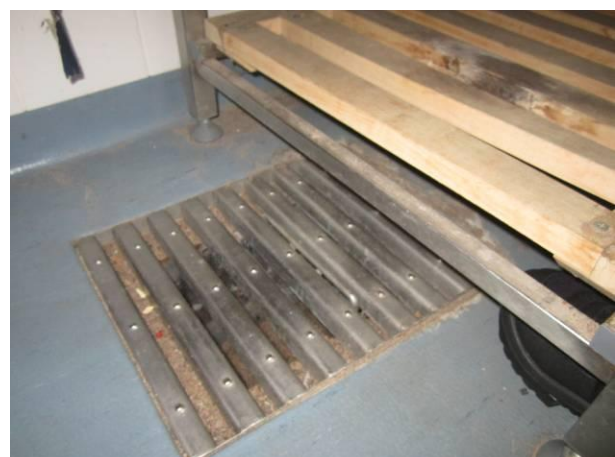
Kuva 36 TK/ Märkäeteisen kaivo.
