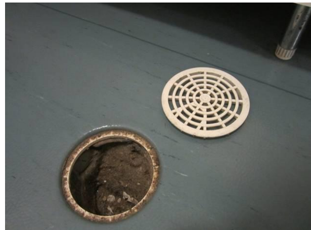
Kuva 34 Pesutilan valurautainen lattikaivo.
