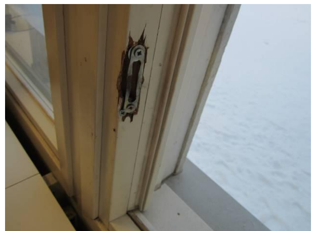
Kuva 22 Vastalevyt ovat taipuilla, koska salpaa on väännetty väkisin.
