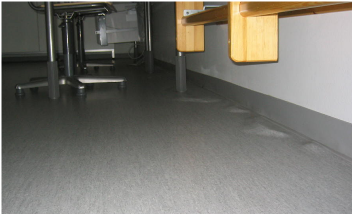
Kuva 6. Tilan 2311 ulko-oven puoleisella ulkoseinustalla puolapuiden kohdalla oli lattianpäällysteessä kupruilua.
