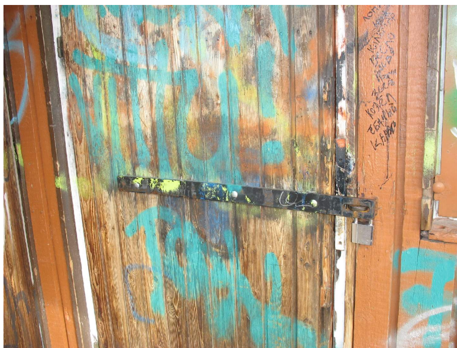
Kuva 6. Urheiluvälinevaraston ovi, oven runko on "pettänyt" ja runko on vääntynyt salmiakiksi. Kyseisen oven avaaminen ilman työkaluja ei onnistunut.
