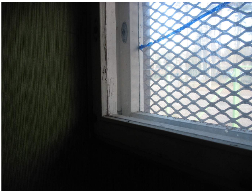
Kuva 12. Pesuhuoneen ikkunat. Puupuitteisia kaksilehtisiä sisäänaukeavia ikkunoita. Sisäpuolen puitteessa havaittavissa maalipinnan lohkeilua. Lohkeilu johtunee tilan kosteusrasituksesta.
