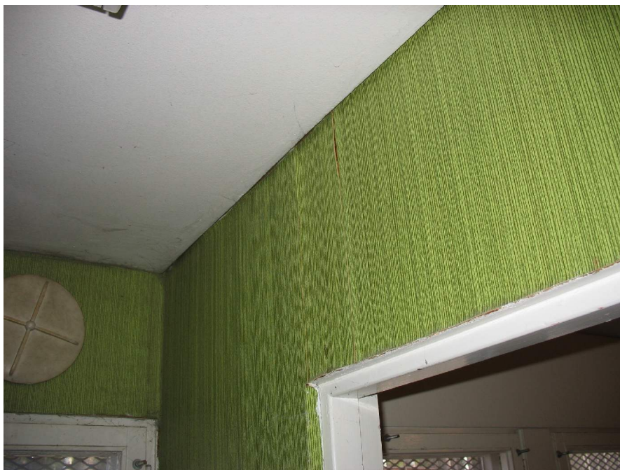
Kuva 11. Toisen pukuhuoneen muovitapetin saumat ovat auenneet. Sauman välistä katsottuna lastulevyn pinnassa ei näytä olevan muuta vesieristettä.
