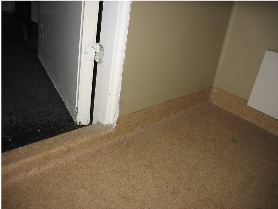
Kuva 13. Toisen pesuhuoneen ovenkarmi ja ovenalaosassa on alkavaa vedenaiheuttamaa puupinnan vaurioitumista.
