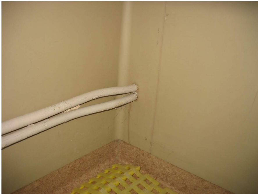
Kuva 14. Pesuhuoneen putkiläpiviennit seinän vesieristeenä toimivan muovitapettiin on tiivistämättä. Tämä kyseinen kohta on lähellä suihkua, joten on ilmeistä että tässä on todennäköinen vuotokohta seinärakenteen sisään ja alapohjarakenteisiin.
