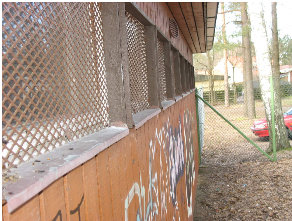
Kuva 5. Pohjoissivu. Ikkunapellit ovat kauttaaltaan puutteellisesti kallistettu. Pukuhuoneen korvausilmasäleikkö on repsotta lähes irti.
