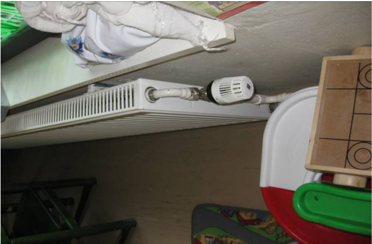
LVI-kuva 1. Yleiskuva patteriventtiileistä.
