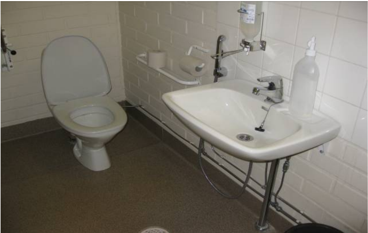
LVI-kuva 3. Yleiskuva vesi- ja viemärikalusteista.
