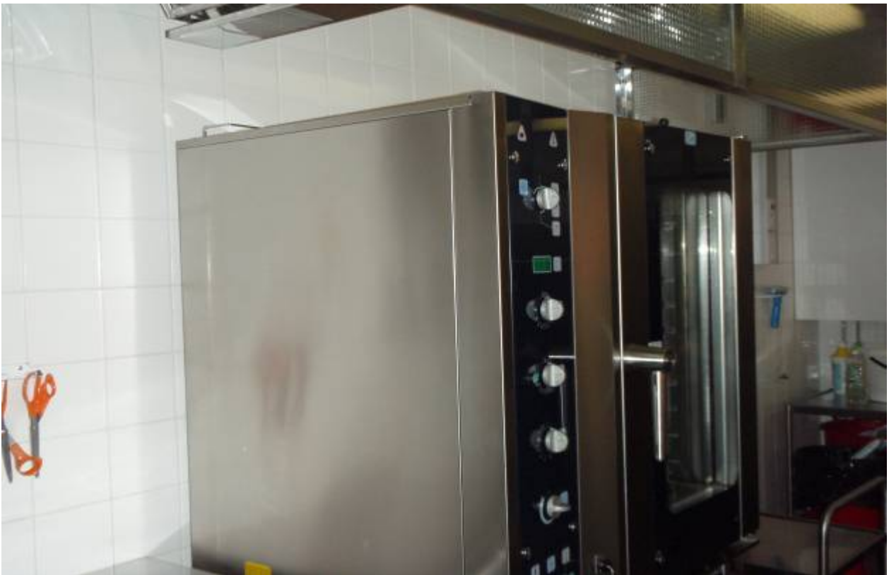
S-KUVA 12. Keittiön laitteet
