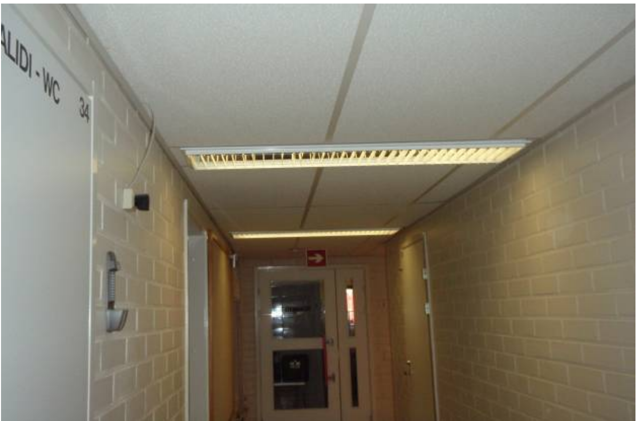
S-KUVA 6. Käytävän valaistus
