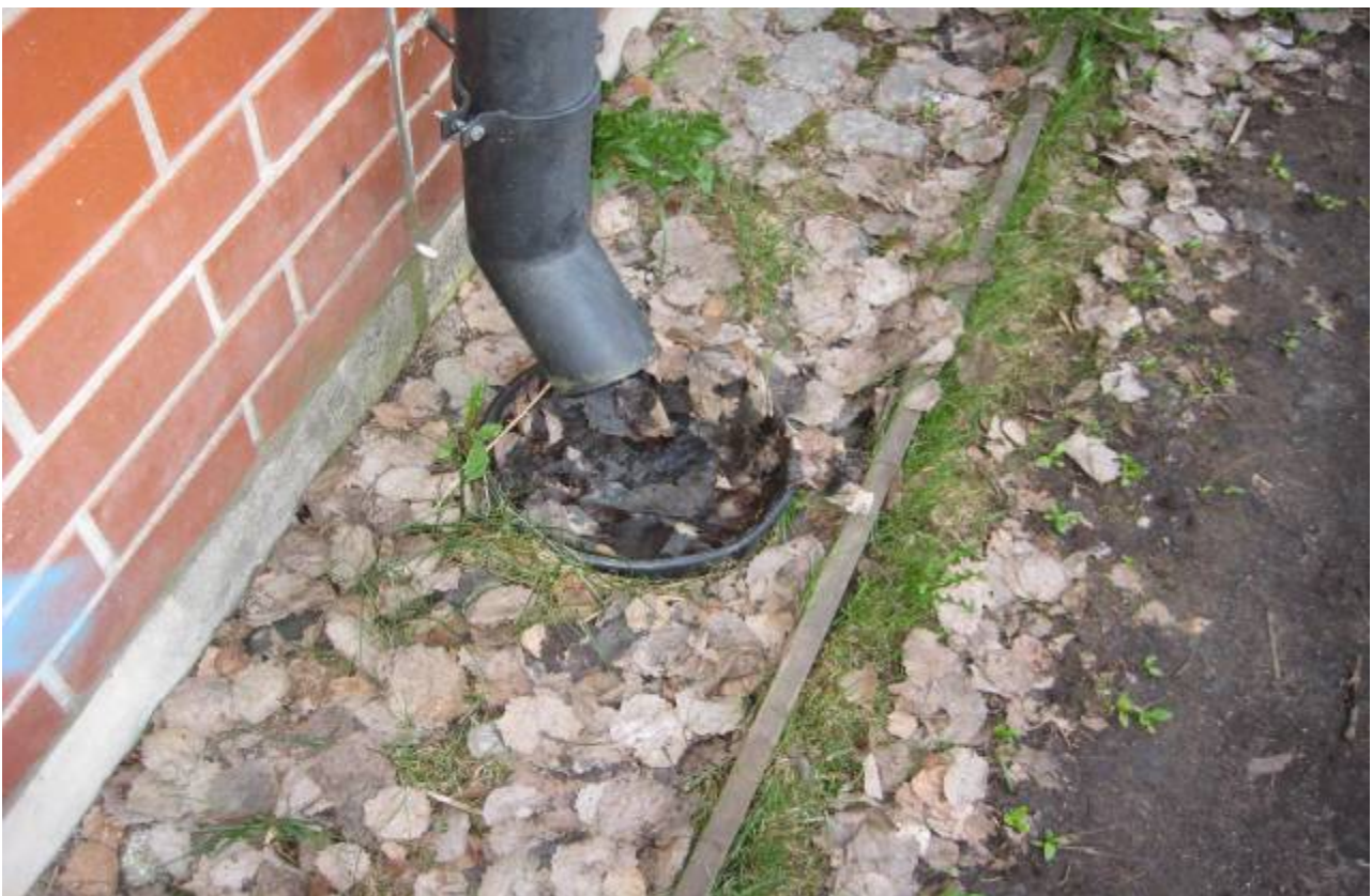
RAK-KUVA 4: Lehdistä tukkeutunut sadevesisuppilo.
