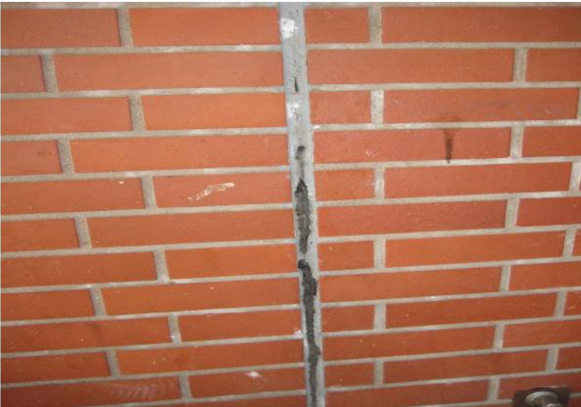
RAK-KUVA 6: Julkisivusaumoissa esiintyi paikoin mekaanisia vaurioita (ilkivalta)
