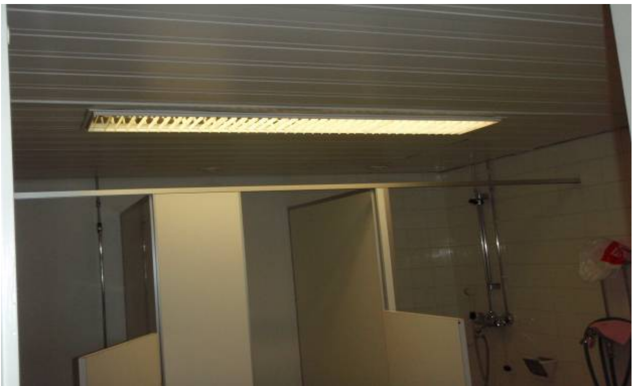
S-KUVA 8. WC- tilojen valaistus
