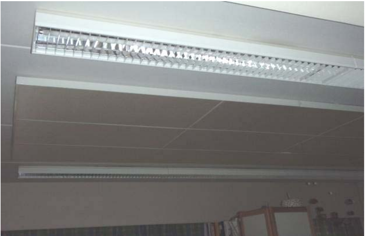
S-KUVA 5. Huoneiden valaisimet
