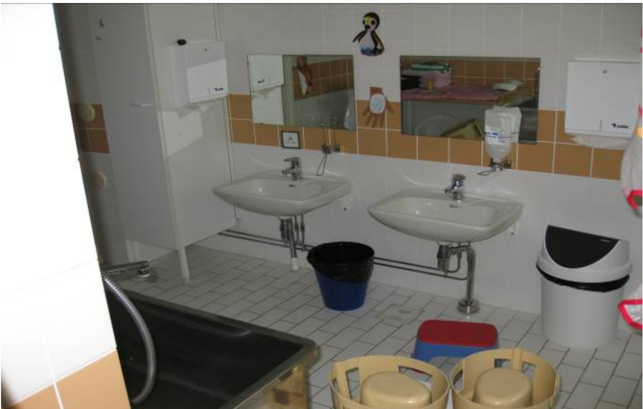
LVI-kuva 2. Yleiskuva vesikalusteista.
