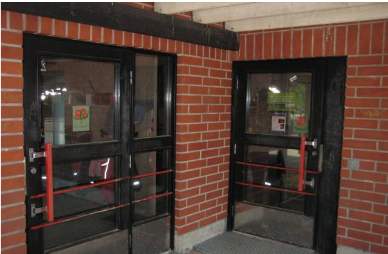
RAK-KUVA 8: Ulko-ovirakenteet arvioitiin edellyttävän kunnostustoimenpiteitä.
