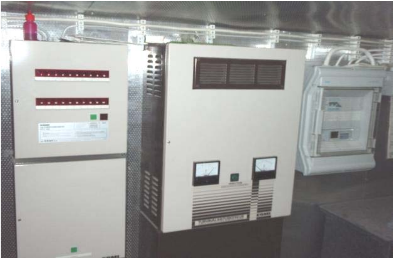
S-KUVA 13. Ovimerkkivalaistuksen keskus ja LVI- hälytyskeskus
