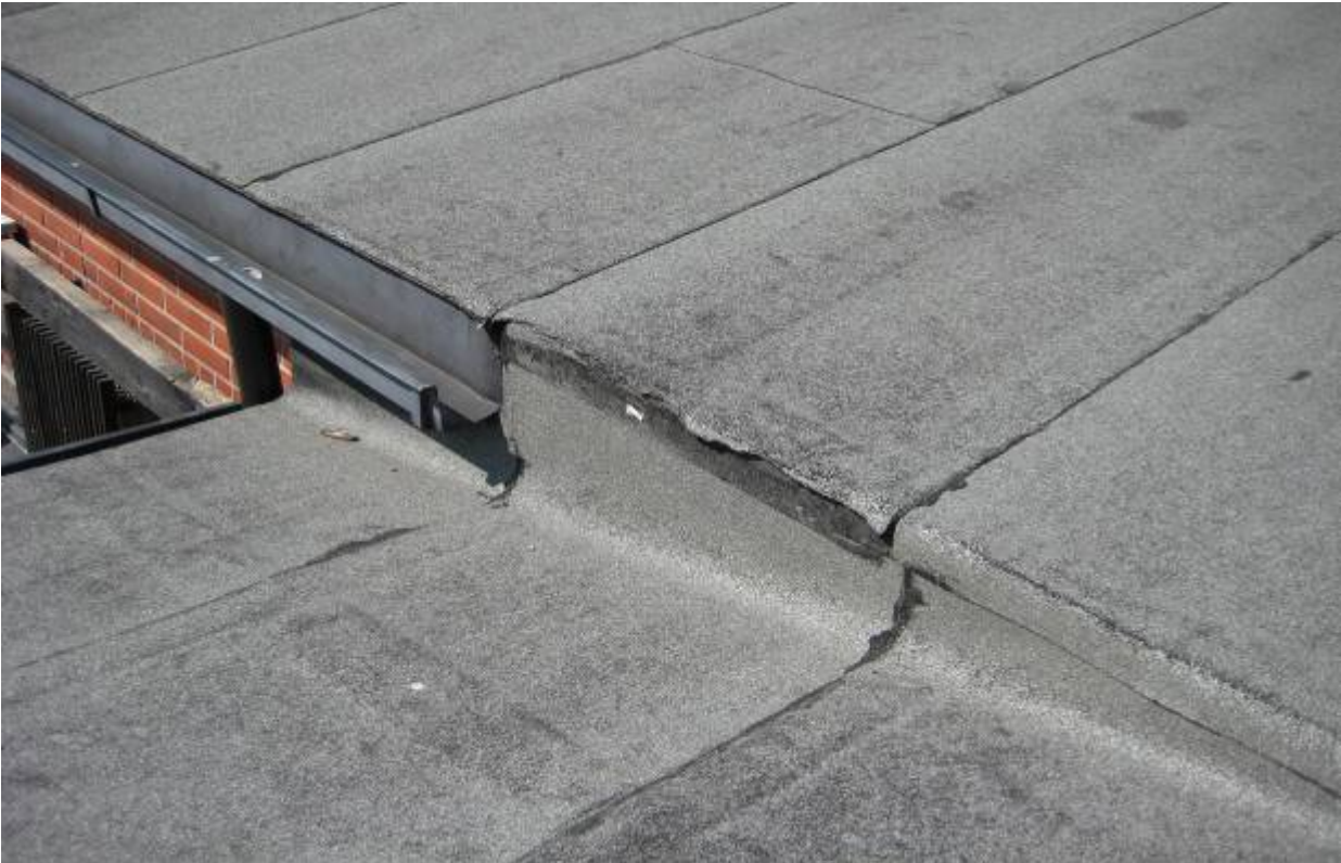
RAK-KUVA 9: Katehuovassa esiintyi yksittäisiä vaurioita (kuvassa reunan huopa revennyt).
