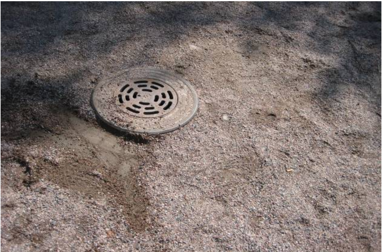
RAK-KUVA 3: Sadevesikaivon kansirakenne on koholla ympäröivästä maanpinnasta.
