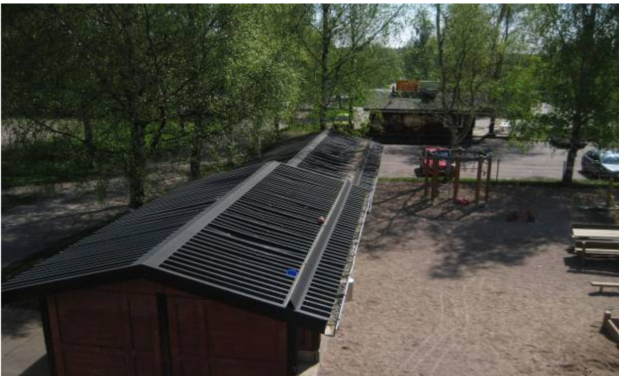
RAK-KUVA 2: Ulkovaraston katerakenteella mekaanisia vaurioita.
