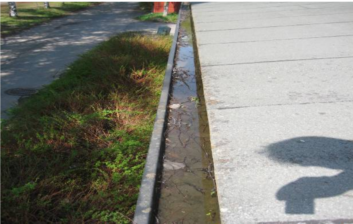
RAK-KUVA 10: Räystäskoururakenteiden puhdistukseen tulee kiinnittää nykyistä enemmän huomiota.
