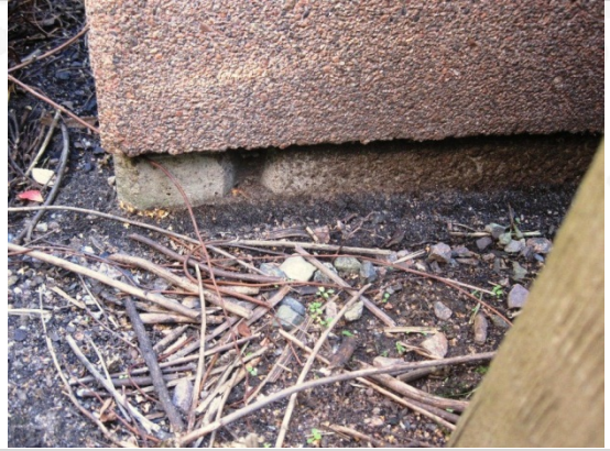
Kuva 11. Ulkoseinäelementin vaakasauma on lähes maanpinnan tasolla.
