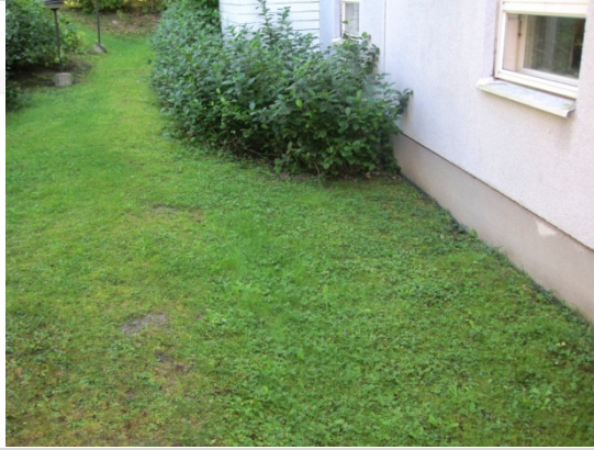
Kuva 10. Kasvillisuus on kiinni sokkelissa.
