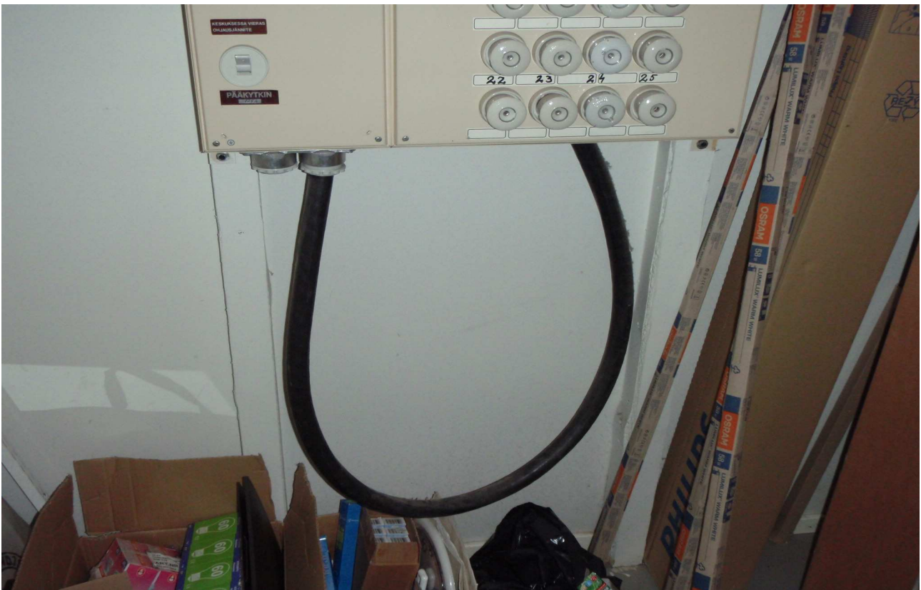
S- kuva 5. RK1 keskus, syöttökaapeli on irti.
