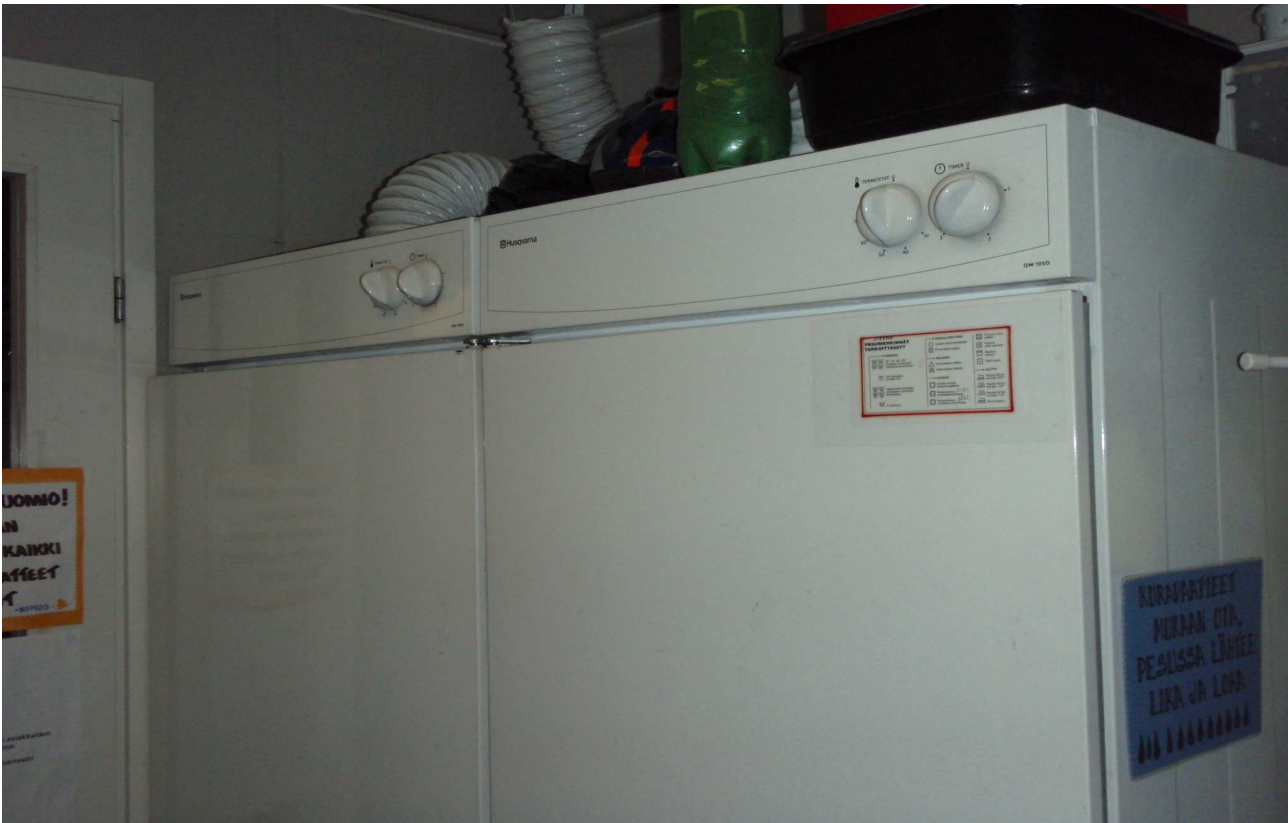
S- kuva 12. Kuivauskaapit.
