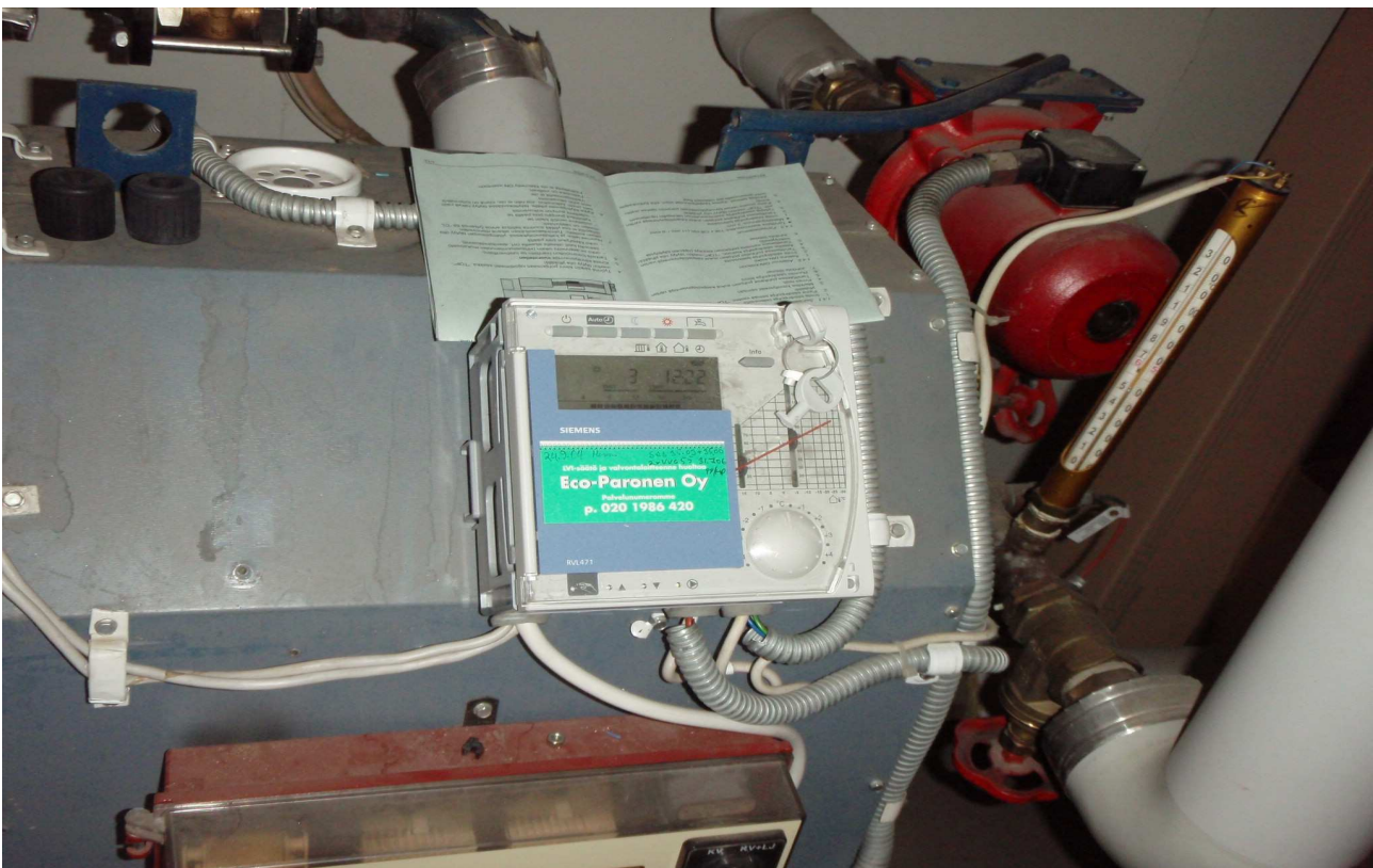
S- kuva 15. Lämmönjaon yksikkösäädin.
