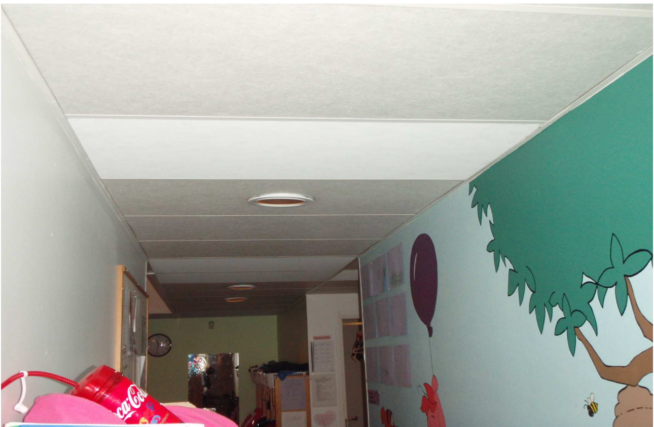
S- kuva 7. Käytävän valaistus.
