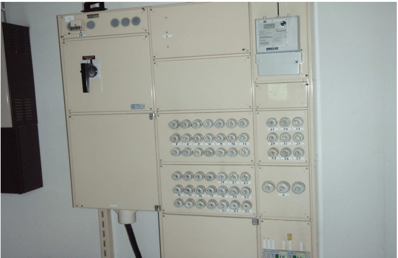
S- kuva 3. Sähköpääkeskus.
