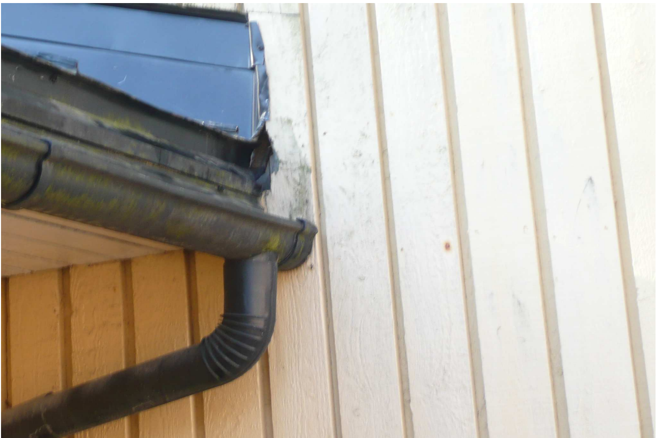
RAK- kuva 4. Räystäiden ja ulkoseinien liittymässä on rakoja.
