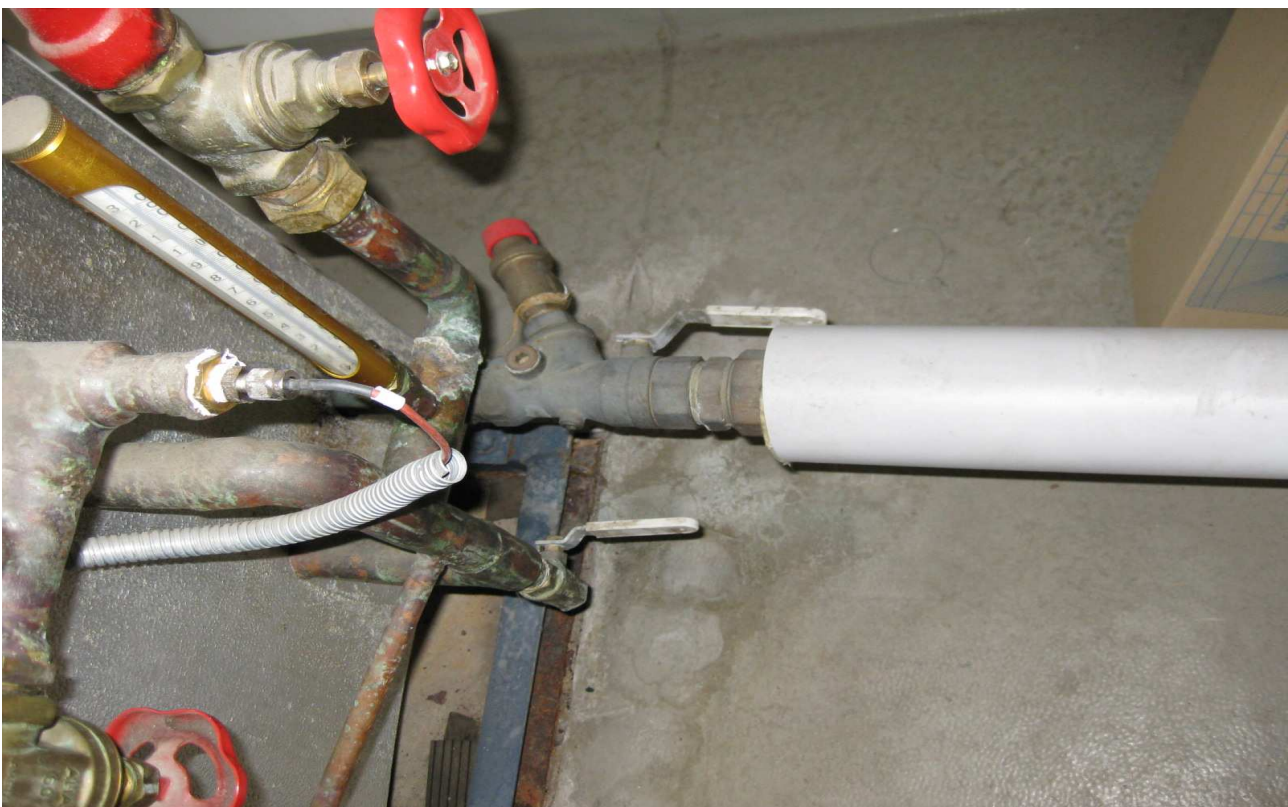
LVI- kuva 5. Yleiskuva käyttöveden sulkuventtiileistä.
