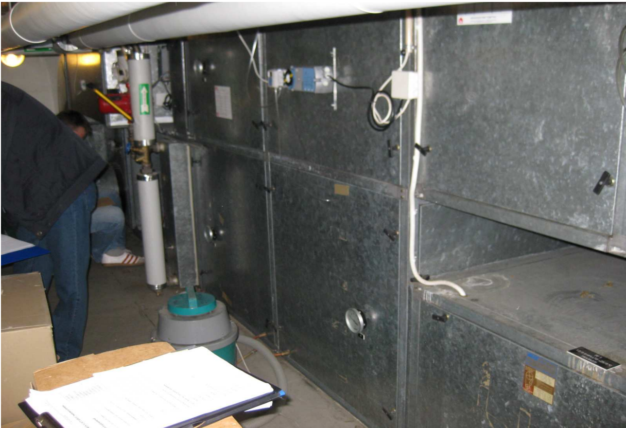
LVI- kuva 8. Yleiskuva IV- konehuoneesta.
