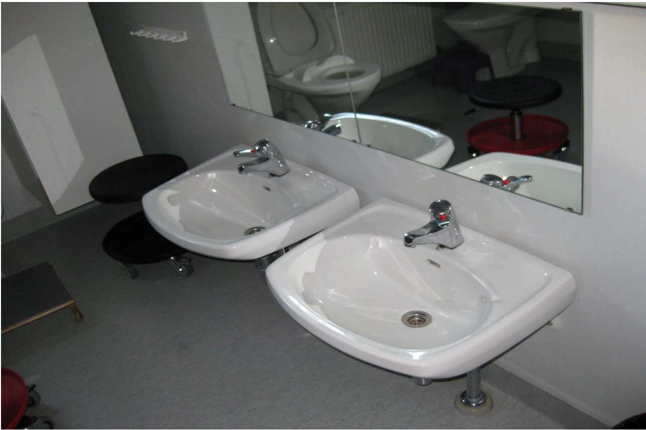
LVI- kuva 6. Yleiskuva vesikalusteista.
