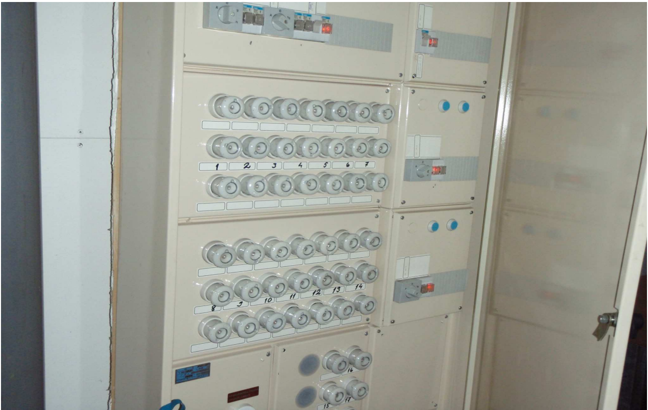
S- kuva 4. IV- konehuoneen keskus.
