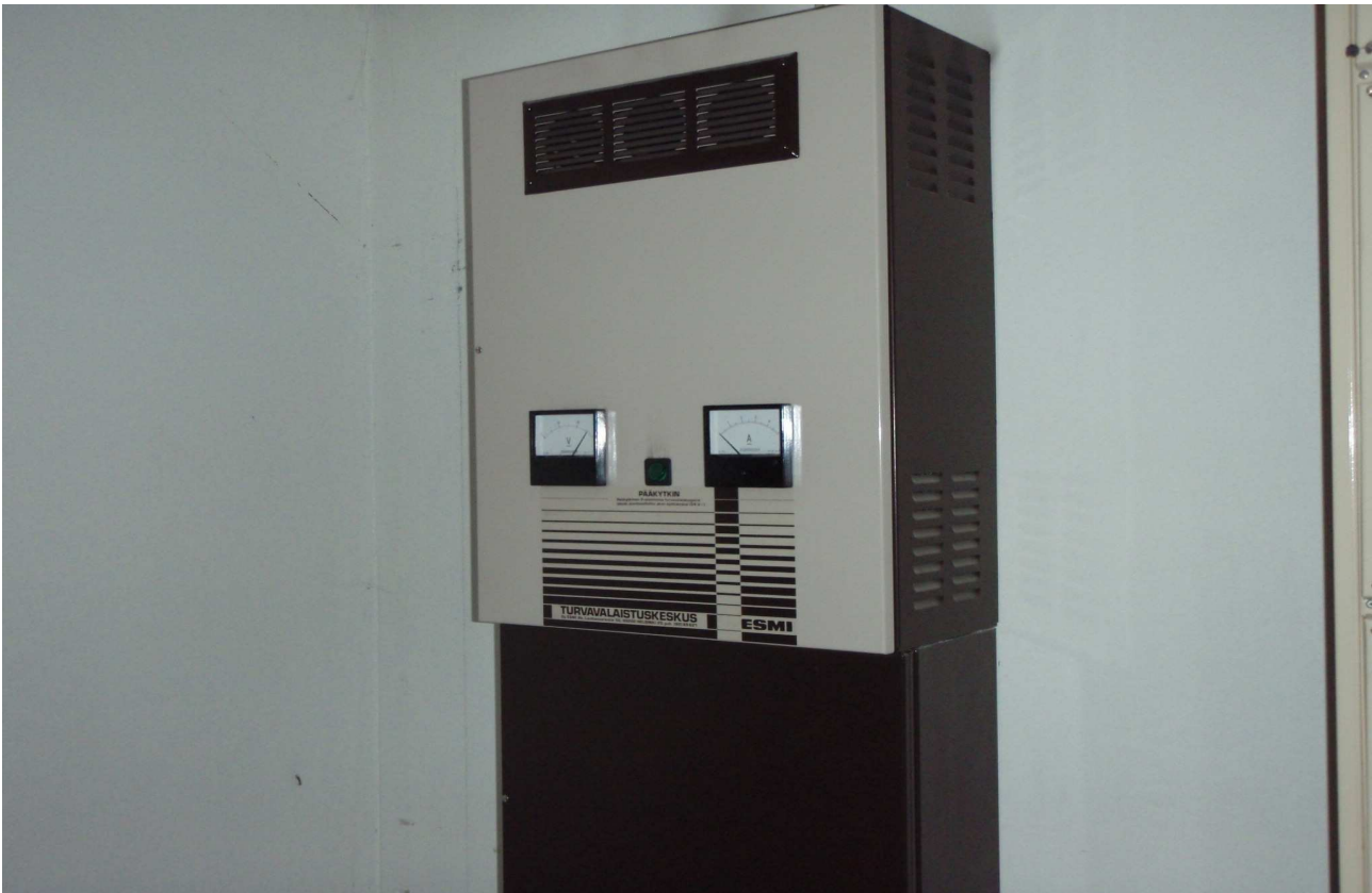
S- kuva 14. Ovimerkkivalaistusjärjestelmän keskus.
