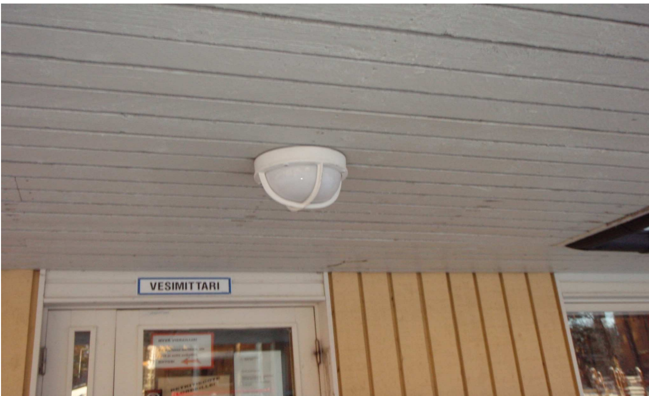
S- kuva 1. Sisäänkäynnin valaistus.
