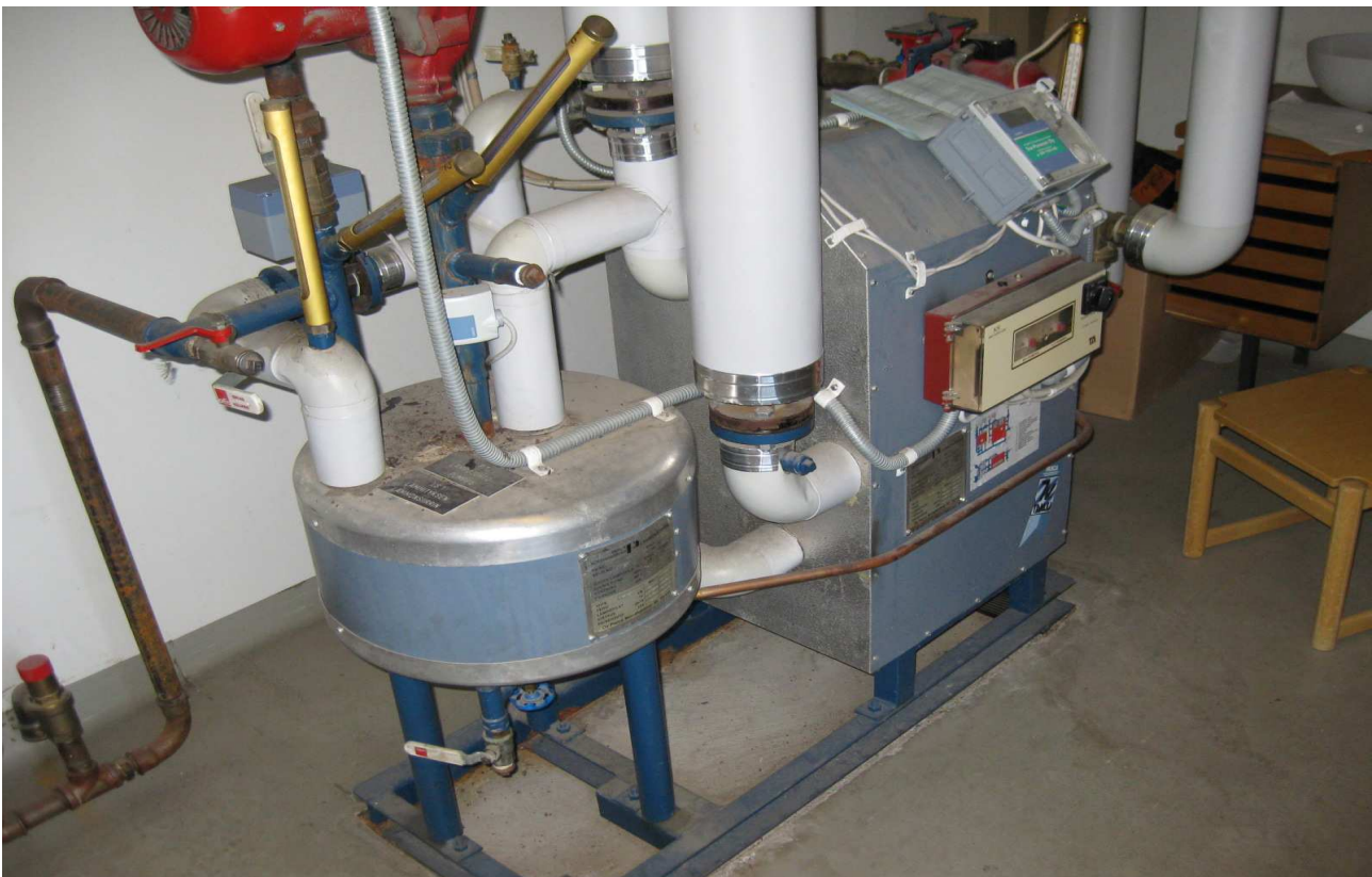
LVI- kuva 1. Yleiskuva lämmönjakuhuoneesta.
