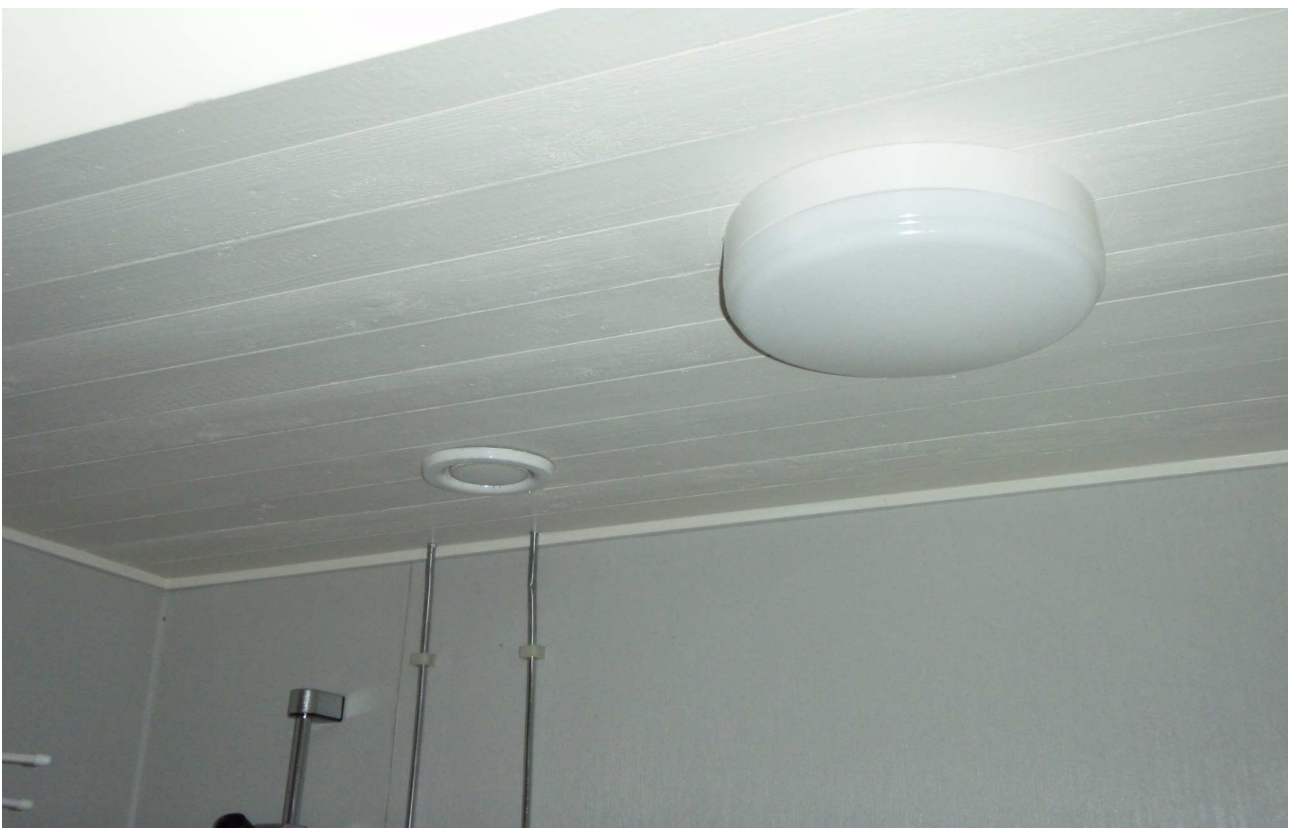
S- kuva 9. WC- tilojen valaistus.
