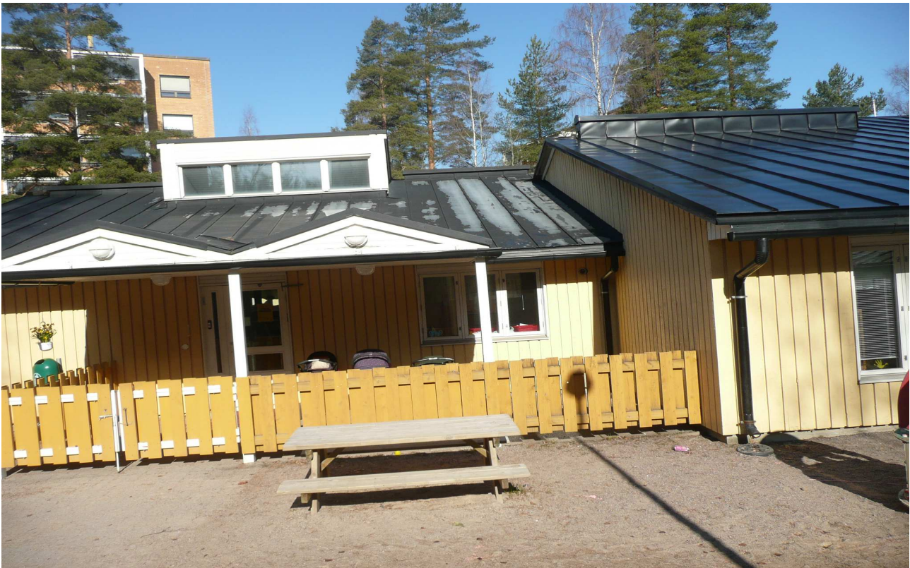
RAK- kuva 3. Vesikaton maalipinta hilseilee paikoitellen melko voimakkaasti.
