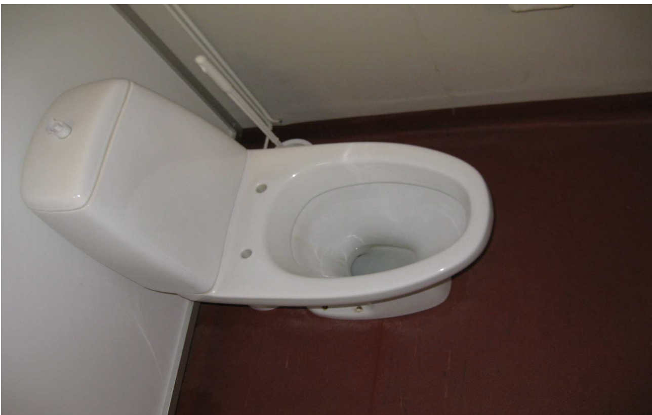
LVI- kuva 7. Yleiskuva vesikalusteista.
