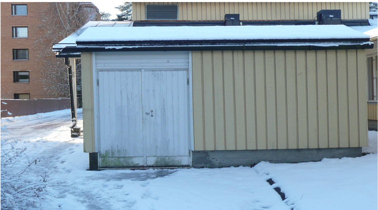
RAK- kuva 2. Varaston maalipinnassa on värvaihteluja ja pinnan tummumista.
