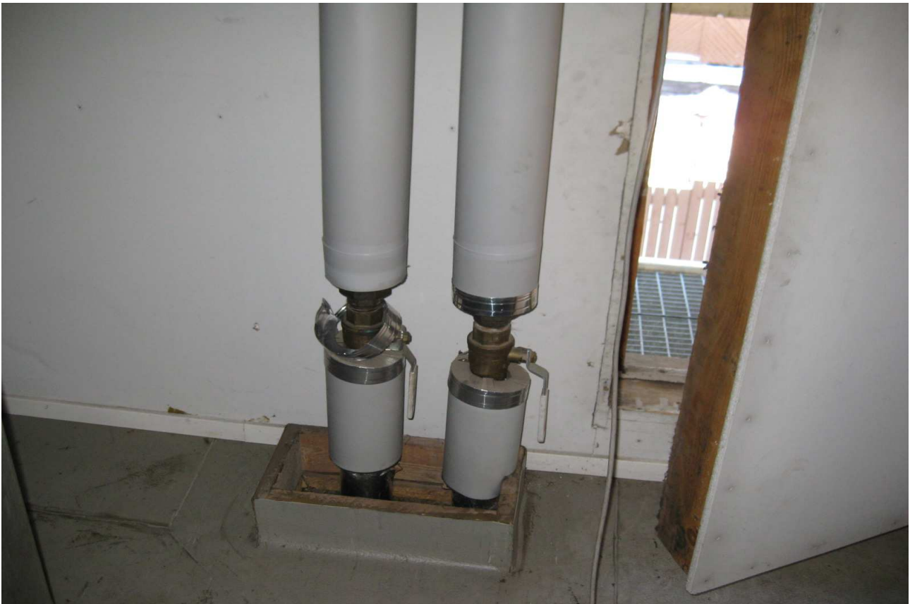
LVI- kuva 2. Yleiskuva lämpöjohtoverkoston venttiileistä.
