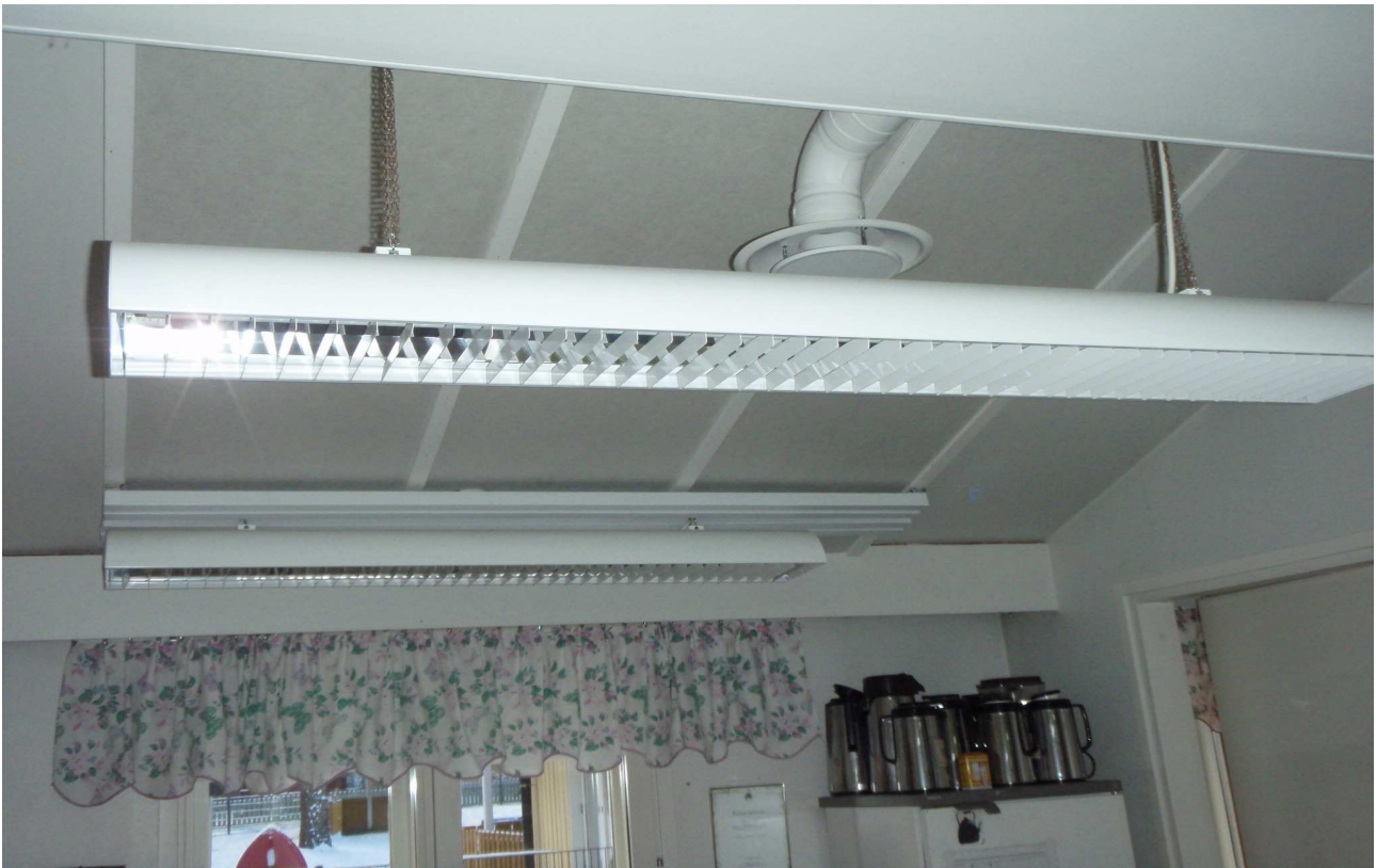
S- kuva 6. Huoneiden valaisimet.
