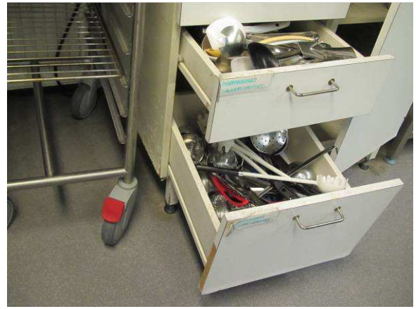
Keittiön kiintokalusteet ovat ikääntyneitä ja kuluneita
