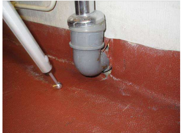
Viemärin ja maton liitos ei ole tiivis
