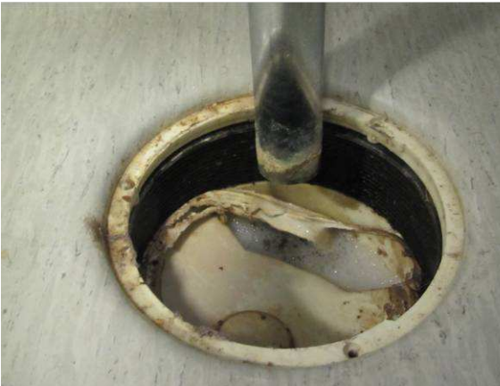
Joidenkin lattiakaivojen ympärillä havaittiin kohonneita kosteuspitoisuuksia, korokerenkaan tiiveys?
