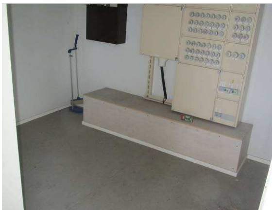
Sähköpääkeskuksen oven edustalla havaittiin kohonneita kosteuspitoisuuksia
