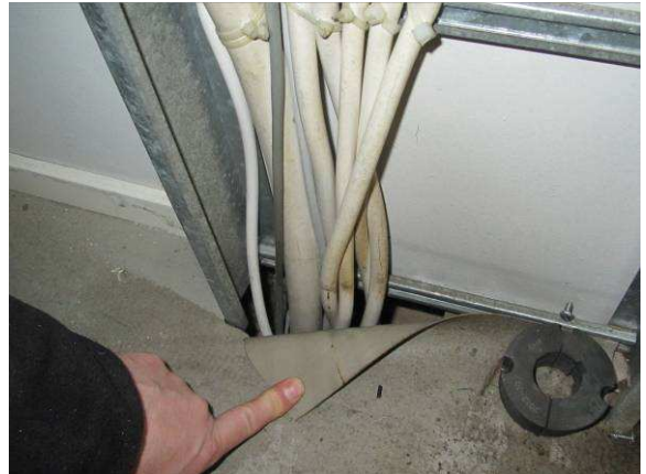
IV- konehuoneen lattiamatossa ei ole ylösnostoja, läpiviennit ovat tiivistämättä
