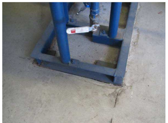
Lämmönvaihtimen alla ei ole muovimattoa, muovimaton saumoissa havaittiin muualla epätiivieyskohtia
