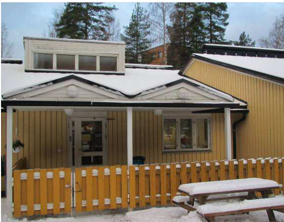
Rakennuksien päädyissä on olemattomat räystäät
