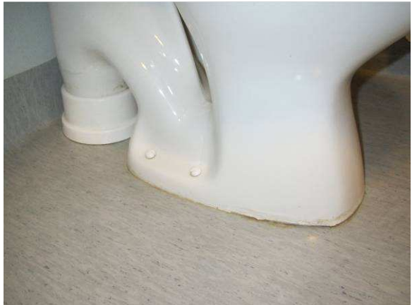
Joidenkin wc-istuimien ympärillä havaittiin kohonneita kosteuspitoisuuksia, liitoksia on tiivistetty silikonilla
