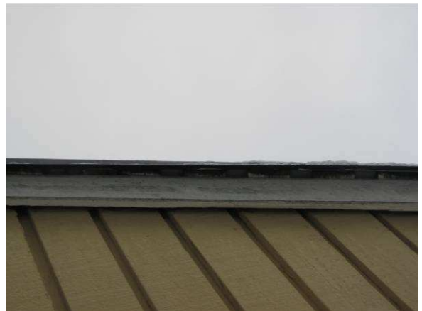
Vettä pääsee myrskysateella sisään räystäsrakenteesta, sisäpuolella lämmönjakohuoneessa havaittiin kohdassa vuotojälkiä ja kohonnutta kosteutta
