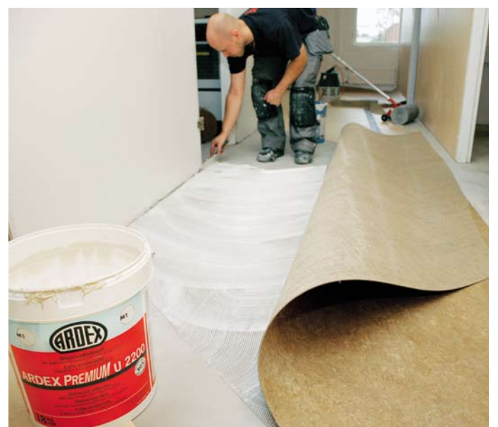
Muovipäällysteet ja linoleumit kiinnitetään ARDEX PREMIUM M1-luokitellulla päällysteliimoilla.
