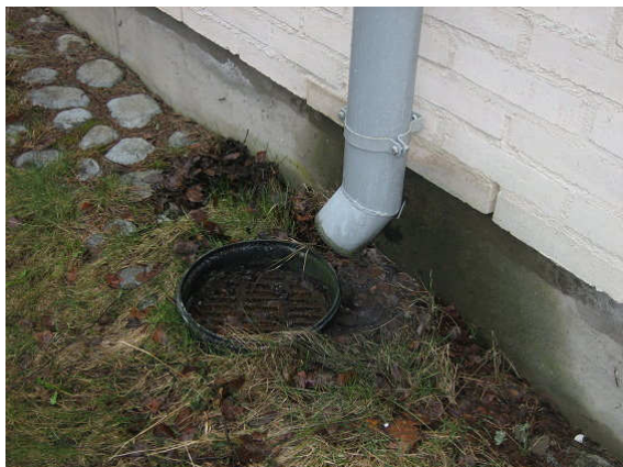
Kuva 8 Sadevedet eivät ohjaudu sadevesikaivoihin.
