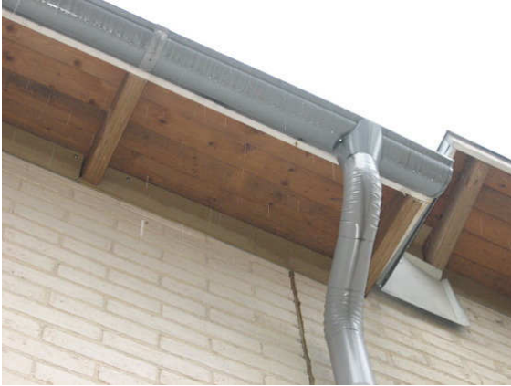
Kuva 9 Sadevesikourujen ja syöksytorvien liitoksissa puutteita.
