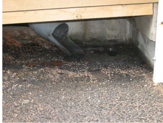
Kuva 10 Leikkipihan puolella syöksytorvien ulosheittimet suunnattu rakenteisiin päin.
