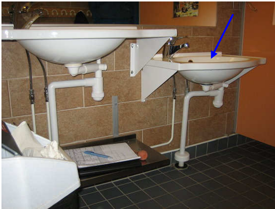
Kuva 5 WC-tila 09. Oikean puoleisessa lavuaarissa voimakas maan haju.
