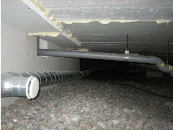
Kuva 3 Alustatilassa on koneellinen poistoilmanvaihto.
