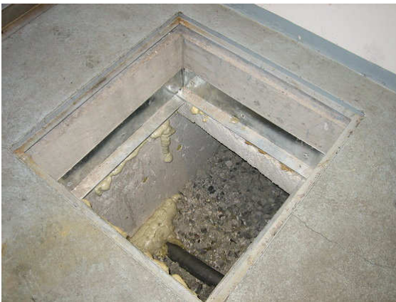
Kuva 1 Luukut tiivistämättömät ja pohjaluukut puuttuivat.
