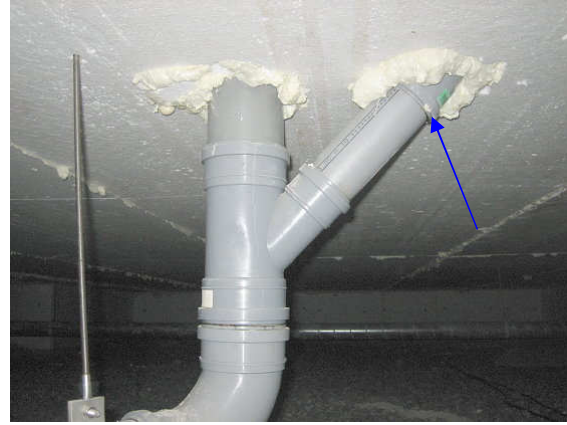
Kuva 4 Lämpiviennit on pääasiallisesti tiivistetty. Osa viemäriputkien johteista on asennettu väärin päin.
