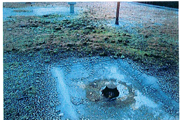
Kuva 18 Katolla oli runsaasti sammalta. Rästäspellitykset oli vedetty leveästi katolle
