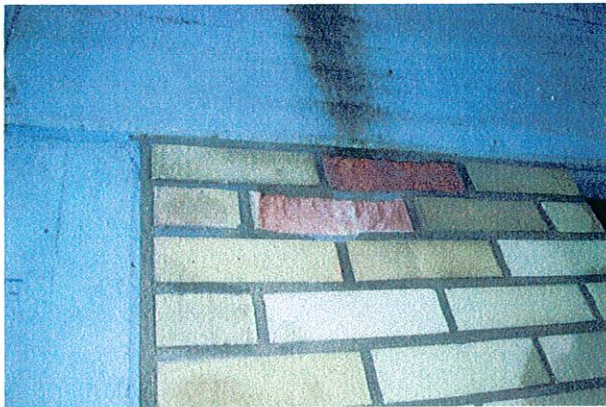
Kuva 13 Ulkoseinässä oli tiilien pakkasvaurioita, pilarien ja palkkien saumauksia oli korjailtu
