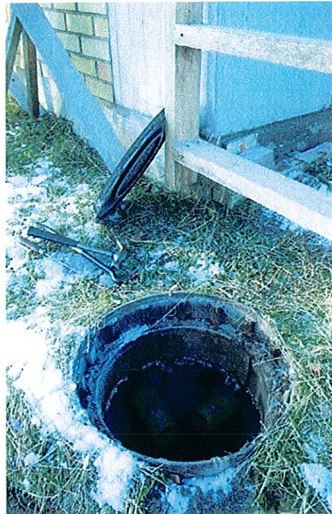
Kuva 8 Koilliskulman salaojakaivossa putket lähellä maanpintaa
