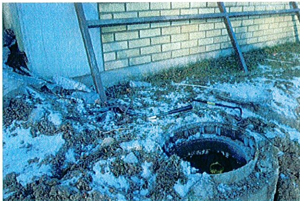
Kuva 5 Kaakkoiskulman salaoja oli liian korkealla. Kaivon pohjalla oli vettä
