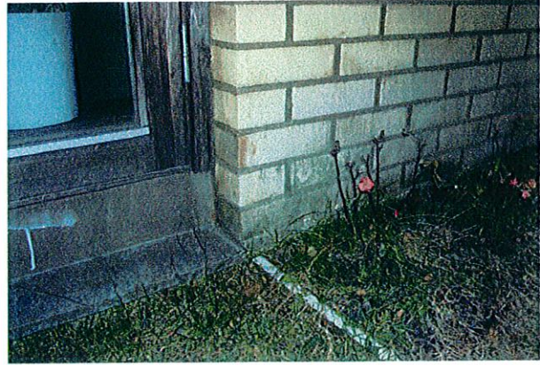
Kuva 2 Eteläsivulla on maanpintaliian korkealla, tiilet ja sokkeli kastuvat
