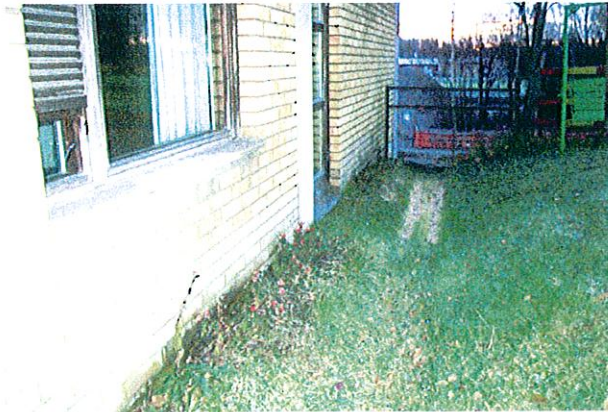
Kuva 1 Maanpinta viettää kohti rakennusta eteläsivulla, alla on onkalo
