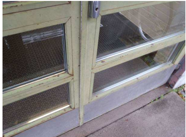
Metallirakenteiset etuovet ovat maalipinnoiltaan kuluneita.
