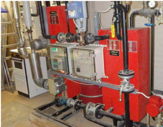
Lämmönsiirtimet ovat alkuperäiset vuodelta 1980.
