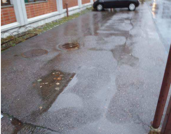
Paikoin asfalttipinnoille kerääntyy vesilammikoita.
