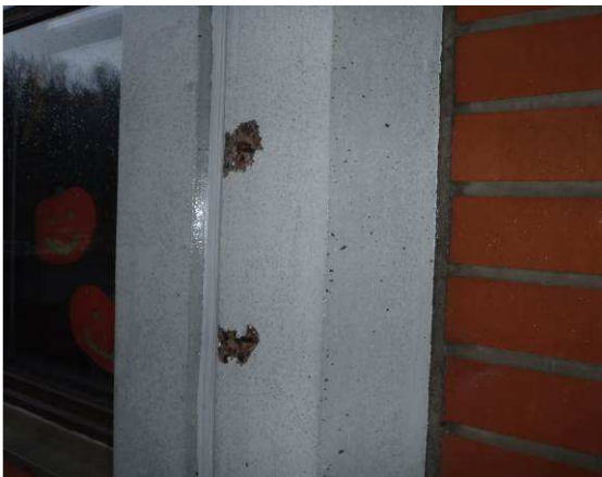
Julkisivuissa on havaittavissa rapautumista.
