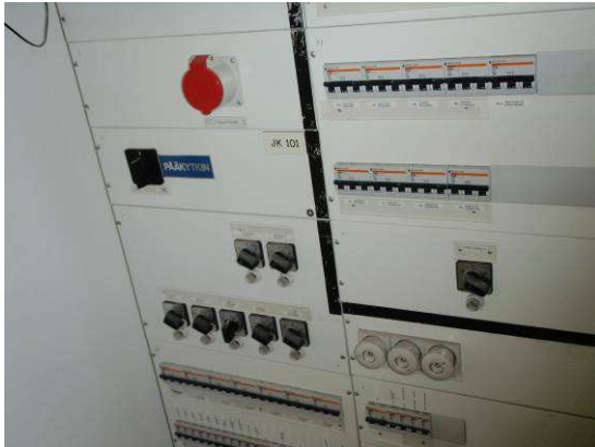
Kiinteistön sähkökeskukset ovat kokonaisuudessaan toimintakuntoisia.
