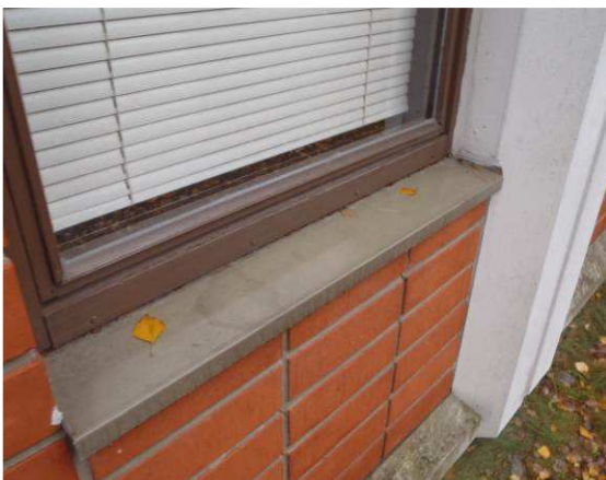
Ikkunoiden ulkopintoja on huoltomaalattu. Vesipeltien kallistukset ovat huonot.
