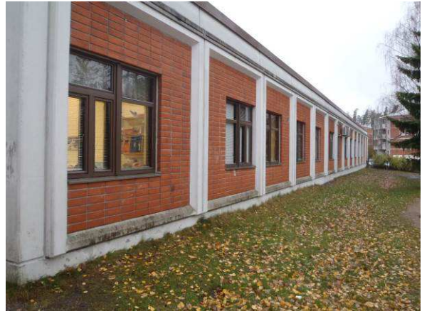
Takaosalla vierustat ovat nurmipintaisia. Kallistukset ovat oikein.
