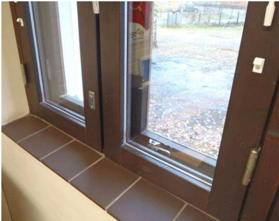
Kuvaa puuikkunoista, joiden sisäpinnat ovat vielä hyvässä kunnossa.
