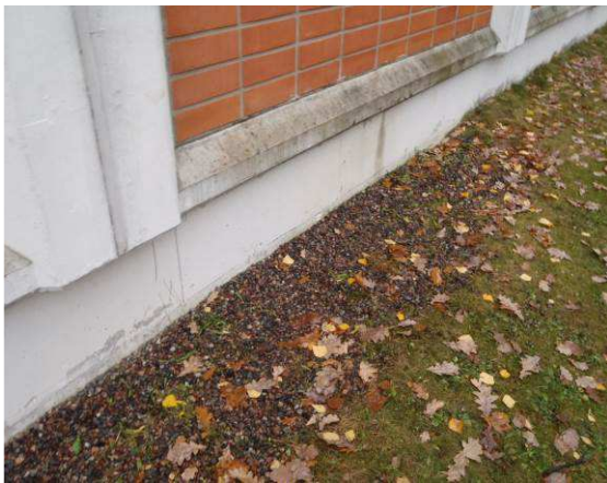
Sokkelipintaa, maalit ovat hilseilleet irti.
