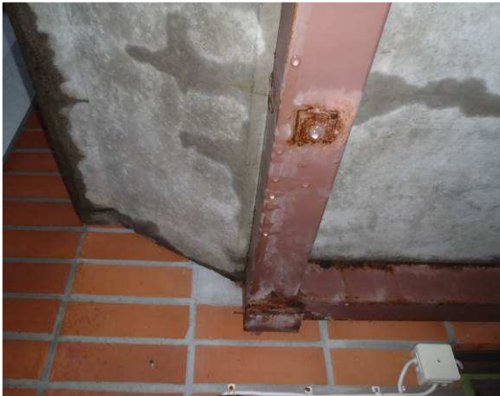
Katoksien teräsosat ovat ruosteessa.
