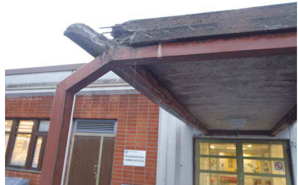
Ulko-ovien edustoilla olevat 5 kpl, katoksia ovat huonossa kunnossa.
