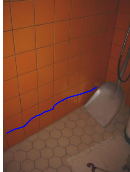
Kuva 12 Asunnon pesuhuoneessa havaittiin seinällä pintakosteuden tunnistimella kohonneita kosteuksia ylettyen 1 laattarin korkeudelle lattiasta.
