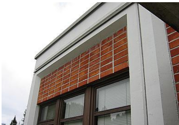
Kuva 3 Julkisivuissa oli runsaasti pakkasra-pautuneita tiililaattoja. Sadevedet valuvat ulkoseinää myöten.
