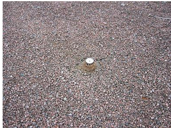
Kuva 6 Vesikaton sadevesikaivojen roskasihtejä tukkeutunut.
