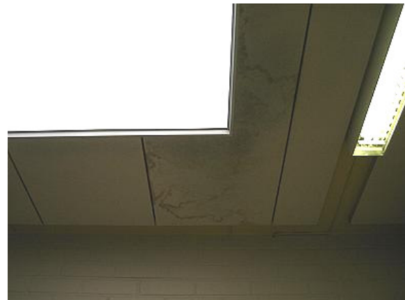
Kuva 14 Tila 37. Kattoikkunan kohdalla vanha vesivuoto kohta.
