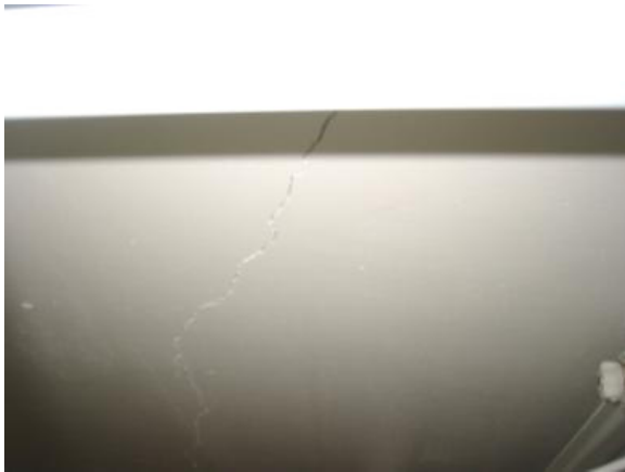
Kuva 11 Rakennuksessa oli rakenteiden liikkumisesta aiheutuneita halkeamia.
