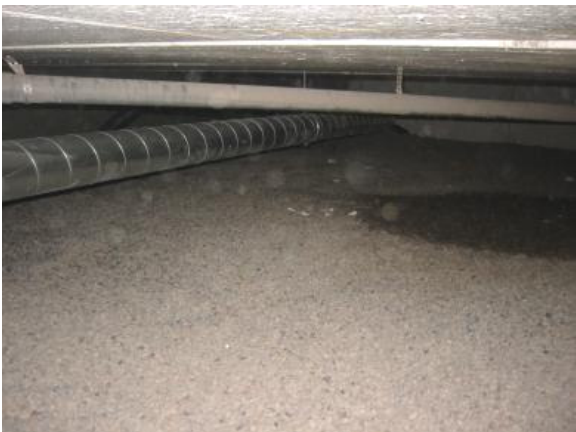
Kuva 13 Laajennusosan tuletettua alapohjaa. Oikealla tumma, mahdollisesti kostea alue. Pidemmällä ei käyty.
