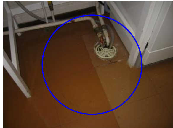
Kuva 8 Kosteusvaurioitunut lattiakaivon ympäryksessä tilassa 22.
