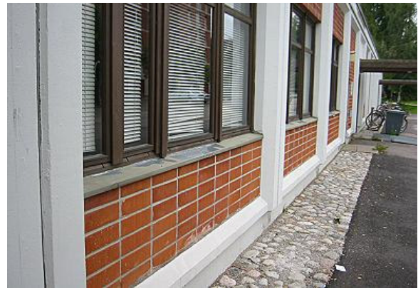
Kuva 2 Ikkunoiden ja julkisivun liitokohtien saumamassaukset olivat puutteelliset. Vesipeltien maalia hilseilyt pois.
