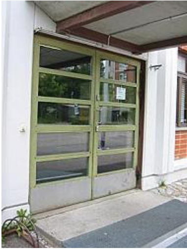
Kuva 5 Teräsrakenteisissa ulko-ovissa oli alkavia ruostevaurioita.
