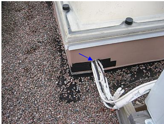
Kuva 7 Puutteellinen läpiviennin tiivistys.
