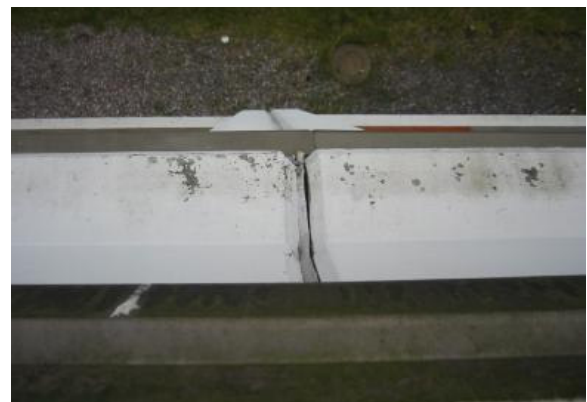
Kuva 4 Julkisivusaumaukset paikoitellen irronneet elementtien pinnoista.
