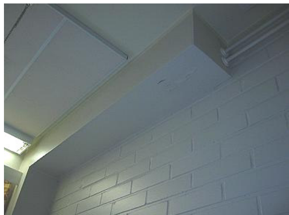
Kuva 10 Tilassa 24 putket lastulevyrakenteen sisään. Levypinnan maali hilseillyt irti alustasta.
