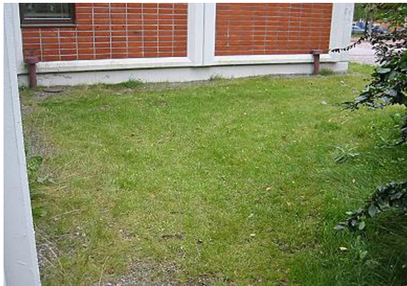
Kuva 1 Rakennuksen pohjoissivustan ja itäpäädyn kulmauksessa kallistus rakennuksesta pois päin vaikutti puutteelliselta.
