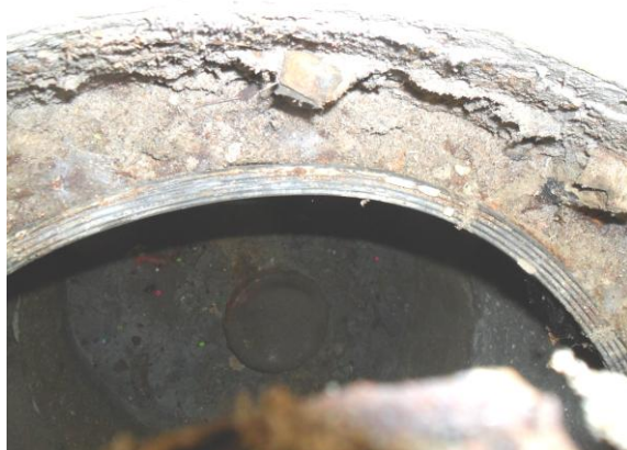
Kuva 1. Kaivon pohjalla epäpuhtauksia.
