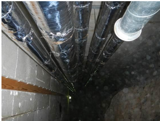
Kuva 2. Lämpö- ja käyttövesirunkojohtoja putkitunnelissa.
