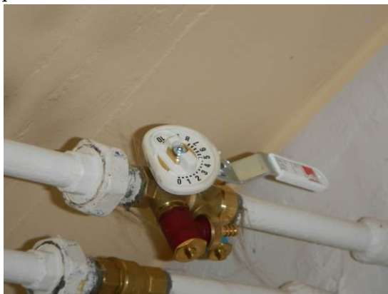
Kuva 4. Lämpöjohtoverkoston uusittuja venttiileitä, linjasäätöventtiili täysin auki.
