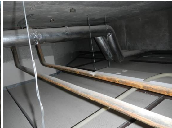
Kuva 3. Lämpöjohtoja alakaton takana.
