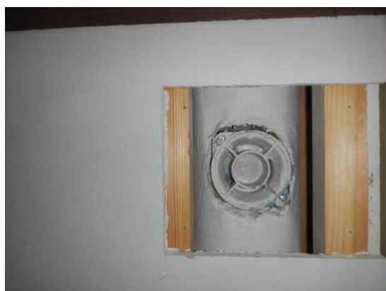
Kuva 23. Sadevesiviemärin puhdistusluuku, viemärin eristeet saattavat sisältää asbestia.
