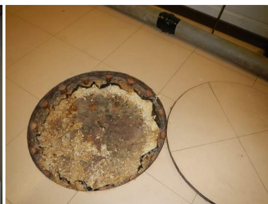
Kuva 24. Rakennuksen sisällä oleva sadevesitarkastuskaivo svtk2 on tiivistetty sahanpurulla ja jätesäkillä.
