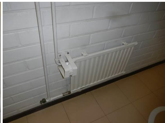
Kuva 5. Peltipatteri ja uusittu termostaattinen patteriventtiili.
