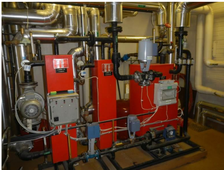
Kuva 1. Kaukolämmön alajakokeskus varusteineen.
