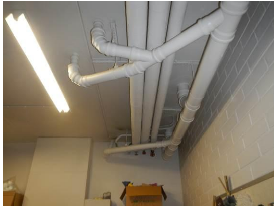
Kuva 9. Käyttövesijohtoja näkyvillä opetus-tiloissa.
