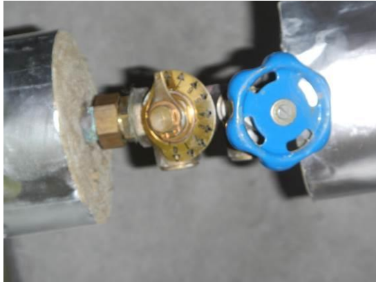
Kuva 13. Kiertoveden virtaamia ei ole näytötäulujen mukaan säädetty, täysin auki.
