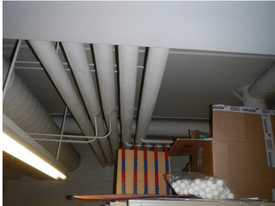
Kuva 6. Lämmitys- ja käyttövesiverkoston alkuperäiset putkieristeet saattavat sisältää asbestia.
