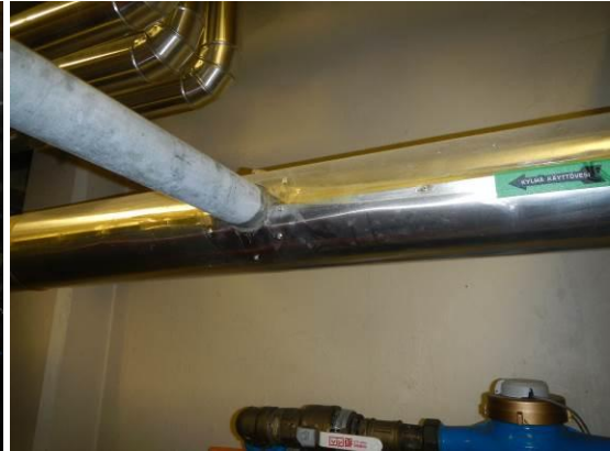
Kuva 8. Kylmän käyttöveden runkojohto sinkittyä teräsputkea.
