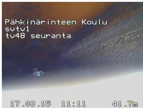
Kuva 19. Painumasta johtuvaa vesitäyttöä sadevesipohjaviemäriissä.
