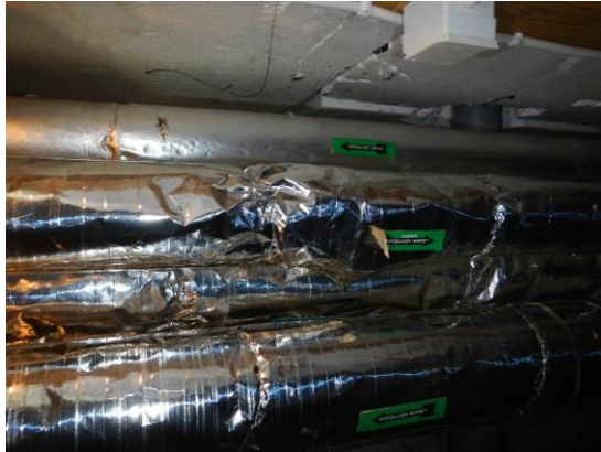
Kuva 7. Käyttöveden runkojohtoja putki-tunnelissa.
