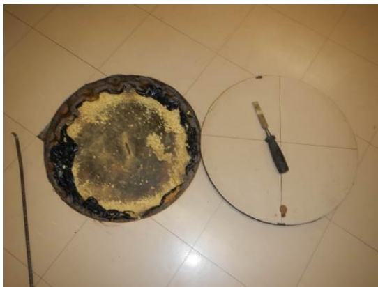
Kuva 16. Tarkastuskaivo jvk3 välikansi tiivistetty sahanpurulla ja jätesäkillä.
