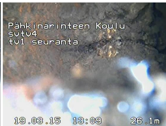
Kuva 20. Este/tukkeuma sadevesipohjaviemäriissä liikuntasalin alapuolella.
