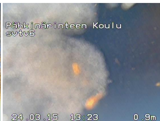
Kuva 22. Painumasta johtuvaa vesitäyttöä liikuntasalin alla sijaitsevassa pohjaviemäriissä.
