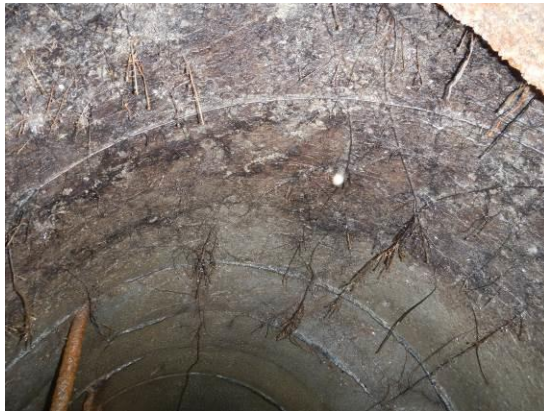
Kuva 18. Lievää juurikasvustoa tarkastuskaivon jvk1:ssa.
