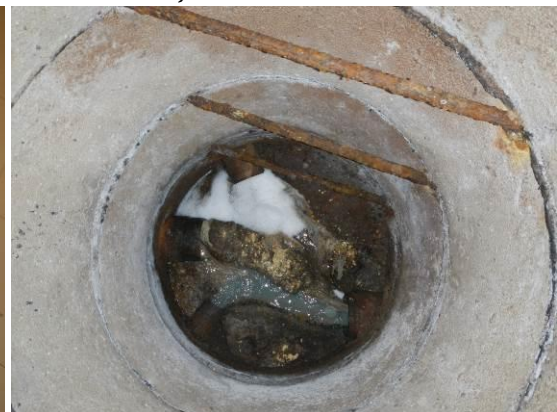
Kuva 17. Tarkastuskaivon jvk3 pohjakouru on kerännyt runsaasti jätettä kaivon pohjal-le.
