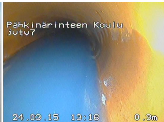
Kuva 15. Näkymä pohjaviemäriin tarkastuskaivosta jvk1 rakennuksen sisäänpäin, runsasta vesitäyttöä.
