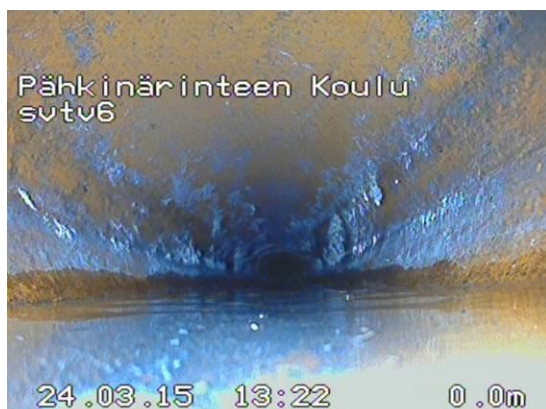
Kuva 21. Painumasta johtuvaa vesitäyttöä liikuntasalin alla sijaitsevassa pohjaviemäriissä.
