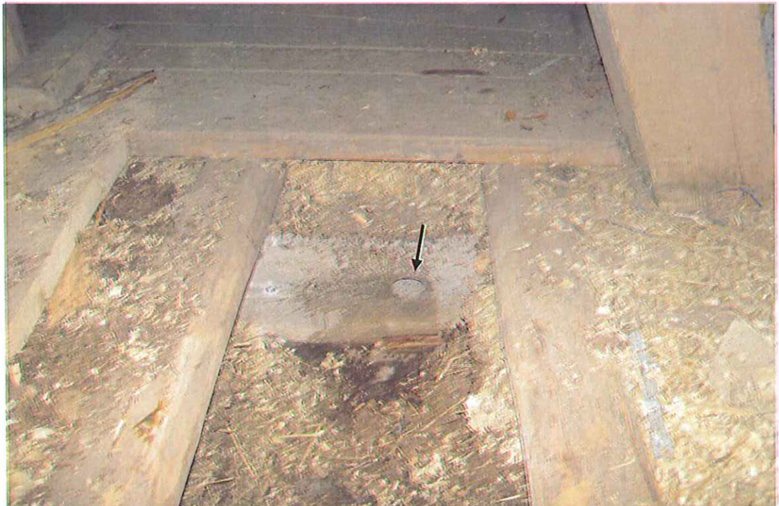
Kuva 4. Toinen palkin kyljestä poratuista näytteenottokohdista. Eristeet (turve ja puulastu) ovat rutikuivia, vain porausvesi kasteli kohtaa hieman.
