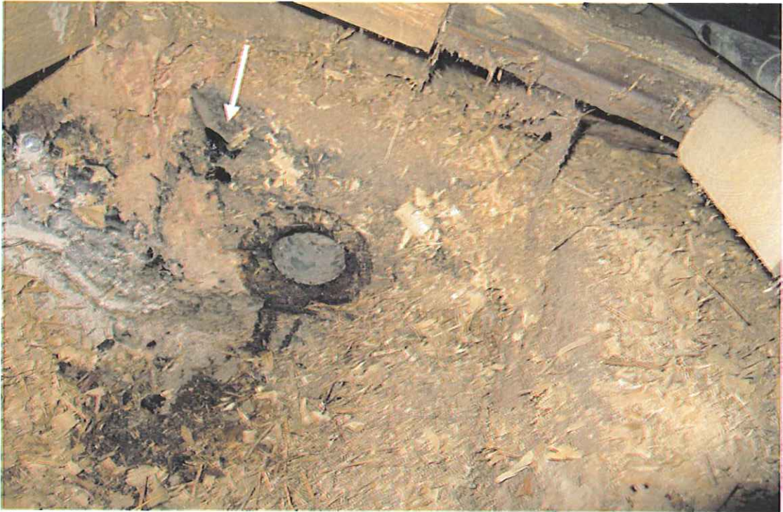
Kuva 7. Nuolen osoittamassa kohdassa nähdään kiiltävänä kivihiilitervakerrosta. Pääsääntöisesti sitä esiintyi laatan yläpinnassa.
