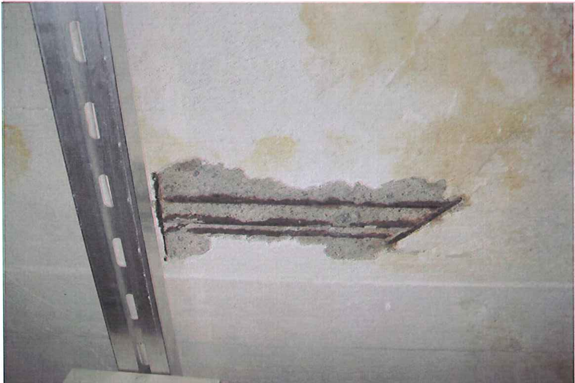
Kuva 2. Tyypillisiä betoniterästen korroosioaurioita alalaatassa.
