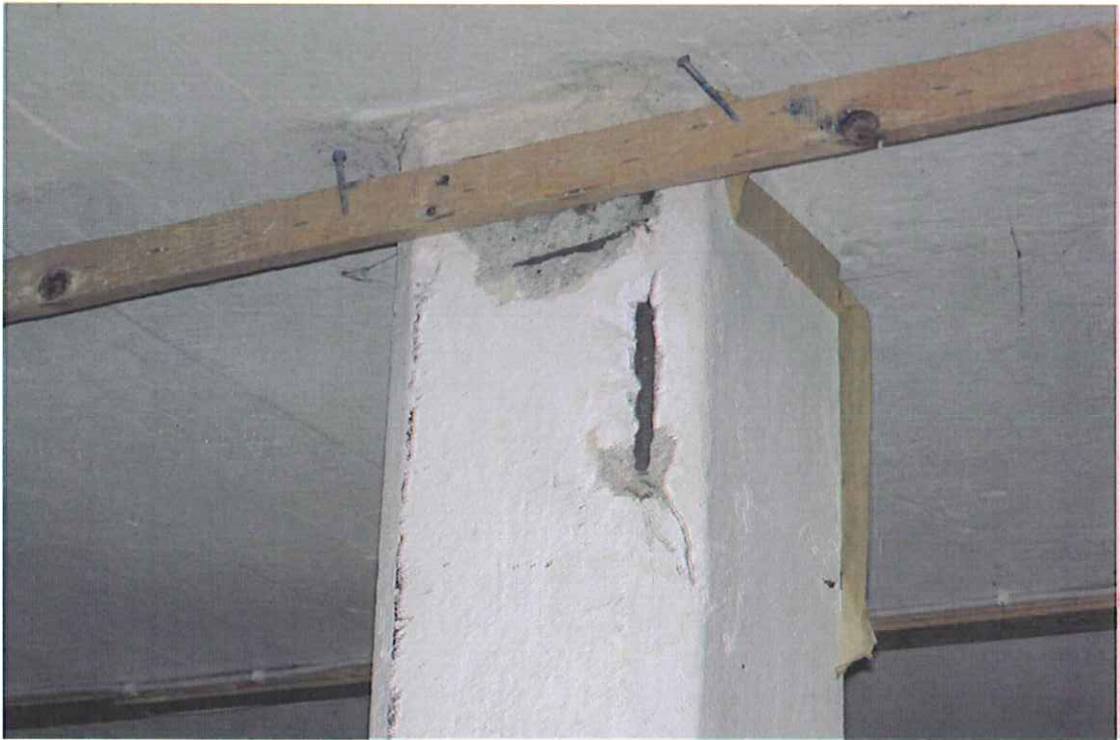
Kuva 1. Tyypillisiä betoniterästen korroosioaurioita pilareissa.
