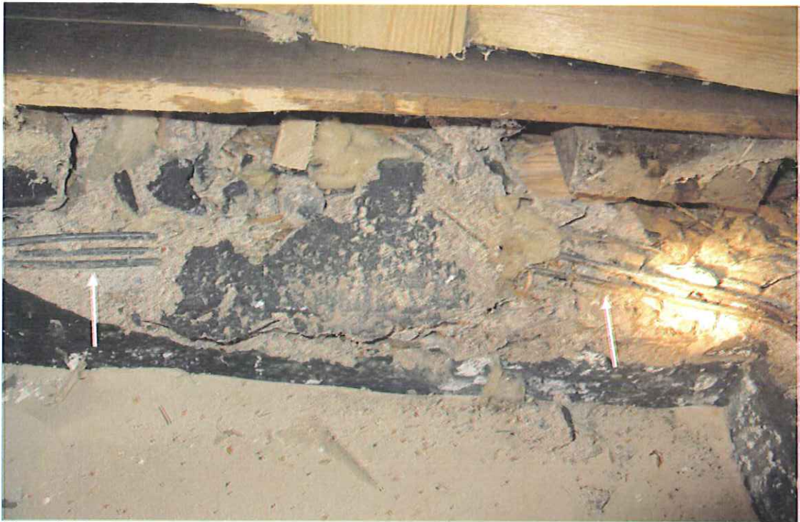
Kuva 5. Vanhan välipohjan aukon reunoja kiertävä betonipalkki on murtunut muutamista kohdista, mutta eristetilan kuivuuden vuoksi teräkset ovat vielä puhtaita (nuolet).
