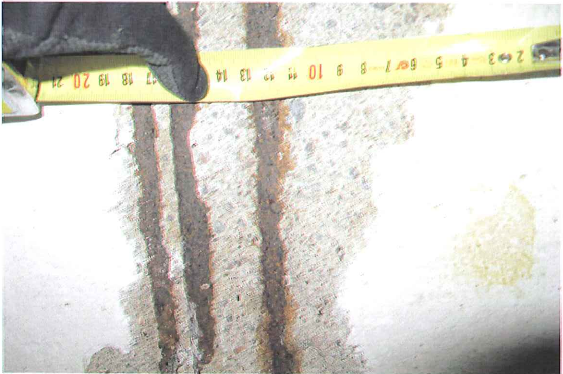
Kuva 8. Lähikuva betoniterästen korroosioauriokohdasta. Ruostekerros on jo melko paksu (tangon oletettu nimellishalkaisija noin 12mm).
