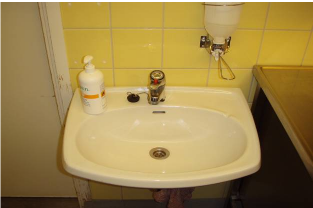
LVI-kuva 4. Yleiskuva vesikalusteista.
