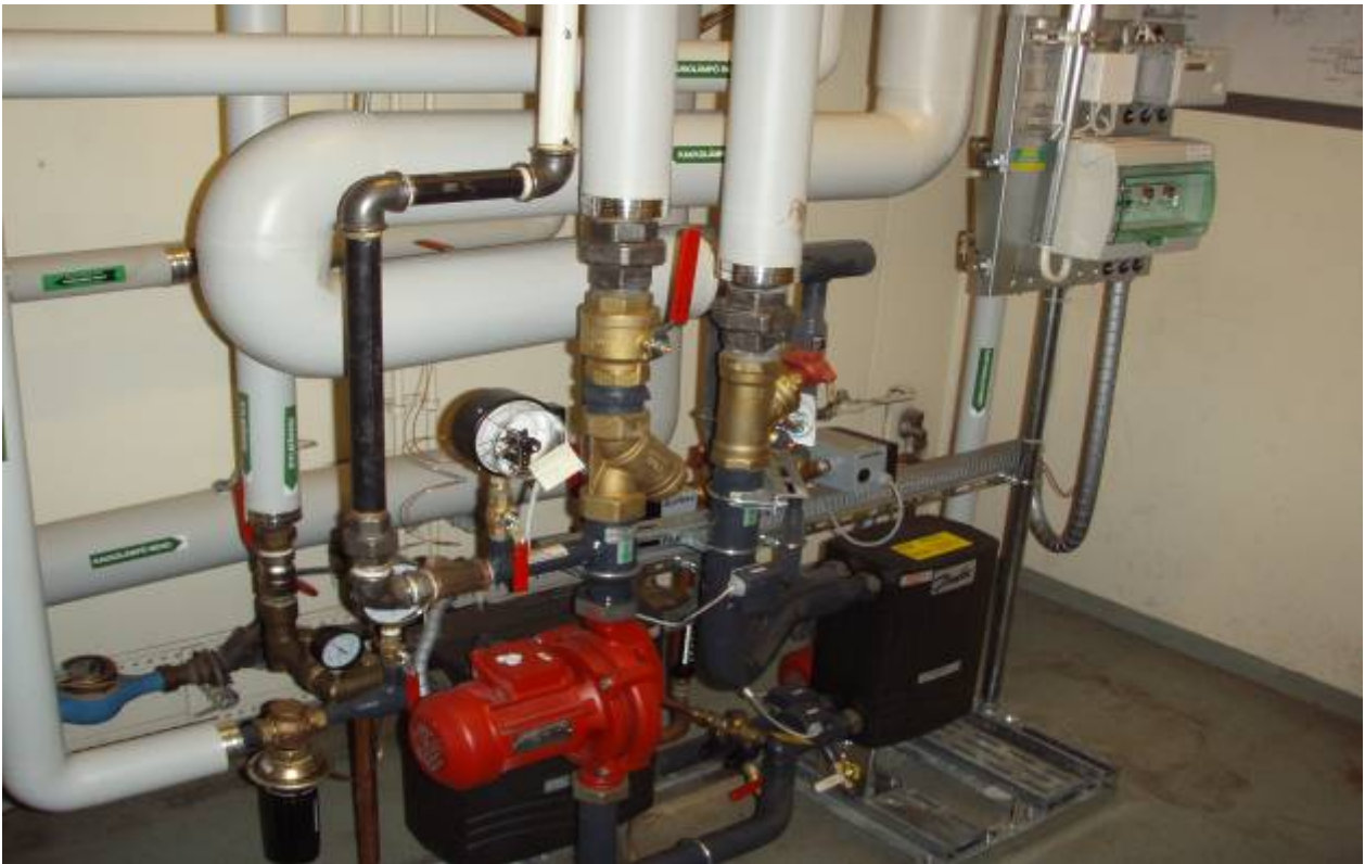
LVI-kuva 1. Yleiskuva lämmönjakohuoneesta.
