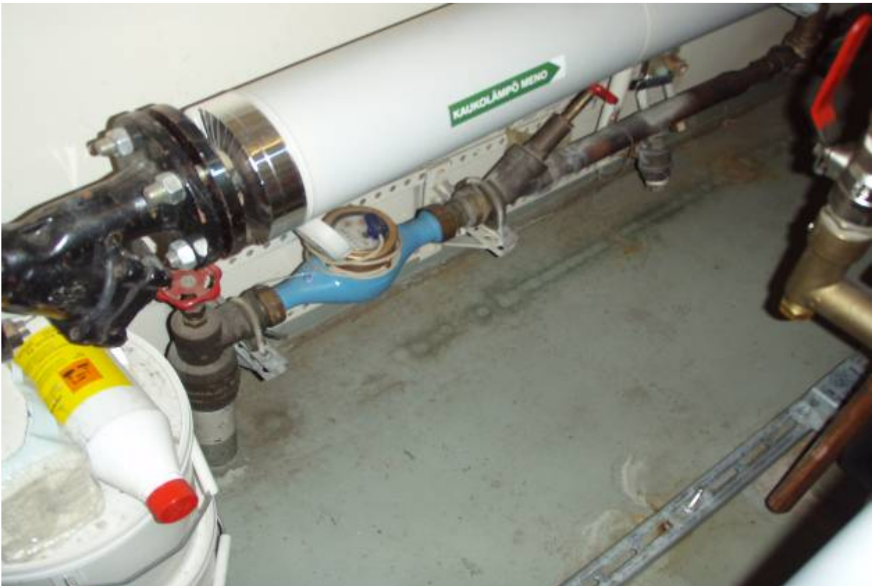
LVI-kuva 3. Yleiskuva vesimittarista ja pääsuluista.
