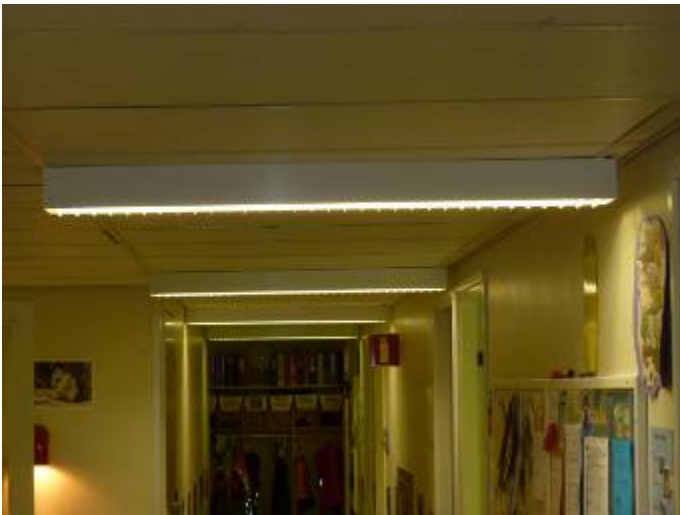
S-KUVA 6. Käytävän valaistus
