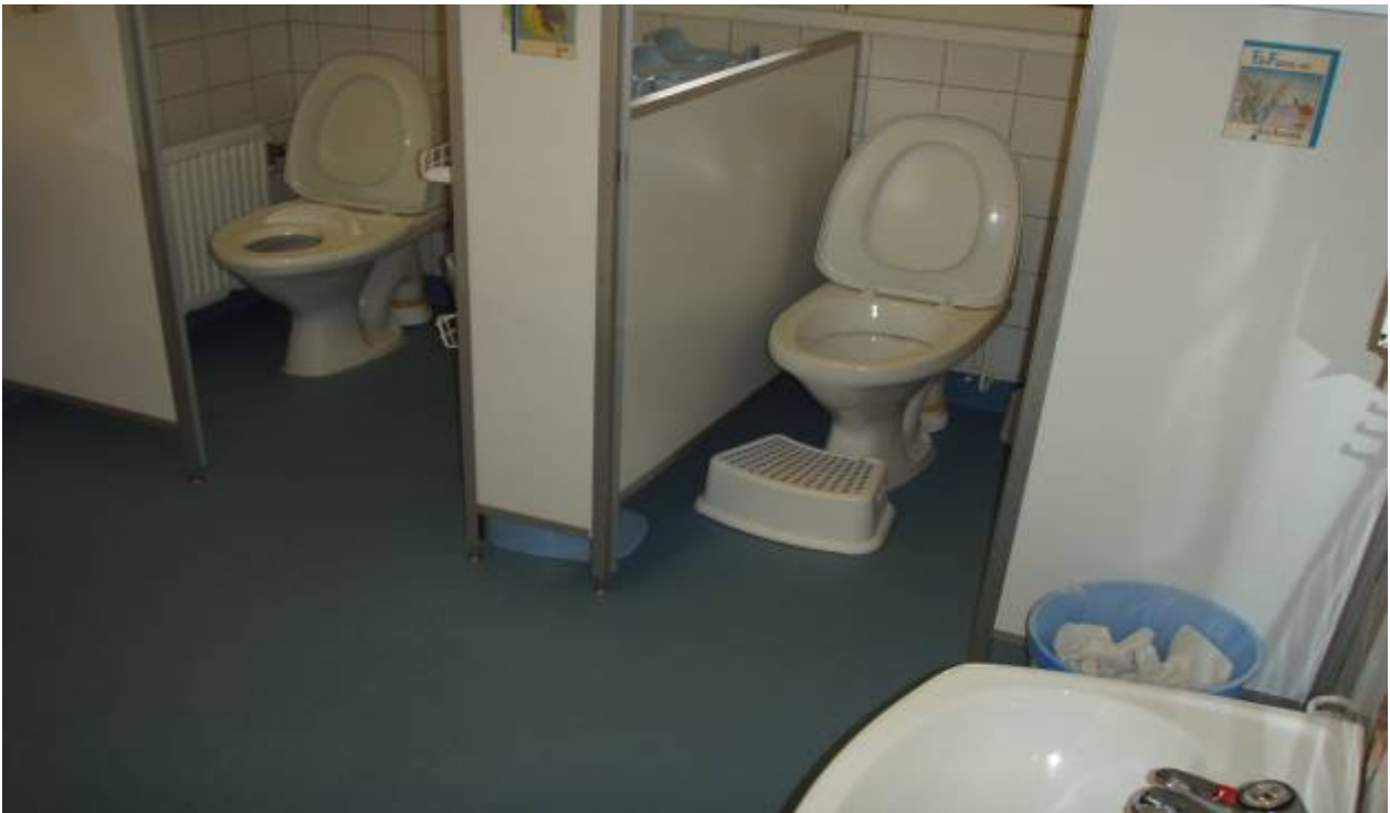
LVI-kuva 5. Yleiskuva wc-istuimista.
