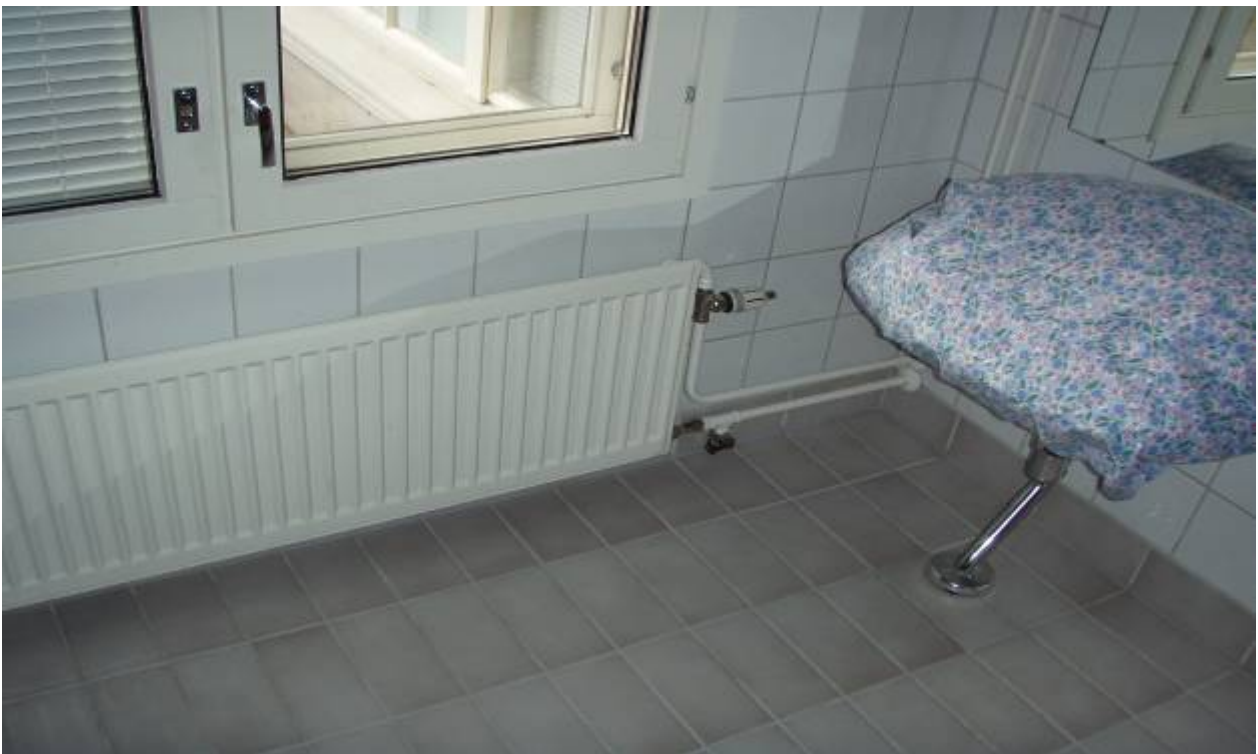
LVI-kuva 2. Yleiskuva patteriventtiileistä.
