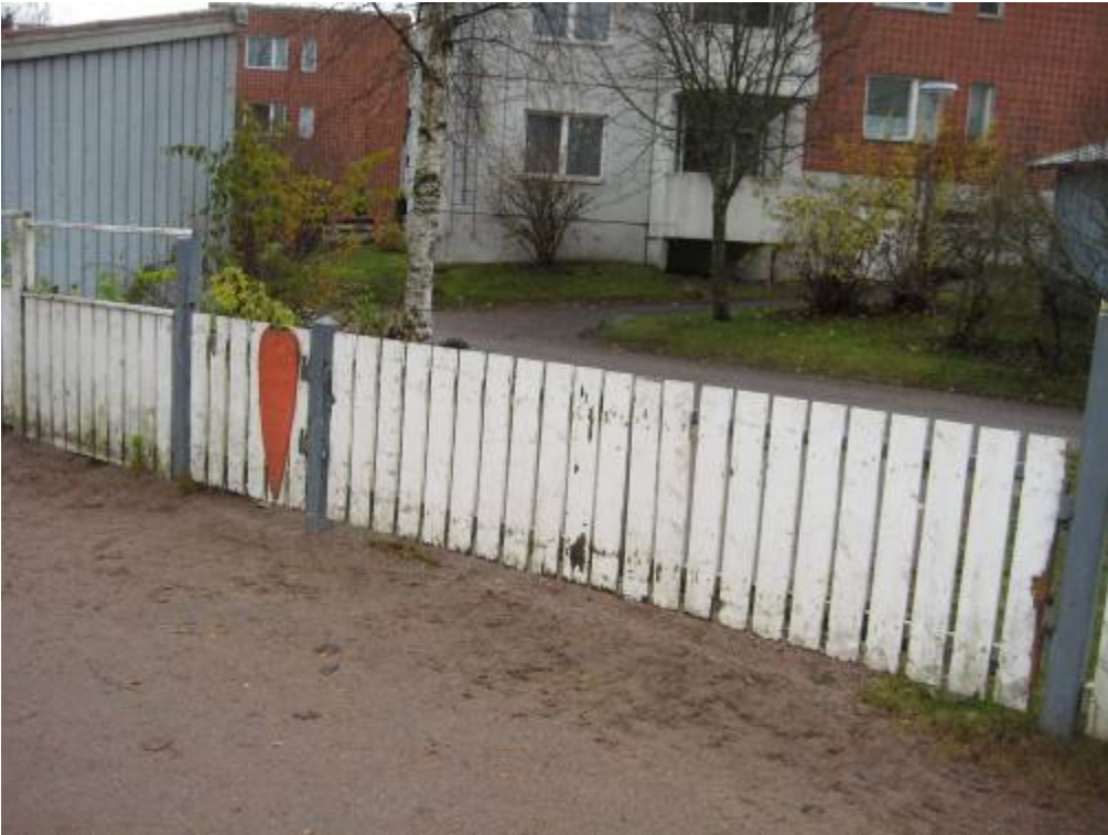
RAK-KUVA 3: Leikkikenttäalueen aitarakenteet arvioitiin edellyttävän peruskorjausta lähi-vuosien aikana.
