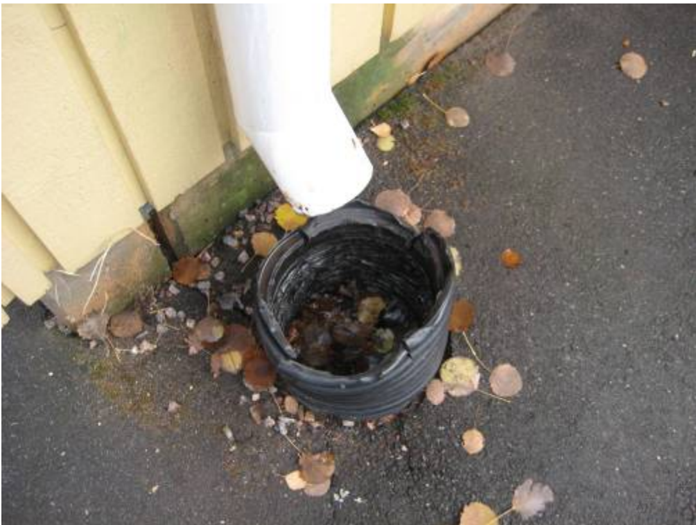
RAK-KUVA 6: Kattovedet on ohjattu sadevesijärjestelmään. Sadevesisuppiloiden säännöllinen tarkastaminen / kunnostus tulee liittää kiinteistön huolto-ohjelmaan.
