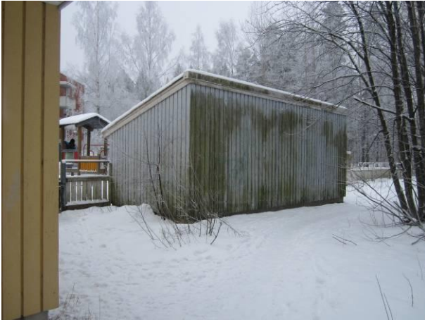
Kuva 3 Pihavarastojen ulkopinnat ovat huonokuntoiset.
