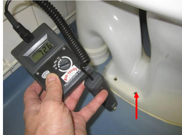
Kuva 10 Wc-pytynjuuren pk-arvot olivat paikoin hieman koholla. Ruuvireiät.
