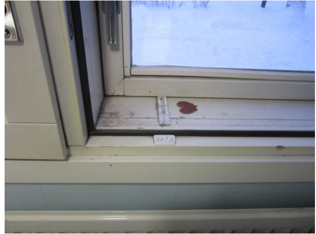
Kuva 18 Tuoretta vesivuotoa jiiiritaitteessa.
