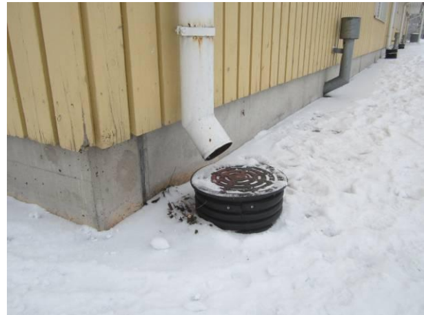
Kuva 16 Paikallisesti lautojen päitä on halkeillut kosteusrasituksen vuoksi.
