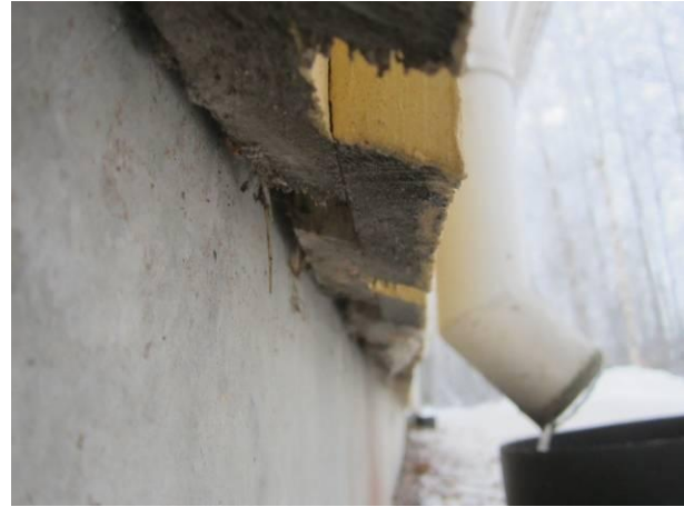
Kuva 14 Sokkelirajalla lautojen päät on viistetty, muttei ole maalattu ollenkaan.
