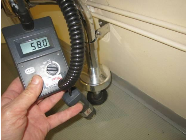
Kuva 9 Tyypillinen lavuaarin viemärin pk-arvo.
