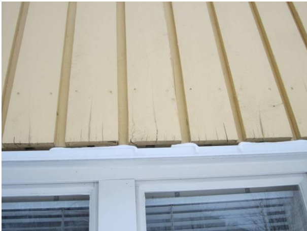
Kuva 15 Laudoissa on säärasitusta viistosateelle alttiin ikkunan yläpuolella.
