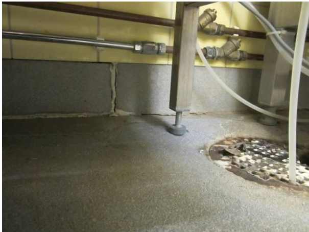
Kuva 27 Rakenteellinen halkeama seinällä, mutta ei ulotu maanvaraiseen lattiaan.
