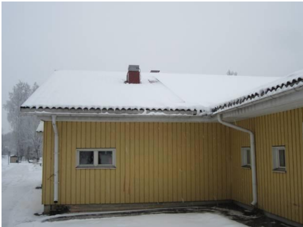
Kuva 23 Vesikatolla on lapetikkaita.
