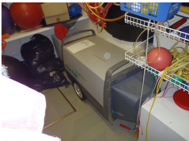
Kuva 1 Alapohjan tuuletusta hoitava kiertoilmalaite.
