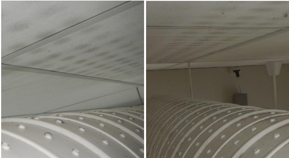
Kuva 4. Myös muissa luokkatiloissa havaittiin pölyä kattolevyissä suutinkanavien yläpuolella, mutta vähemmän kuin kotitalousluokassa. Mitä kauempana suutinkanava sijaitsi katosta, sitä vähemmän pölyä kattolevyissä oli tuloilmasuihkun kohdalla havaittavissa.
