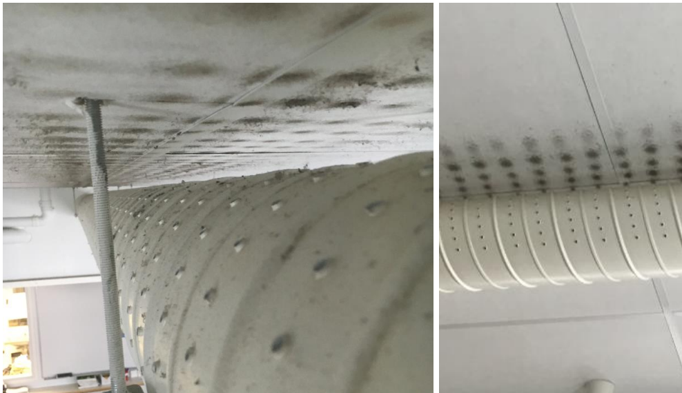
Kuva 3. Kotitalousluokassa 1049 kattolevyissä oli runsaasti pölyä suutinkanavien yläpuolella. Tilassa suutinkanavat sijaitsevat lähellä kattoa.
