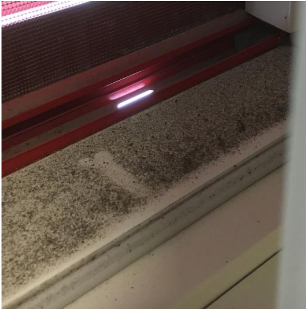
Kuva 8. Tummaa pölyä havaittiin runsaasti tuuletusikkunan välissä. Todennäköisesti pinnoilla havaittu tumma pöly tulee sisälle ulkoa ikkunoiden kautta.
