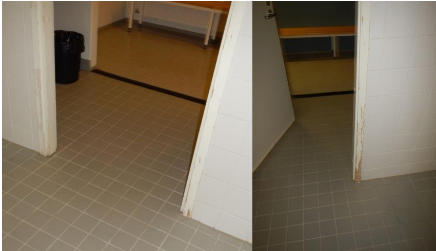
Kuva 2. Tilojen 112 (vasen kuva) ja 1120 (oikea kuva) oven karmien vaurioita.
