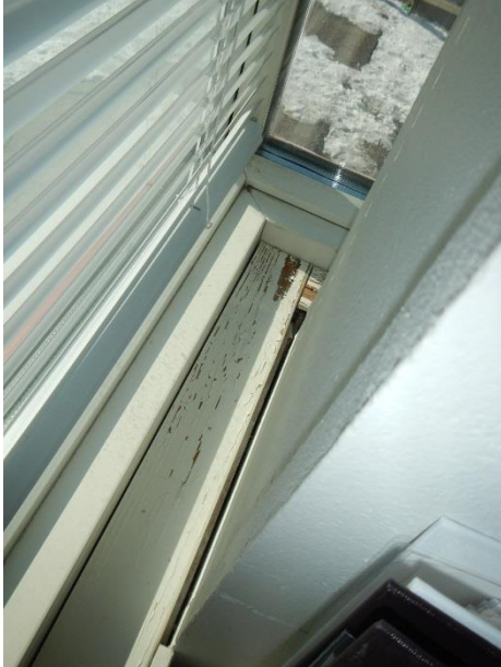
Kuva 1. Tilan 1086 ikkunan puulistan kosteusjälkiä.
