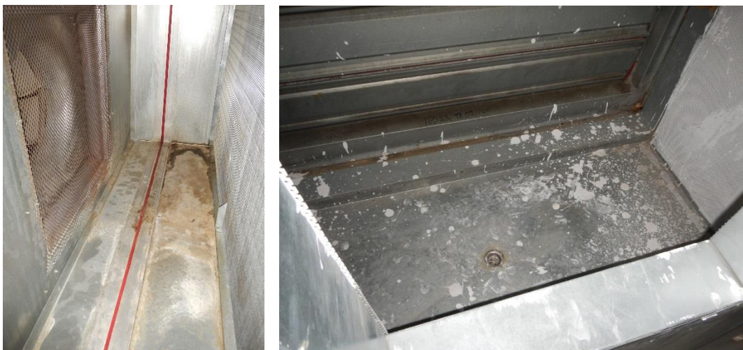
Kuva 12. TK4:n raitisilmakammio vasemmalla ja TK2:n raitisilmakammio oikealla.
