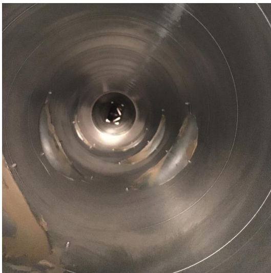
Kuva 10. Runkokanava käytävällä 1042. Pölyn määrä vähäinen.
