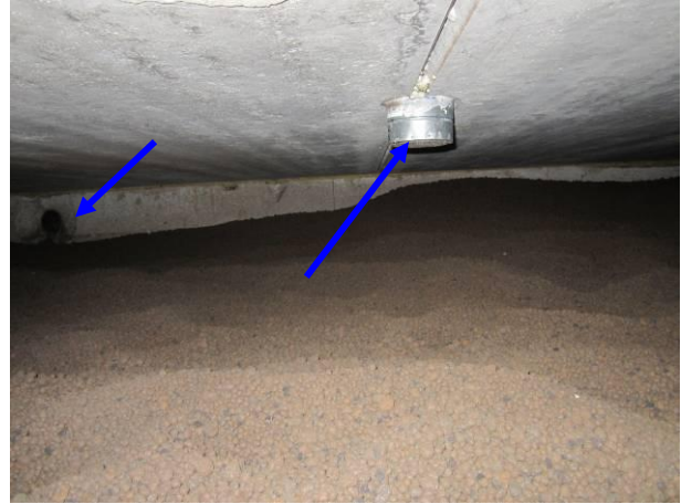
Kuva 8 Tulo- ja poistoputket.
