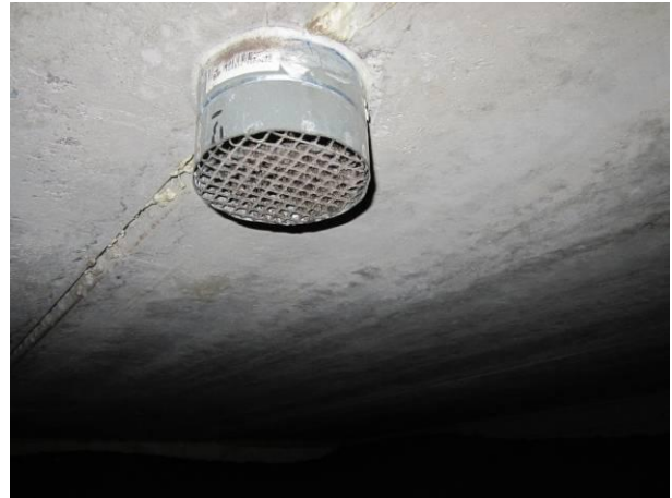
Kuva 4 Eteläpäädyn alustatilan poistoputki
