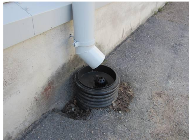
Kuva 6 Itäisivun rännikaivo, vesi osin ohi.
