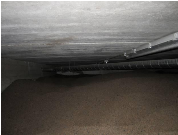
Kuva 13 Alustatilaa ryhmähuoneen 48 alla, IV-kanava ja valaisin.
