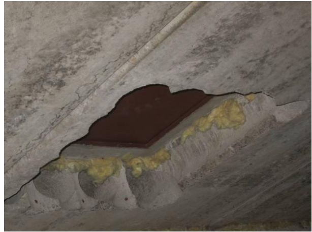
Kuva 12 Luukku leikki- ja lepohuoneen 47 kohdalla.
