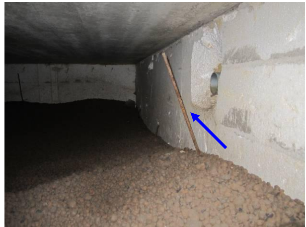
Kuva 14 Tuloilmaputken pää ja vaarallinen sidosteräs.
