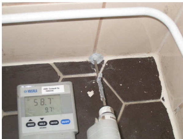
Kuva 5 Porareikämittaus PR1 ulkoseinän alaosalla, (9,7 °C, 59 %RH, 5,4 g/ m 3 on kuiva).
