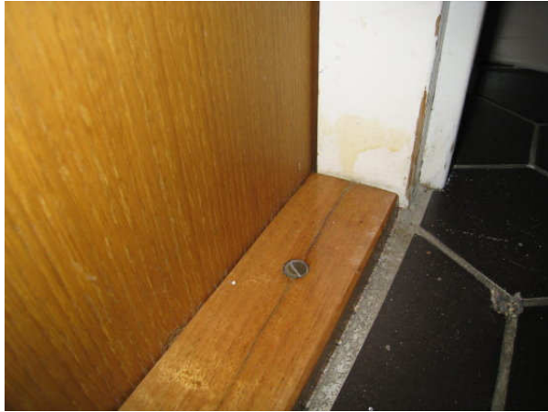
Kuva 7 Wc-oven alta ei ole korvausilmara- koa.
