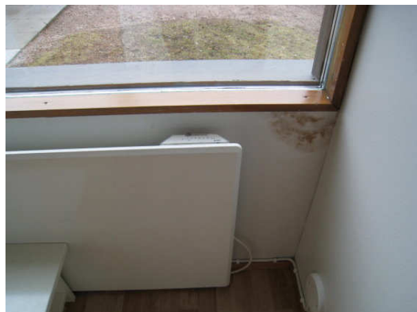
Kuva 12 Selvä kosteusvaurio käytävällä 112 ikkunan alapuolella seinässä.
