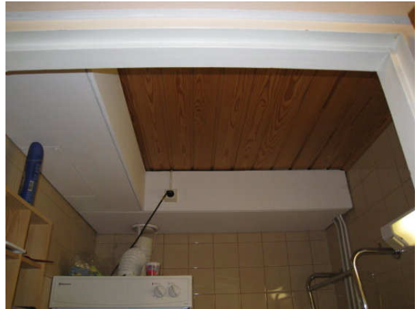
Kuva 2 Wc-tilan 104 katossa on IV-kotelo, josta tulee myös putkivetoja.
