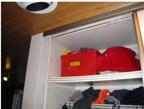
Kuva 11 Kosteusvaurioitunut kaappi eteistilas- sa, jonka lähellä on wc-tila 104.
