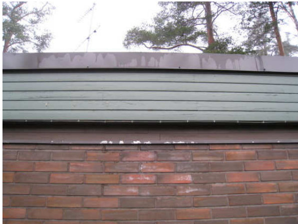
Kuva 15 Tiiliseinässä on kalkkijälkiä tiilimuurauksen vesipellin liitoksen kohdalla, takana on wc-tila 104.
