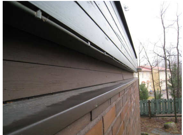
Kuva 16 Räystäät eivät suojaa seinää kastumiselta. Vesipelleissä ei ole viettoa ja ne ovat lyhyet. Tiilimuurauksen alareunassa ei ole tuuletusrakojä pystysaumoissa.
