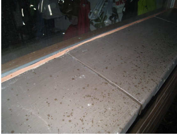
Kuva 13 Ikkunalasin ja vesipellin liitoksen tiiveys on vain kitin varassa.
