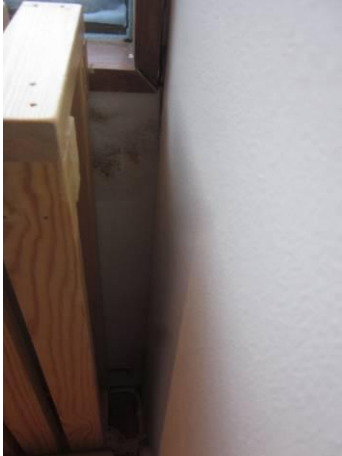
Kuva 11 Kosteusvaurioon viittaava ruskea värjäytymä talvipuutarha/ käytävä ulkoseinällä ikkunan alla.
