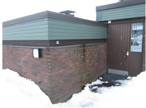
Kuva 4 Vesivuotovaurioita autotallin seinällä.
