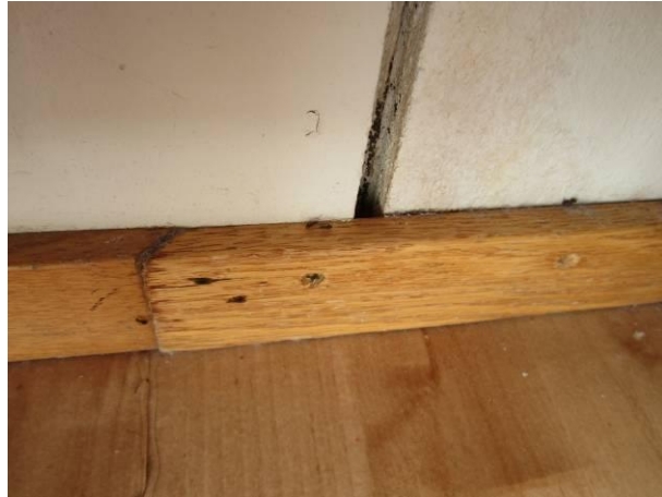
Kuva 12 Ulkoseinällä muurahaisia lähellä rakennavauspaikkaa AV5. Lisäksi levy on värjäytynyt.
