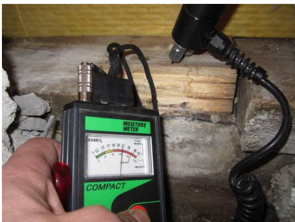
Kuva 37 AV5A –alasidepuu on paikoin kostea, samoin betonisokkeli sen kohdalla.
