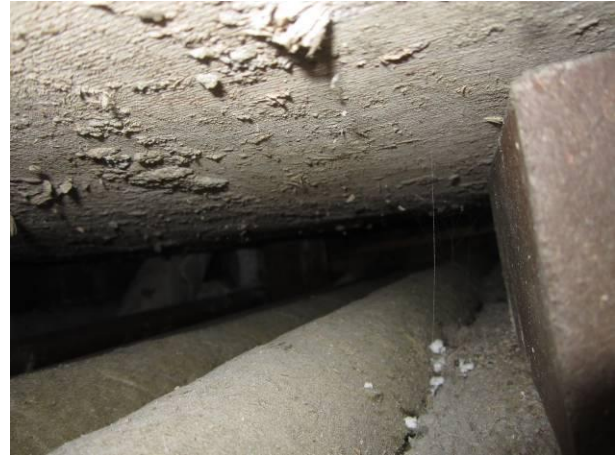
Kuva 24 AV1 -avauskohdan alla on putkikanaali, putkissa on villaeristeet.
