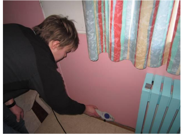
Kuva 16 Alapohjaan laskettua kaasua havaittiin tulevan ulkoseinäliittymistä.
