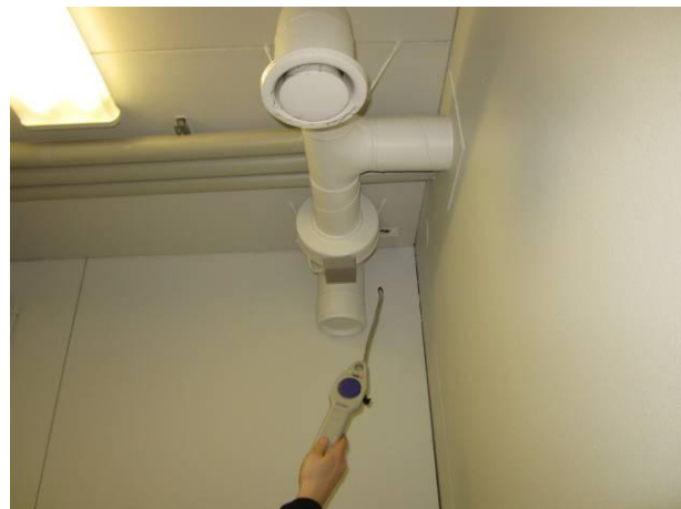
Kuva 14 Merkkikaasua havaittiin tulevan mm. siivouskomero SK 121 katon ja kantavan väliseinän liittymästä.
