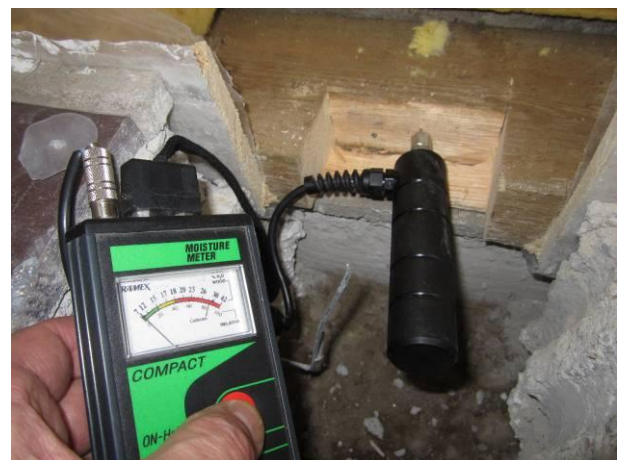
Kuva 26 Kestopuu on kuiva. Täyttöhiekkasta otettiin mikrobinäyte MAT1.
