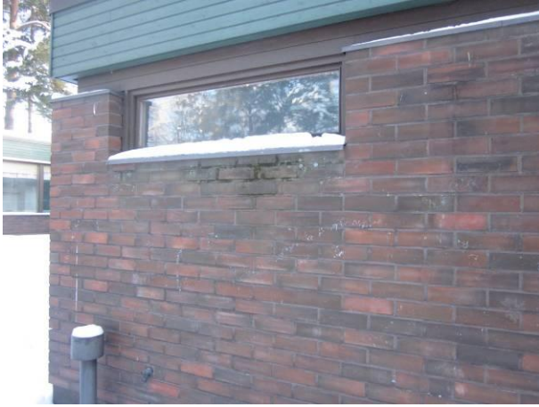
Kuva 3 Ikkunavesipellit ovat lyhyet
