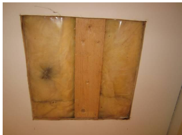
Kuva 38 AV5B -avaus, höyrysulussa on ilmavuotoreikä.
