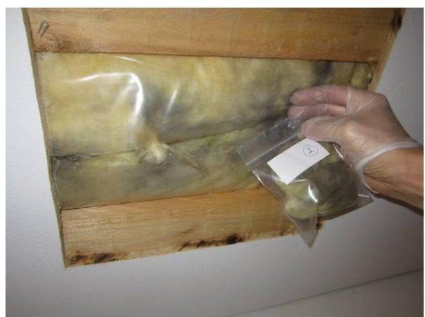
Kuva 30 AV3B -rakenneavaus Katon villaeristeestä otettiin mikrobinäyte MAT2.
