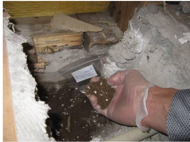
Kuva 36 AV5A -avaus/ käytävä 112. Täyttöhiekka on märkää. Täyttöhiekasta otettiin mikrobinäyte MAT5.
