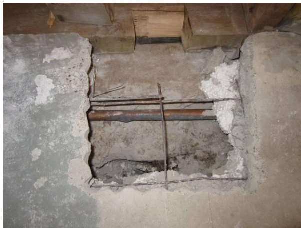
Kuva 40 AV6, jossa laatan alla perusmuuria vasten oli hiekkatäytössä lahoa muottipuuta. Eristetilassa on kuparinen vesiputki.
