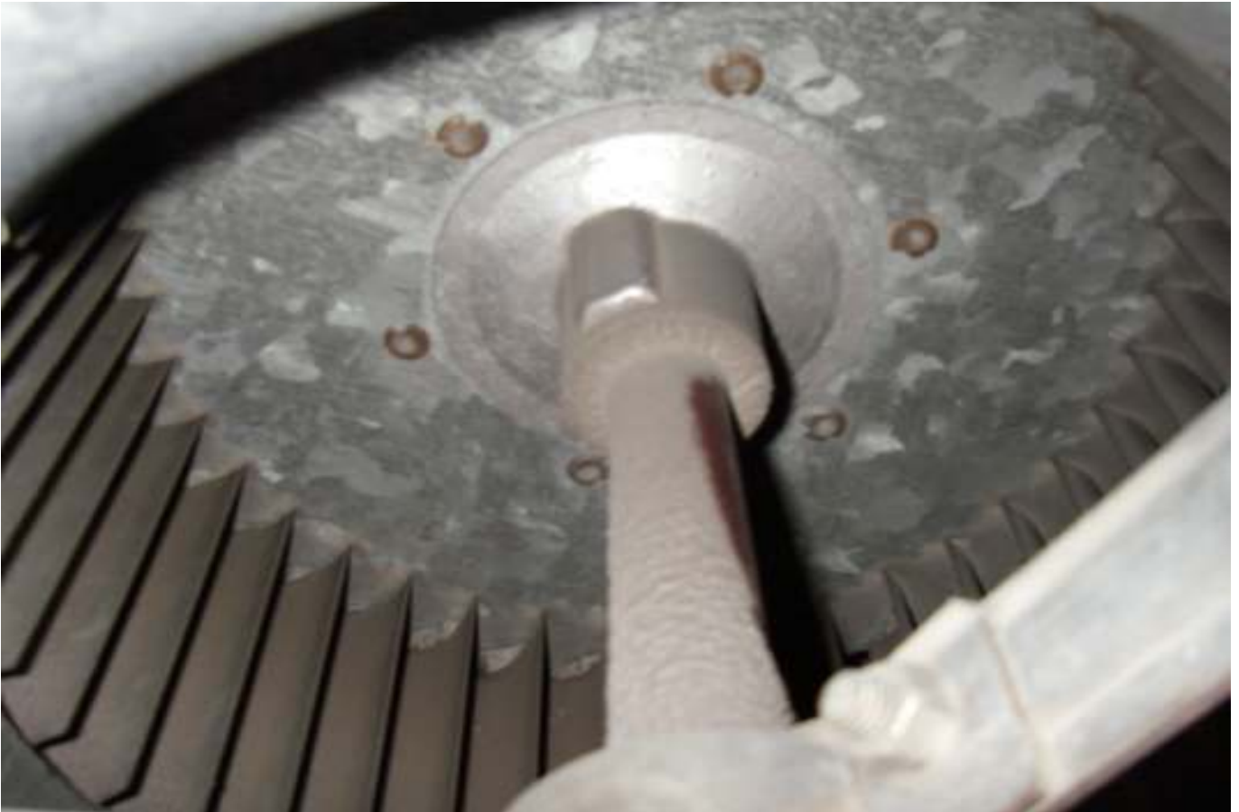
KUVA 9. Poistoilmavahdin on hieman pölyinen ja nokinen.
