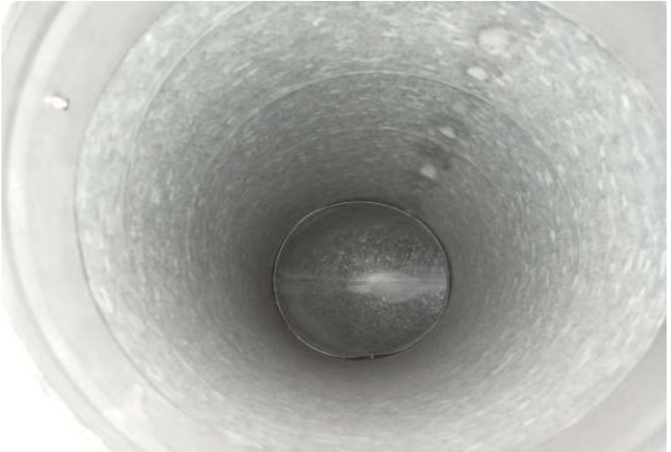
KUVA 15. Yleiskuva leikkihuoneen poistoilmakanavasta.
