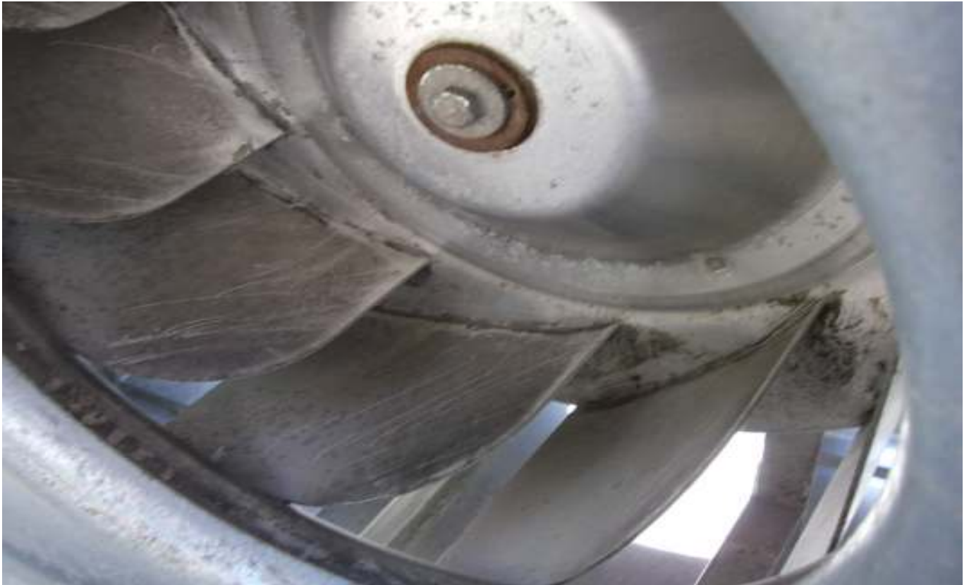
KUVA 11. Yleiskuva keittiön huippuimurista.
