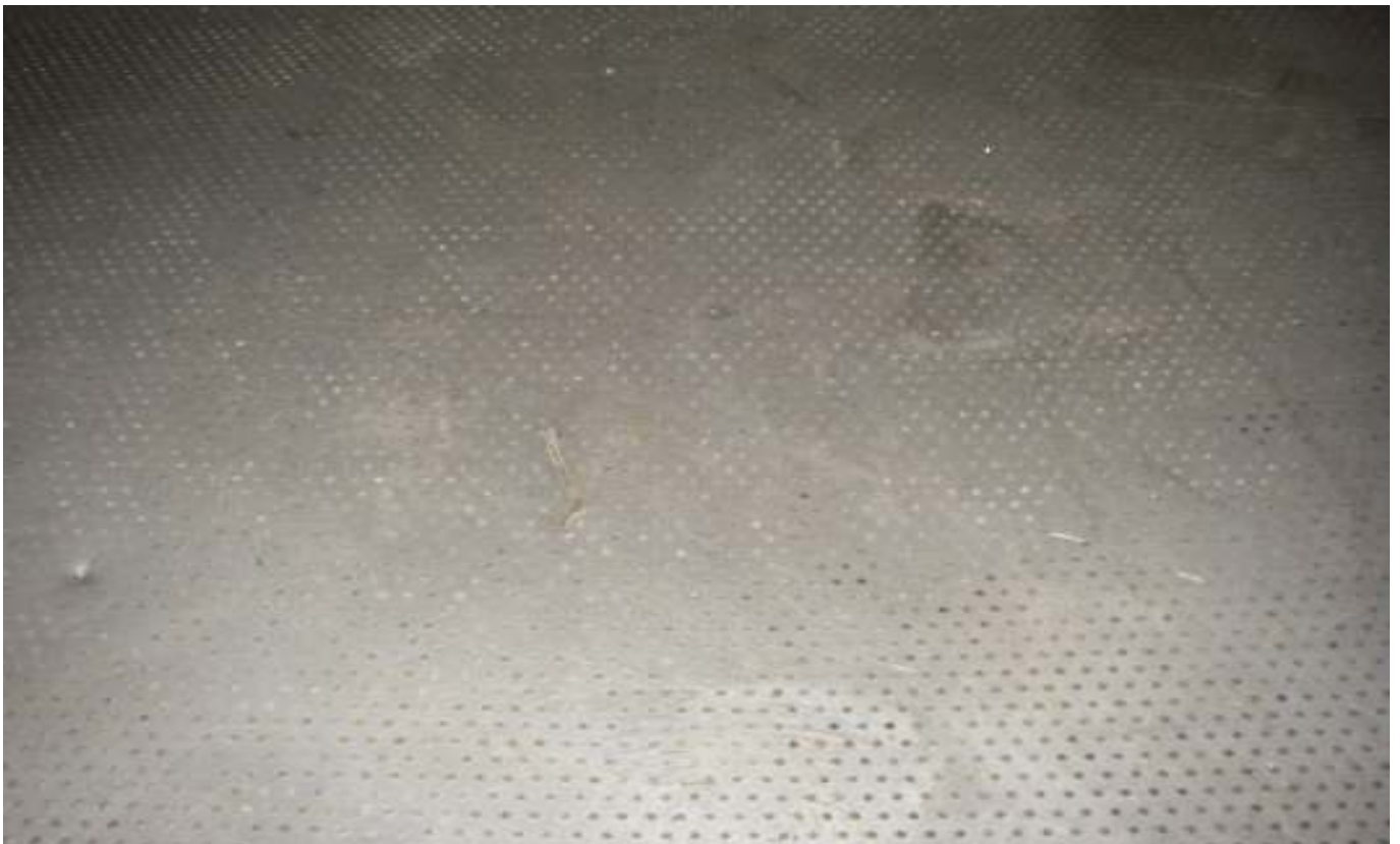
KUVA 6. Tuloilmakoneen kammiot on eristetty mineraalivillalla, joka on päällystetty reikäpellillä.
