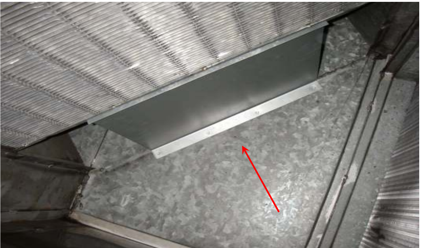
KUVA 10. Tuloilmakoneen ohituskäyttöä on rajoitettu erillisellä pellillä.
