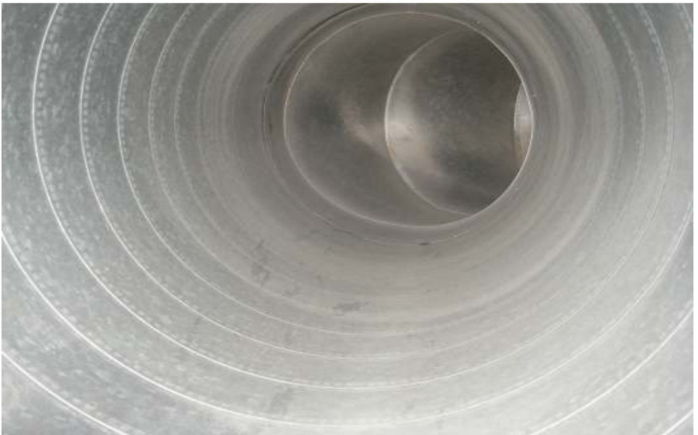
KUVA 12. Yleiskuva IV- konehuoneessa olevasta tuloilmakanavasta.
