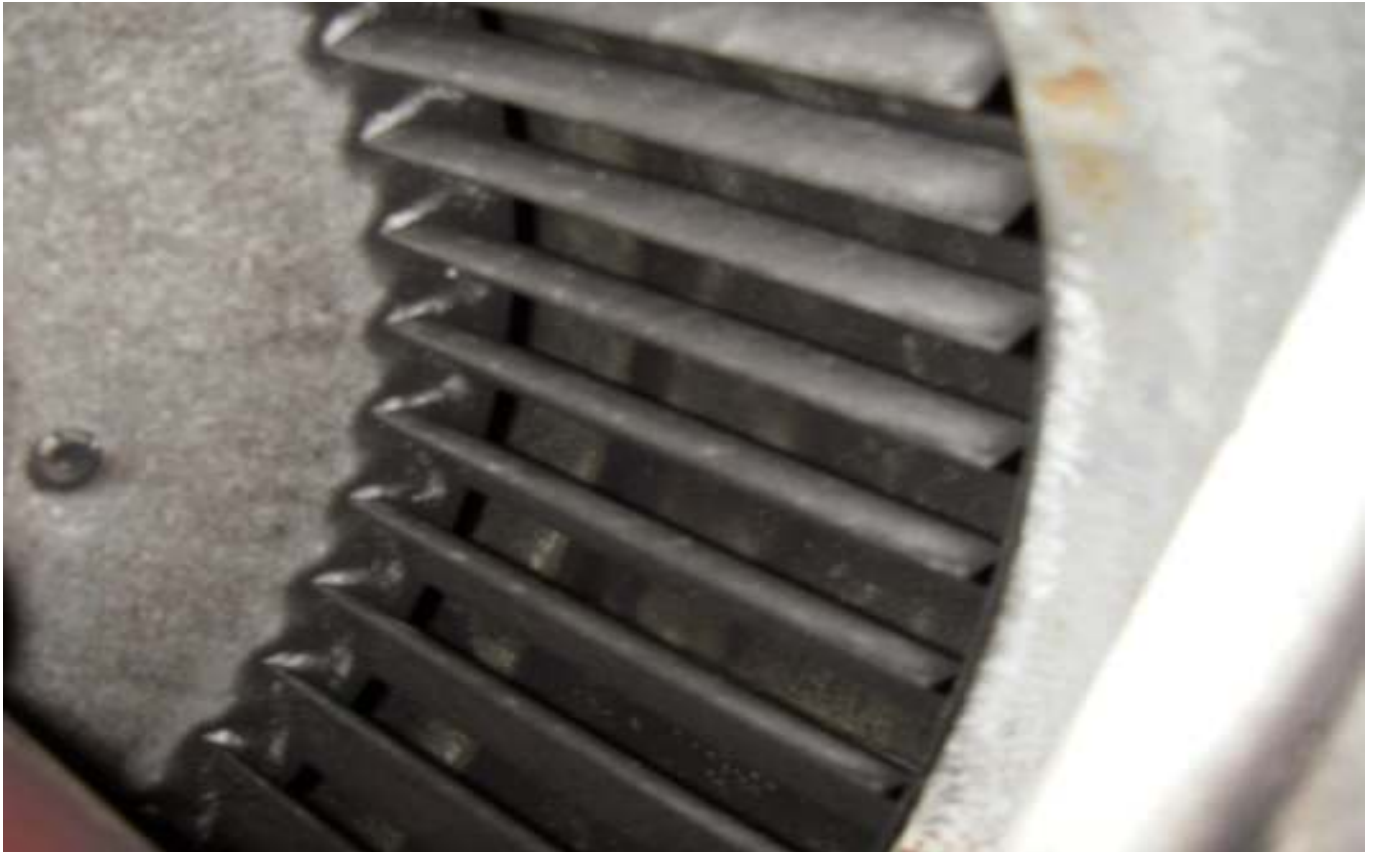
KUVA 5. Tuloilmapuhallin on hieman pölyinen ja nokinen.
