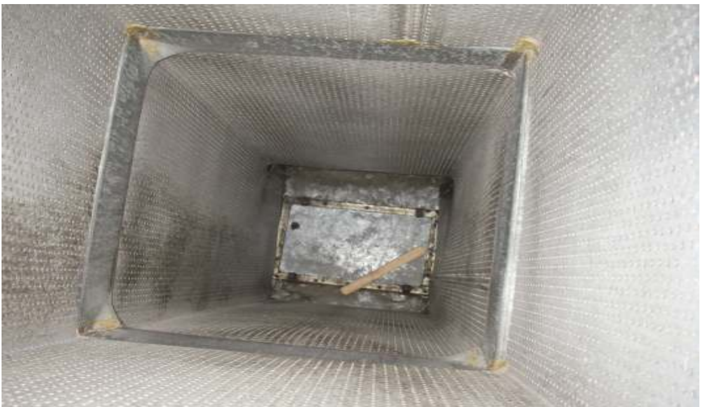
KUVA 14. Yleiskuva keittiön poistoilmakanavasta.
