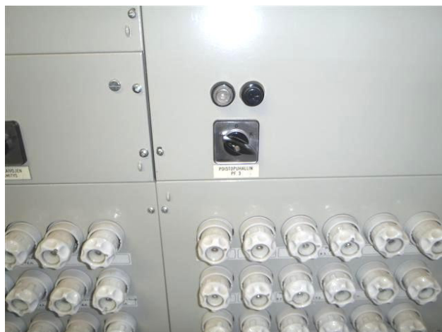
Kuva 2 Kanavapuhaltimen PF3 nokkakytkin.
