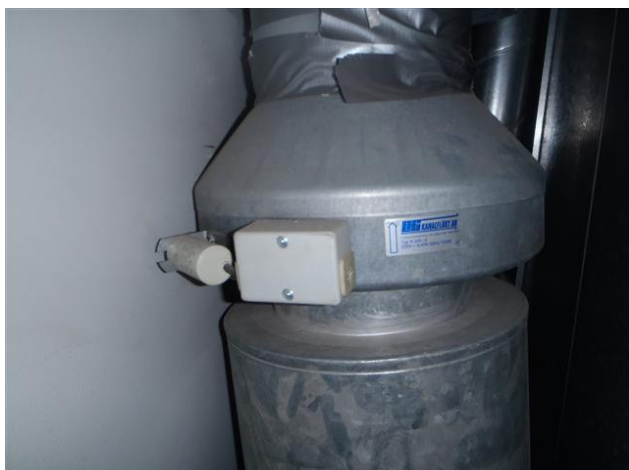
Kuva 1 Alapohjan tuuleduksesta ja teknisen tilan ilmanvaihdosta vastaava kanavapuhallin PF 3.
