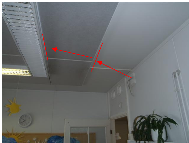
Kuva 6 Kattoa kohti puhallettavan tuloilman esteenä ovat akustiikkalevyt ja valaisimet.
