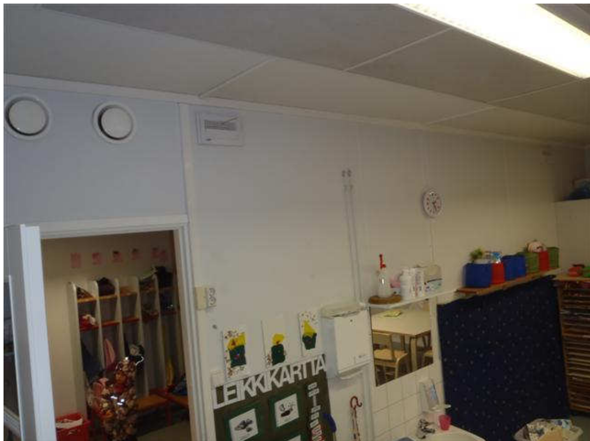
Kuva2. Ilmanvaihdon vierekkäisiä päätte-elimää.
