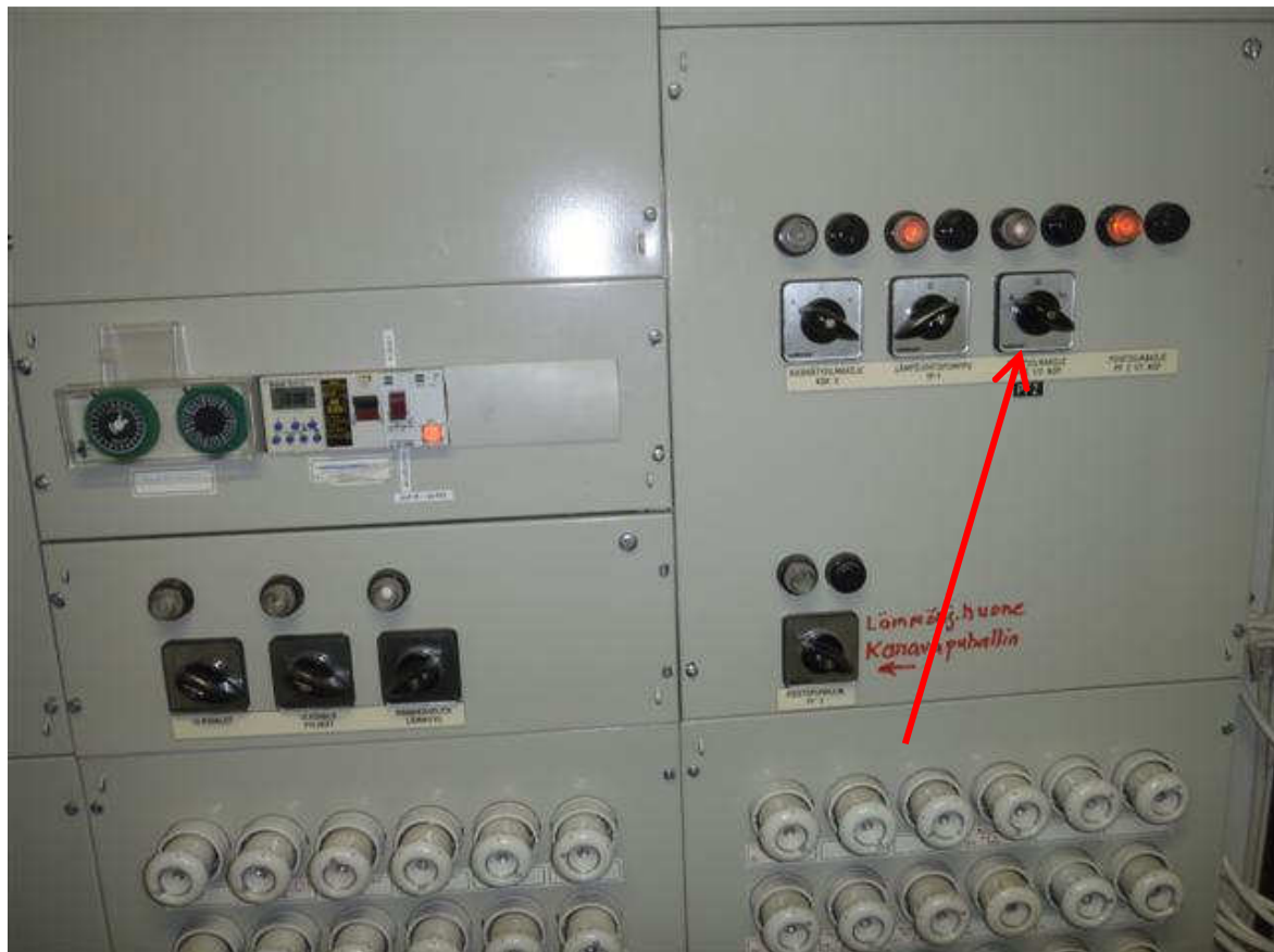
Kuva1. PF2 poistoilmapuhaltimen nokkakytkin.
