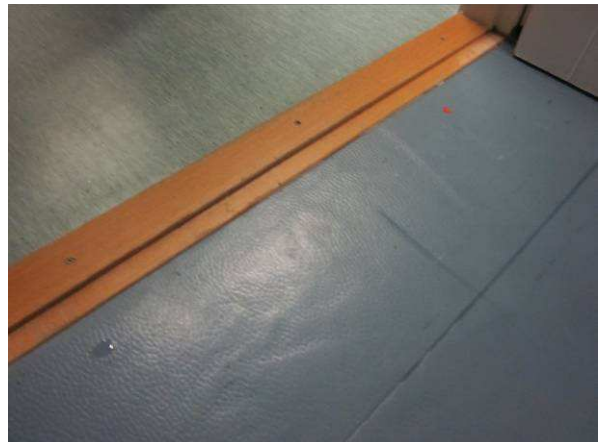
Lattiamatot ovat tyydyttävässä kunnossa
