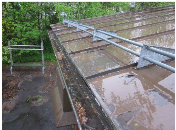
Maalipinnoite hilseilee katteen pinnasta
