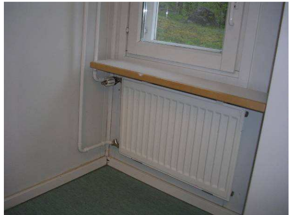
Patteriventtiilit ovat rakennuksen alkuperäisiä.
