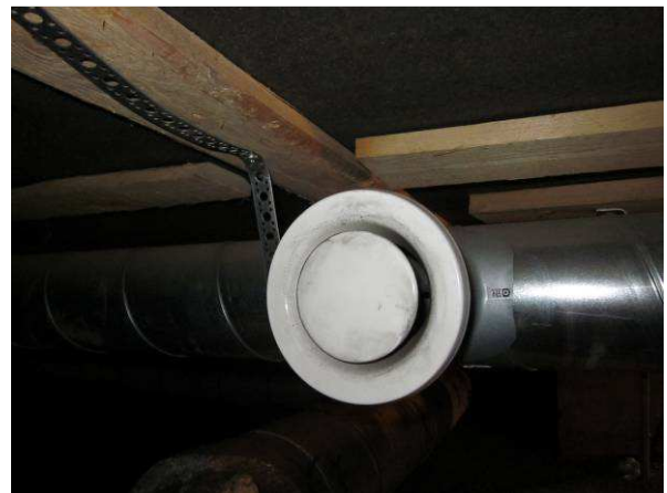
Alapohjatilan ilmanvaihto ei ollut kohdekäynnin aikana toiminnassa
