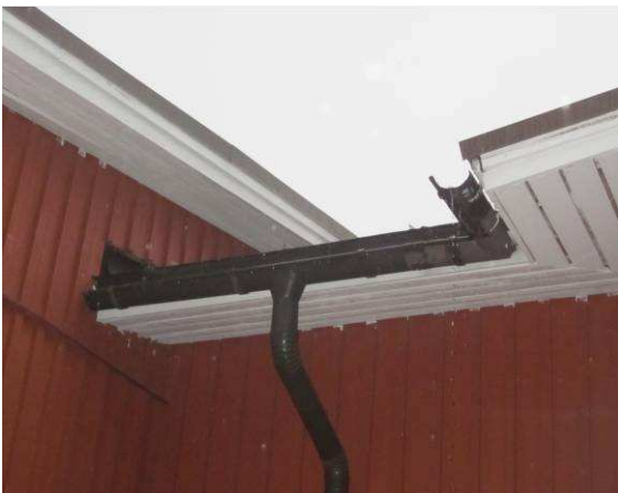
Räystäskourusta puuttuu pääty ja kannakkeet ovat osin pettäneet
