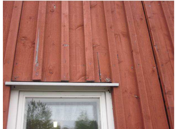
Paikoin julkisivuverhoiluissa rimojen irtoamista ja maalipintojen kulumaa
