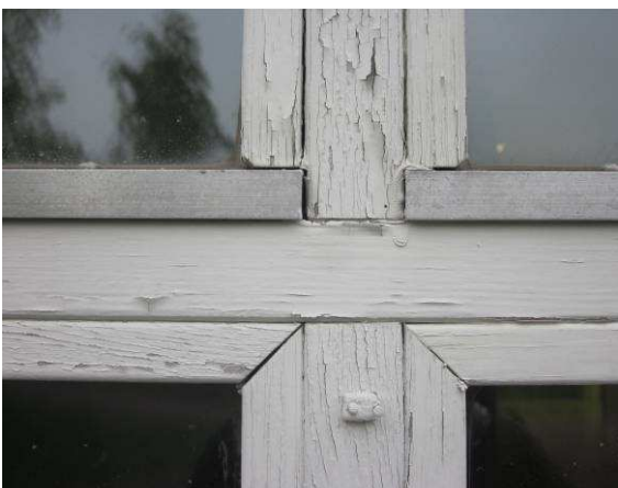
Maalipintojen runsasta hilseilyä
