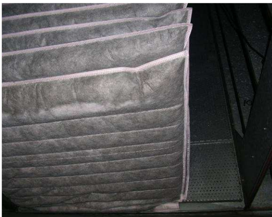
Tuloilmasuodatin oli vielä melko puhdas.
