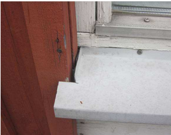
Ikkunapellitykset on toteutettu puutteellisesti
