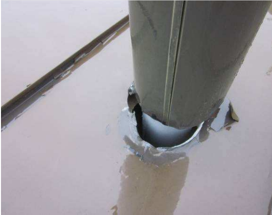
Sadevesi pääsee yläpohjatilaan revenneestä läpivientikohdasta
