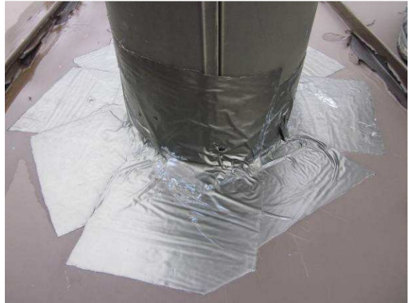
Kohta yläpuolelta, kohtaan tulisi tehdä uusi läpivienti ja läpiviennin yläpuolelle olisi hyvä asentaa lumieste
