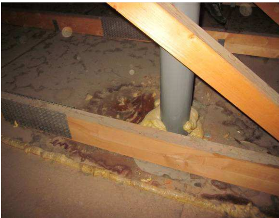
Puutteellinen läpivienti on vuotanut yp. eristeisiin
