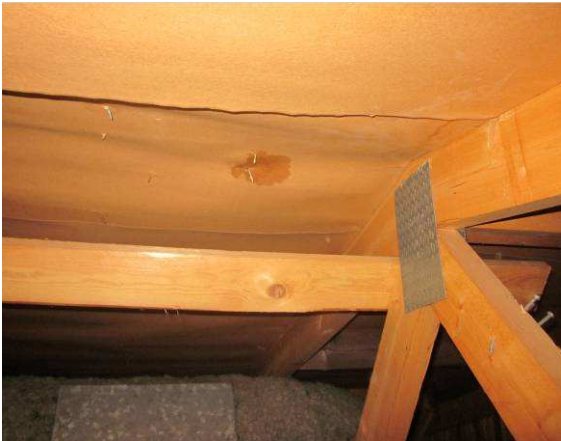
Naulojen kohdilla kosteusjälkiä
