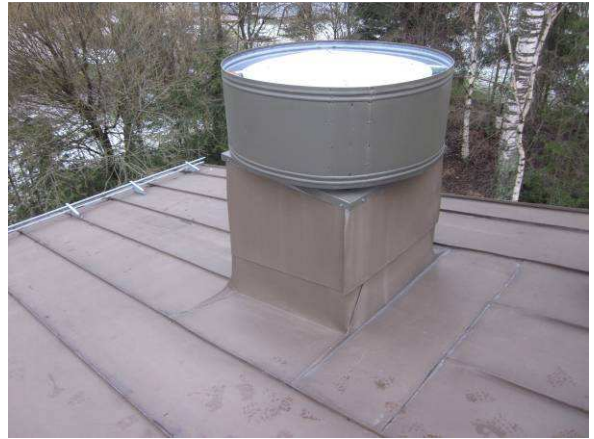
Läpivienni yläpuolelta, reikää ei havaittu, vuoto saumasta?, läpiviennin kohdalla ei ole vastakaatoa
