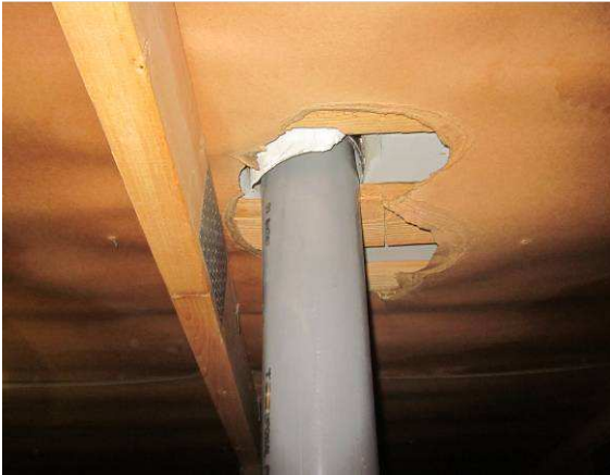
Aluskatteen läpivienti ei ole tiivis
