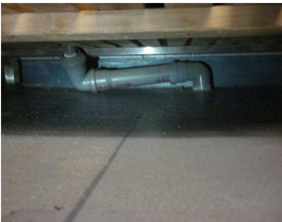
Tuulikaappien kaivojen ympärillä havaittiin kohonneita kosteuksia, puutteellinen viemäröinti
