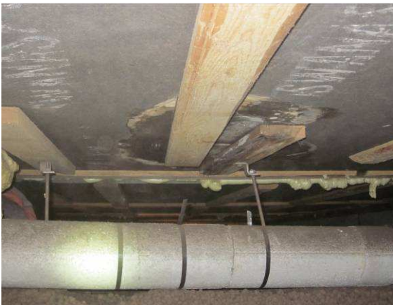
Vanha kosteusjälki, kolmas tuulikaappi länsipäädyssä
