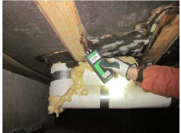
Vanha kosteusjälki, ensimmäinen tuulikaappi eteläpäädyssä
