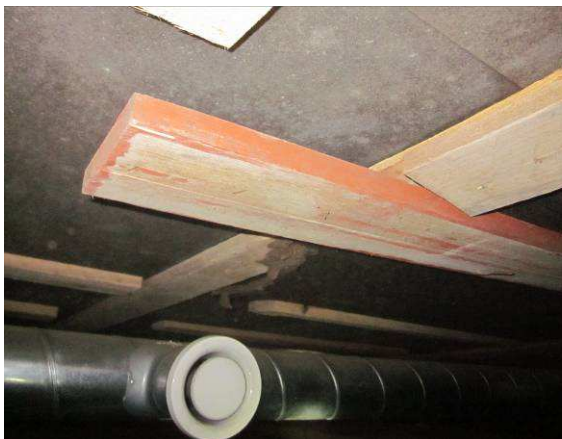
Kohteen alapohjatilaan on rakennettu poistoilmakanavisto
