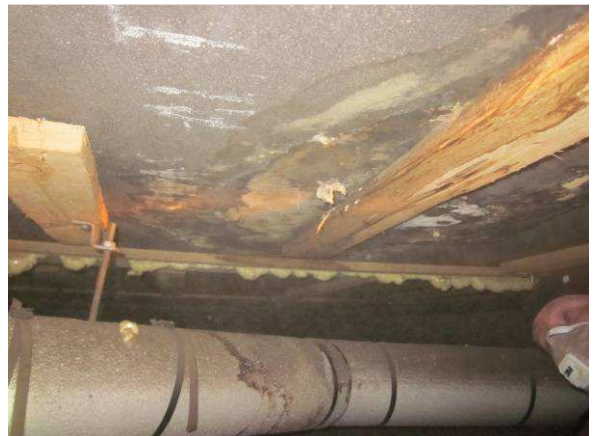
Vanha kosteusjälki, toinen tuulikaappi länsipäädyssä
