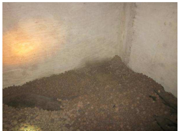
Rakennuksen luoteisnurkassa kevytsorakerros on ohut ja sen alla hiekka oli aistivaraaisesti kosteaa
