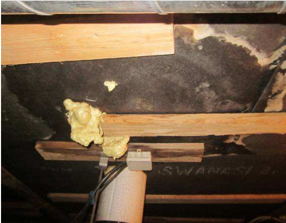
Vanha kosteusjälki noin keittiön tiskauskohdan alapuolella
