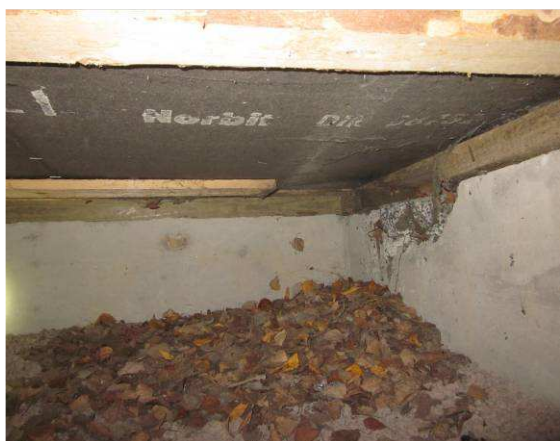
Eteläpäässä sokkelissa on reikä, josta on päässyt lehtiä alapohjatilään
